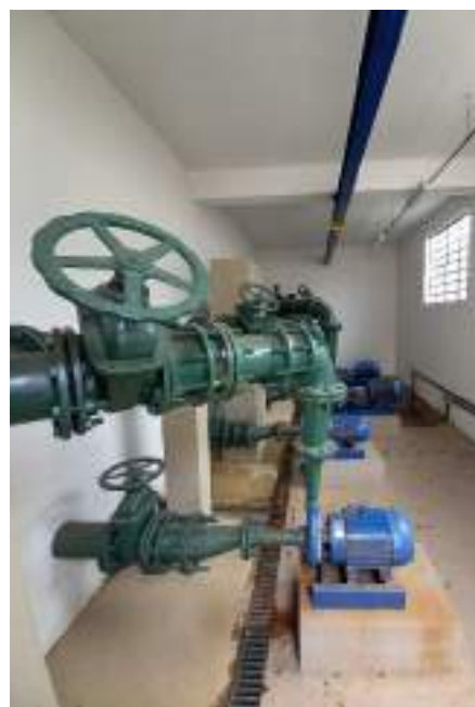
Figura 69 – EEAT 02 e 03 da sede municipal.
