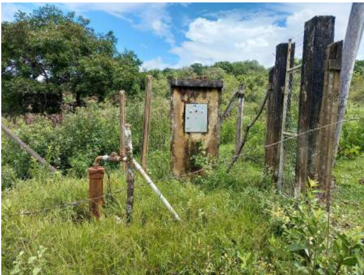
Figura 136 – Captação subterrânea na comunidade Boa Vista. Fonte: Profill Engenharia e Ambiente, 2020.
