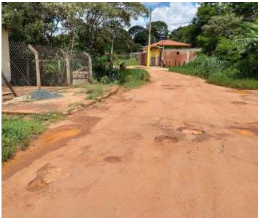
Figura 288 – Asfalto deteriorado em Senador Mourão.
