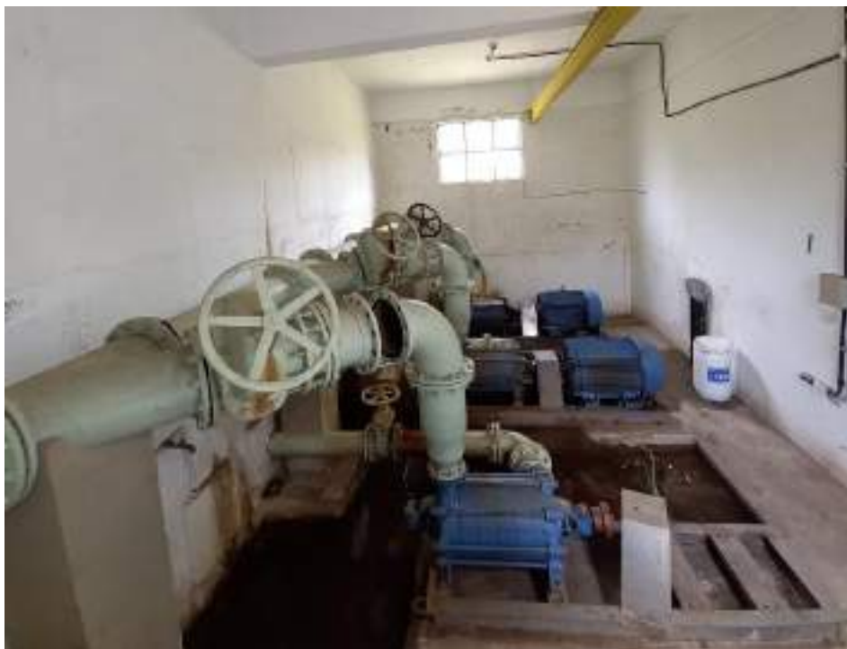
Figura 55 – EEAB 02 – Rio Pardo. Fonte: Profill Engenharia e Ambiente, 2020.
