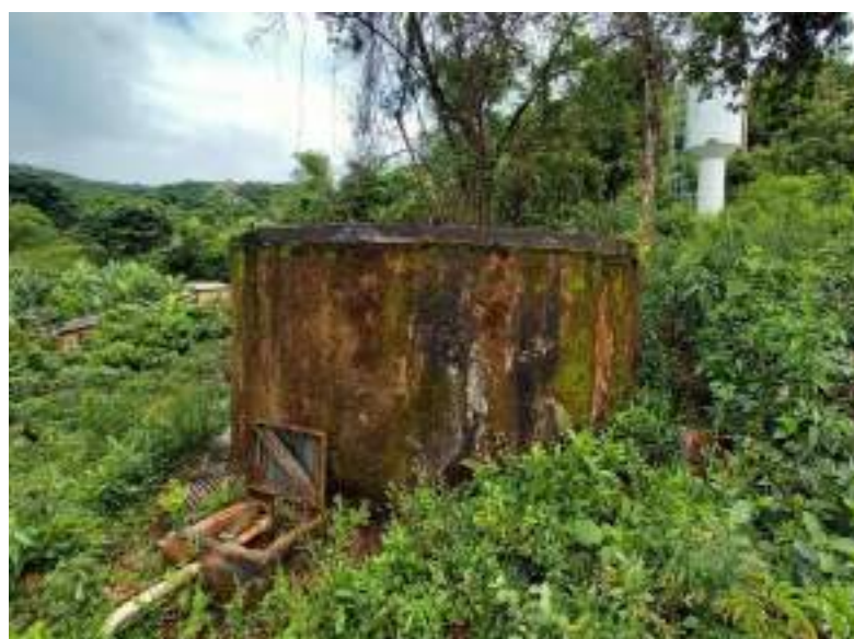
Figura 135 - Reservatórios na comunidade Pinheiro.
