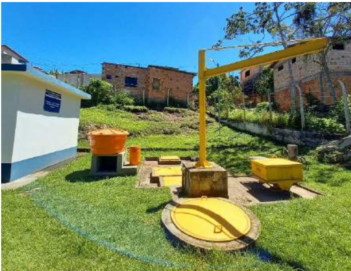
Figura 158 - EEE Cidade Nova. Fonte: Profill Engenharia e Ambiente, 2020.
