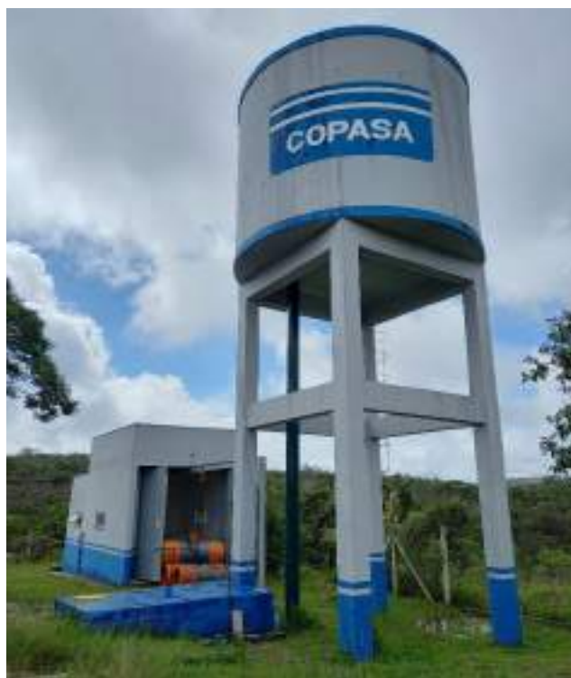
Figura 59 – Reservatório de água para operação da ETA e armazenamento do cloro gasoso.
