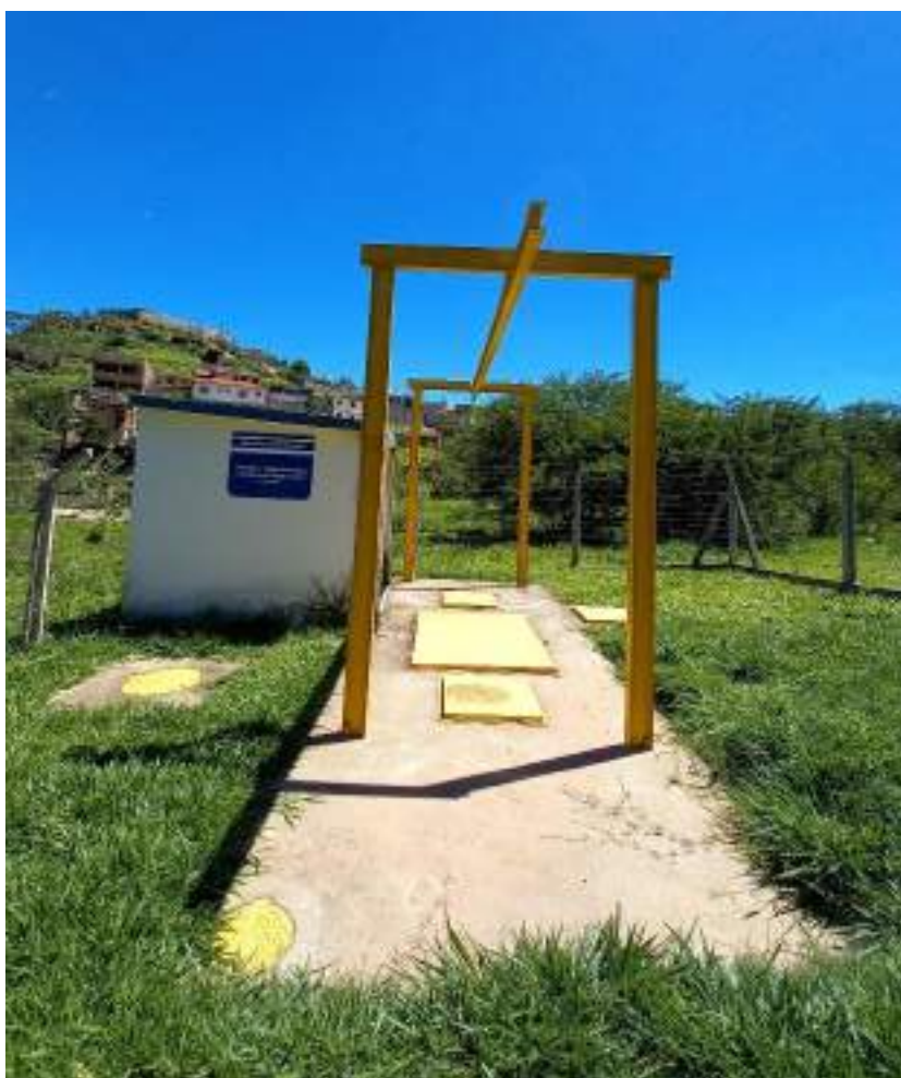
Figura 157 – EEE Jardim Imperial. Fonte: Profill Engenharia e Ambiente, 2020.
