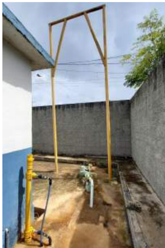
Figura 73 – Poço E02 – Cidade Nova da sede municipal. Fonte: Profill Engenharia e Ambiente, 2020.
