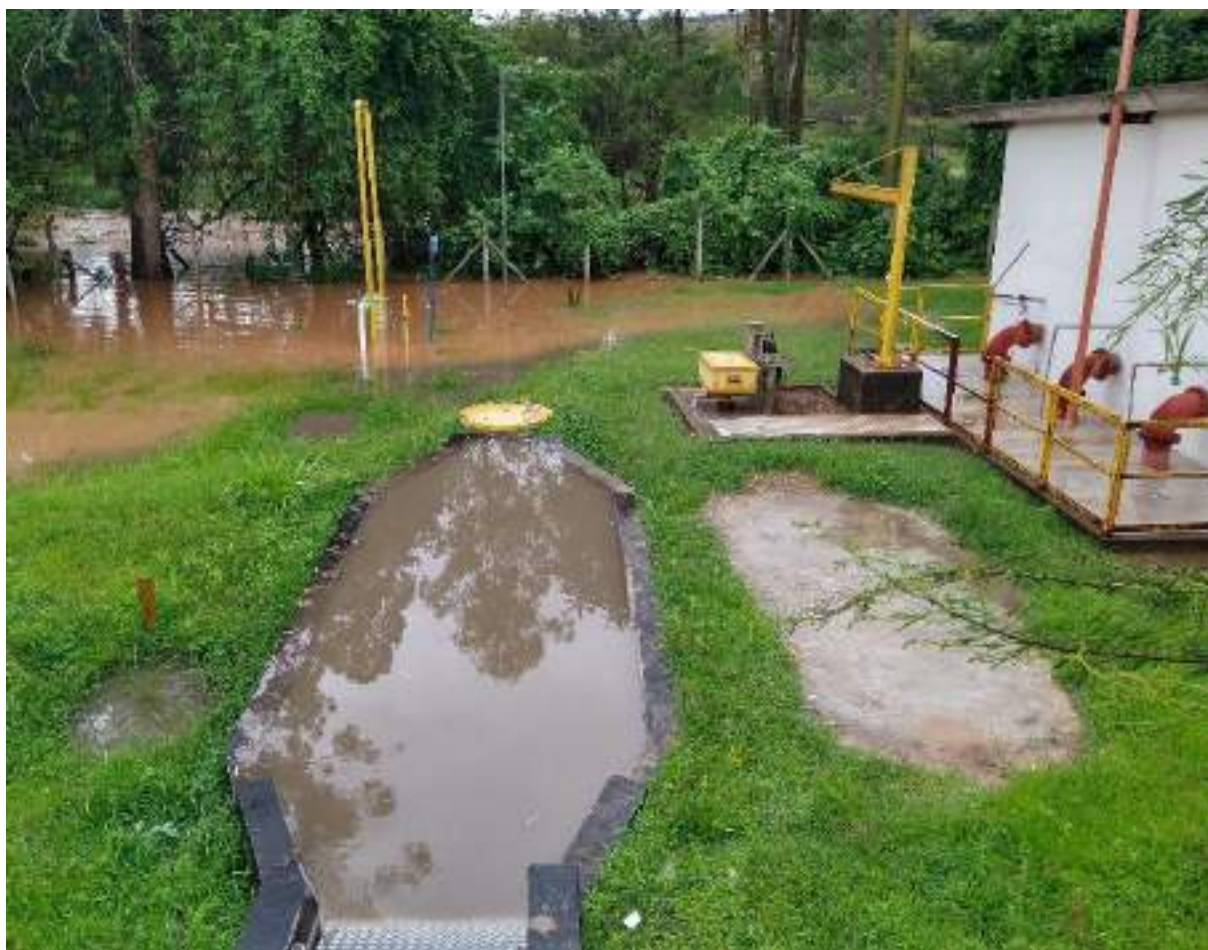
Figura 162 – Área da EEE Final inundada. Fonte: Profill Engenharia e Ambiente, 2020.
