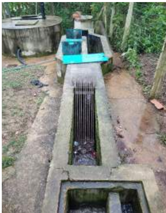
Figura 182 – EEE de São João da Chapada. Fonte: Profill Engenharia e Ambiente, 2020.
