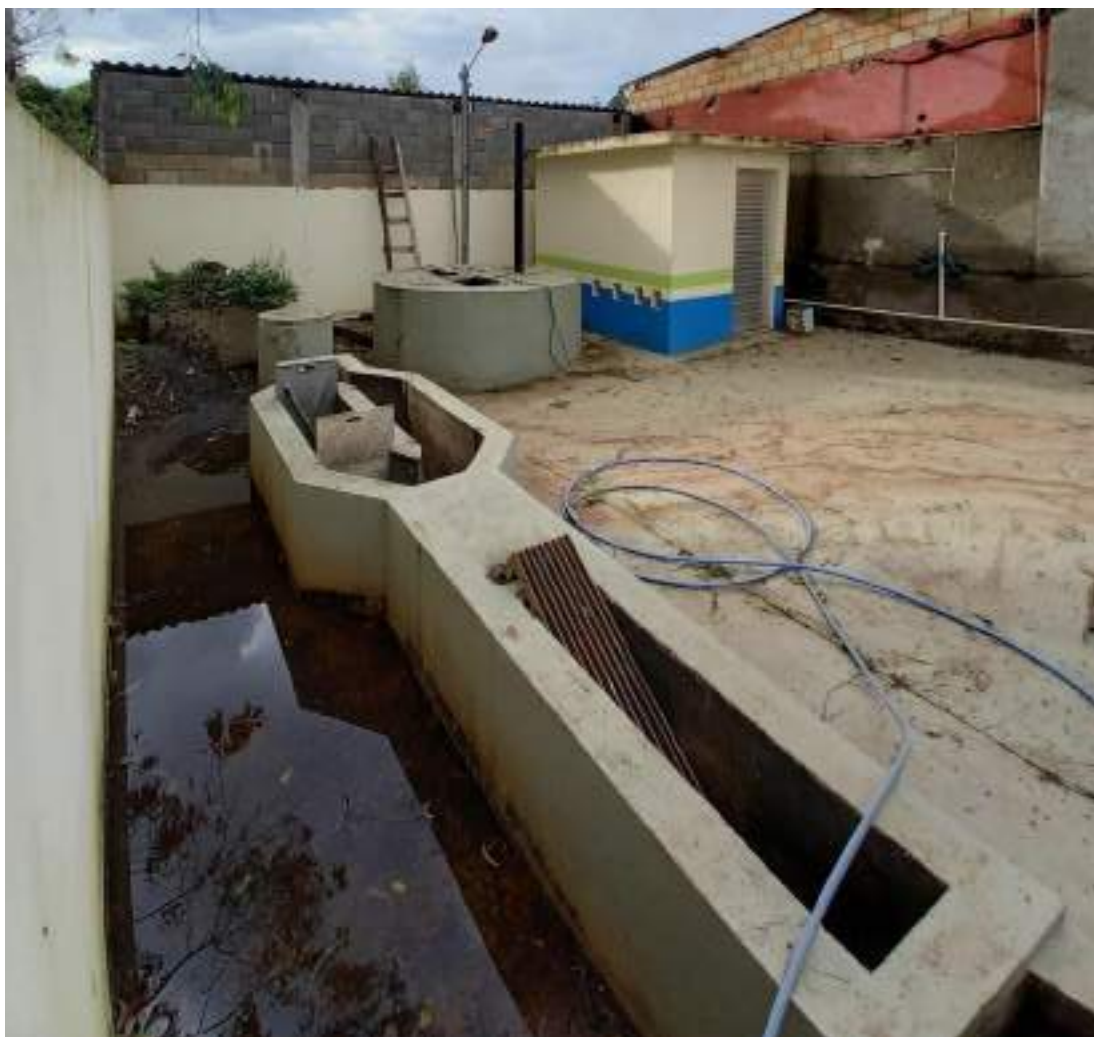
Figura 177 – ETE de Guinda. Fonte: Profill Engenharia e Ambiente, 2020.
