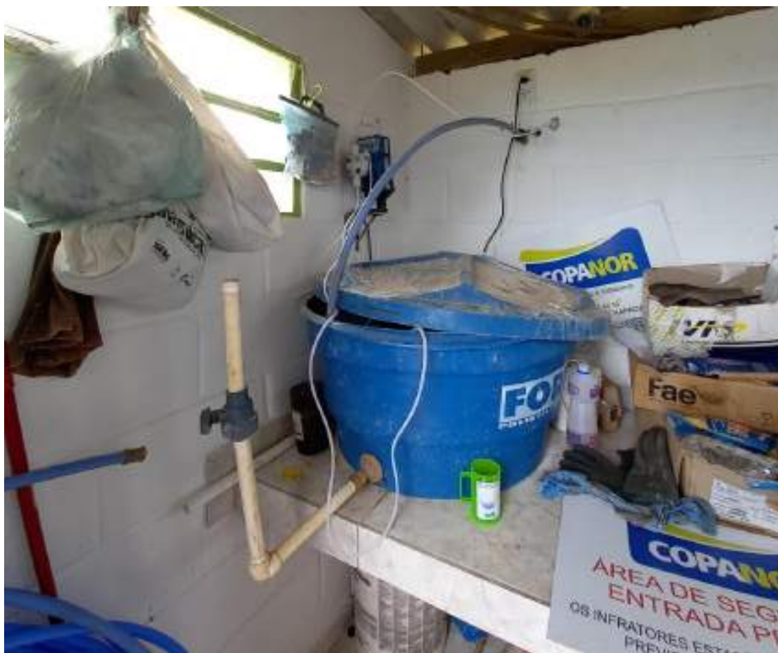
Figura 93 – Tratamento simplificado em São João da Chapada. Fonte: Profill Engenharia e Ambiente, 2020.
