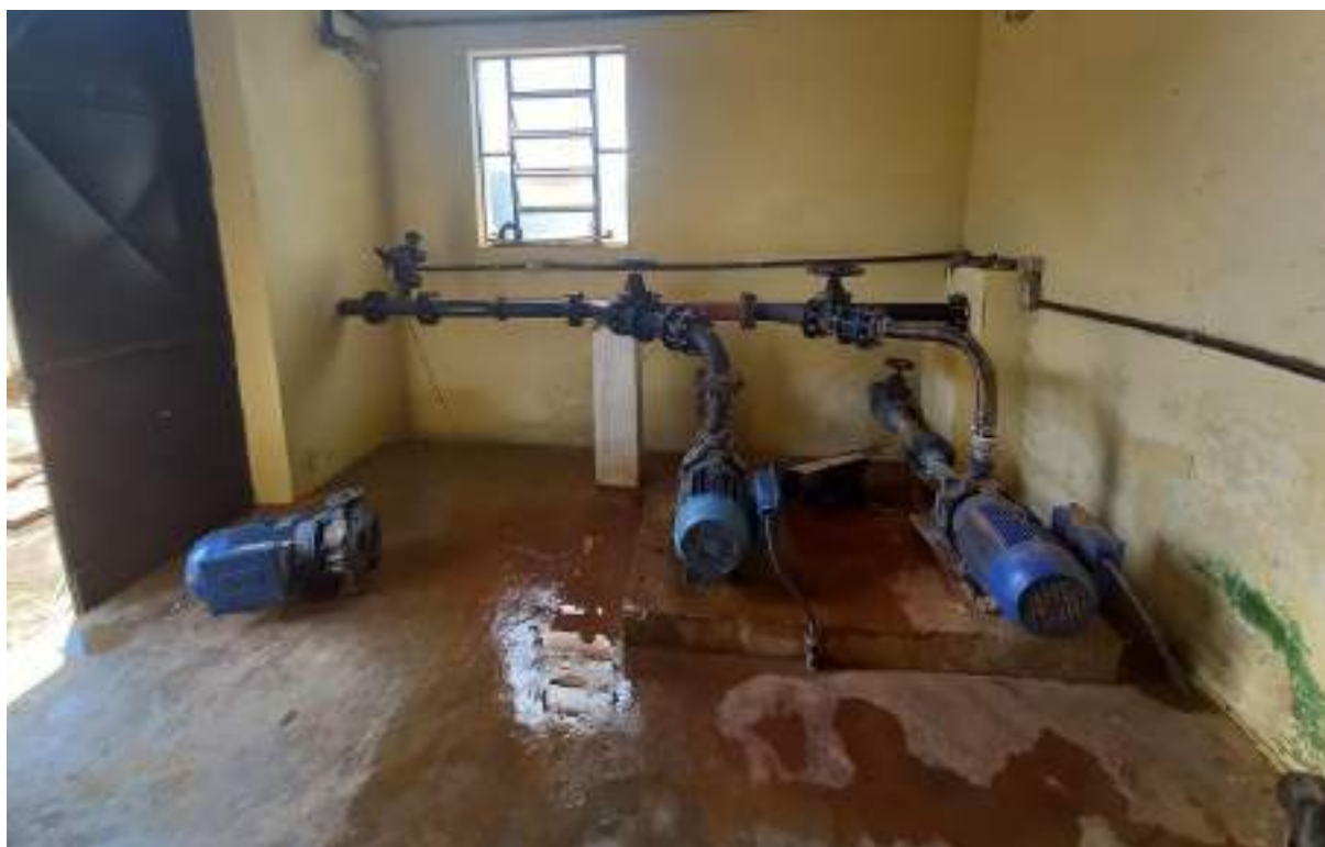
Figura 126 – Estação elevatória de Desembargador Otoni. Fonte: Profill Engenharia e Ambiente, 2020.
