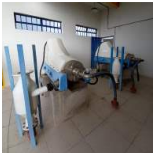
Figura 168 – Desidratação do lodo da ETE da sede municipal.
