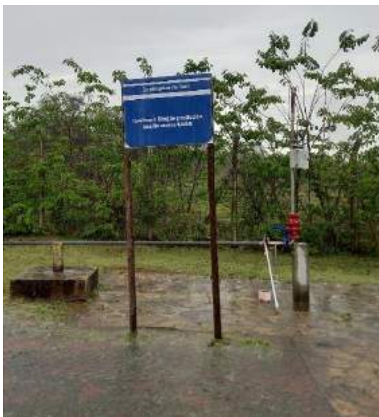
Figura 166 – Queimador de gás da ETE da sede municipal. Fonte: Profill Engenharia e Ambiente, 2020.
