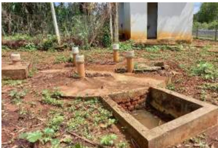
Figura 210 – Filtro da ETE de Planalto de Minas. Fonte: Profill Engenharia e Ambiente, 2020.
