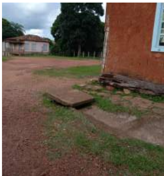
Figura 266 – Microdrenagem no distrito de Extração.
