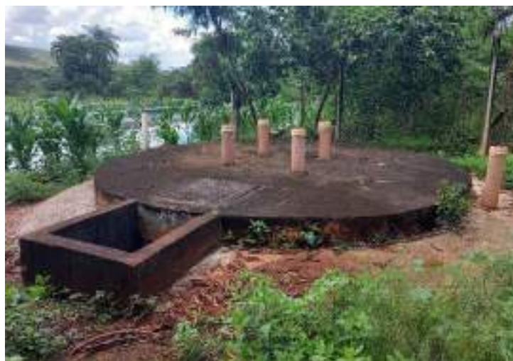
Figura 204 – Filtro da ETE de Desembargador Otoni. Fonte: Profill Engenharia e Ambiente, 2020.
