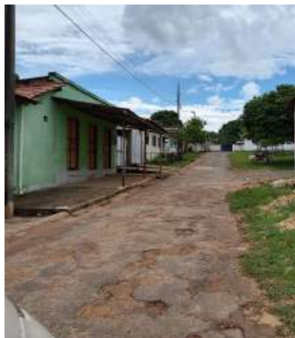
Figura 287 – Asfalto deteriorado em Inhaí. Fonte: Profill Engenharia e Ambiente, 2020.
