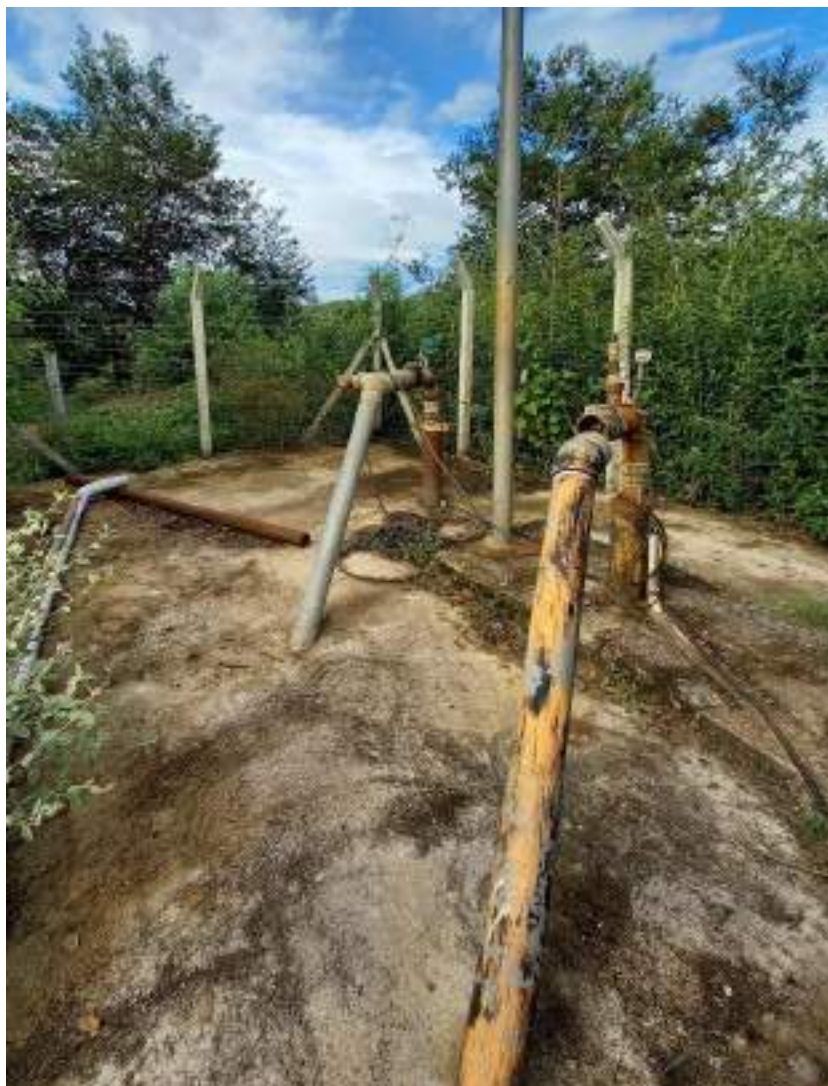
Figura 103 – Poço C01 de Mendanha. Fonte: Profill Engenharia e Ambiente, 2020.
