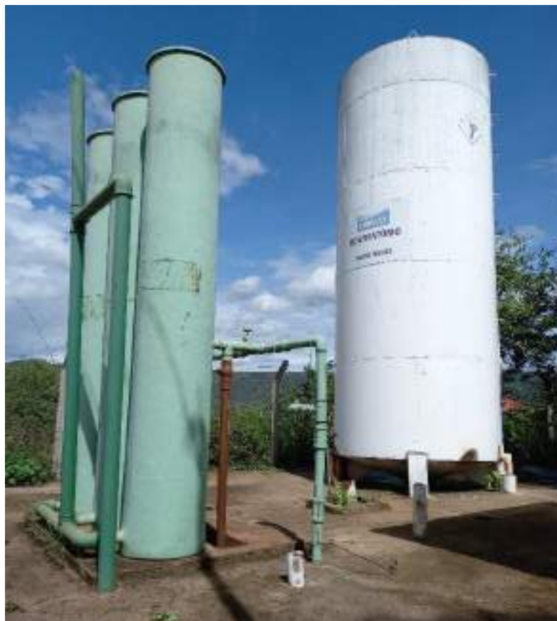
Figura 108 – Filtro e reservatório de Maria Nunes. Fonte: Profill Engenharia e Ambiente, 2020.
