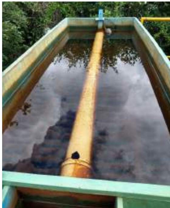
Figura 98 – Decantador da ETA de Extração.
