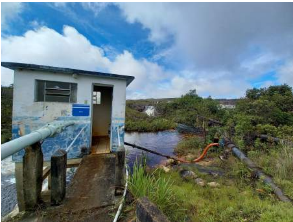
Figura 52 – Captação superficial Ribeirão das Pedras. Fonte: Profill Engenharia e Ambiente, 2020.
