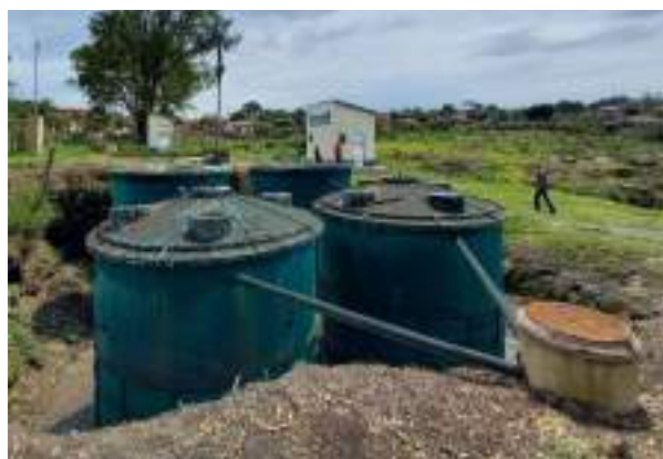
Figura 184 – Reatores e filtros da ETE de São João da Chapada. Fonte: Profill Engenharia e Ambiente, 2020.
