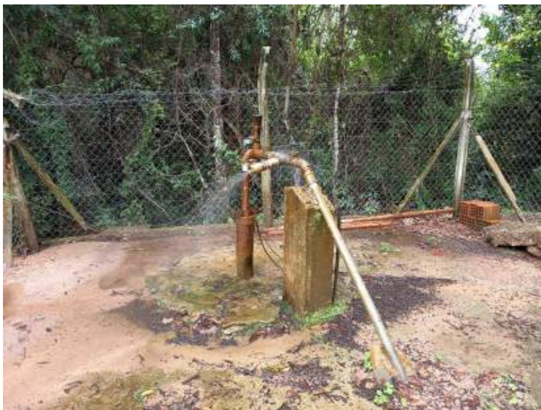
Figura 110 – Poço C01 de Inhaí. Fonte: Profill Engenharia e Ambiente, 2020.
