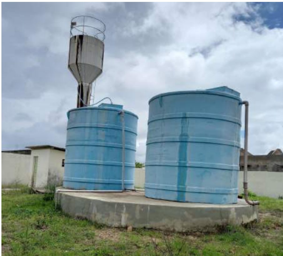
Figura 86 – Reservatórios RAP 01 e RAP 02 em Sopa.
