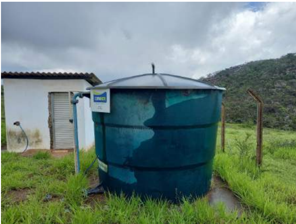
Figura 89 – Reservatório RAP 01 em Morrinhos.
