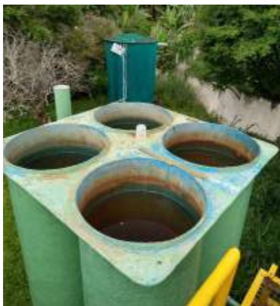
Figura 99 – Filtros e tanque de contato (ao fundo) da ETA de Extração.
