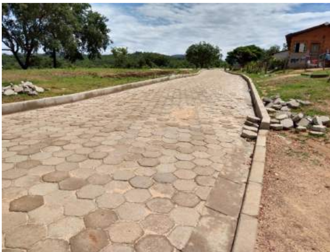
Figura 30 – Obra de implantação de bloquete no distrito de Inhaí. Fonte: Profill Engenharia e Ambiente, 2020.
