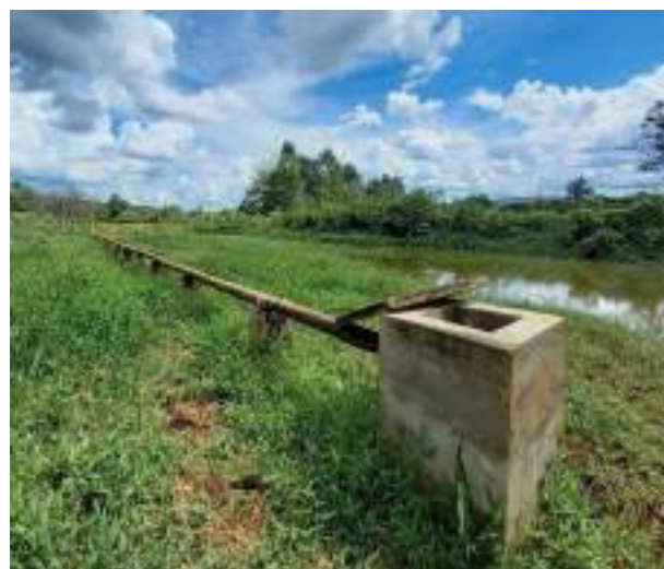
Figura 212 – Sistema de gotejamento da ETE de Planalto de Minas. Fonte: Profill Engenharia e Ambiente, 2020.
