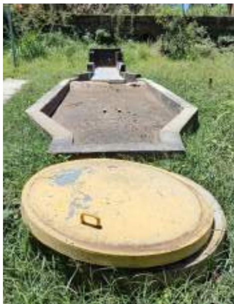
Figura 160 – Tratamento preliminar na EEE Final. Fonte: Profill Engenharia e Ambiente, 2020.
