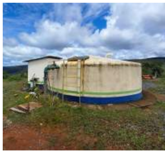
Figura 119 – Tanque de contato da ETA de Senador Mourão.
