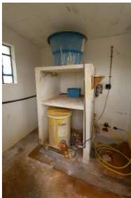
Figura 112 – Tratamento simplificado de Inhaí. Fonte: Profill Engenharia e Ambiente, 2020.
