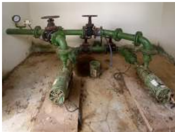
Figura 121 – Booster da Rua do Progresso de Senador Mourão. Fonte: Profill Engenharia e Ambiente, 2020.
