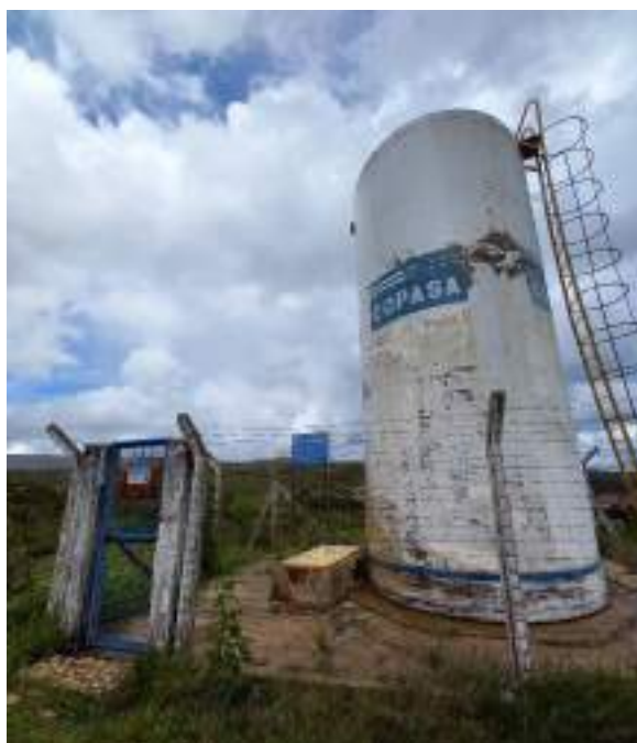
Figura 70 – Reservatório R10 – Cidade Nova da sede municipal. Fonte: Profill Engenharia e Ambiente, 2020.
