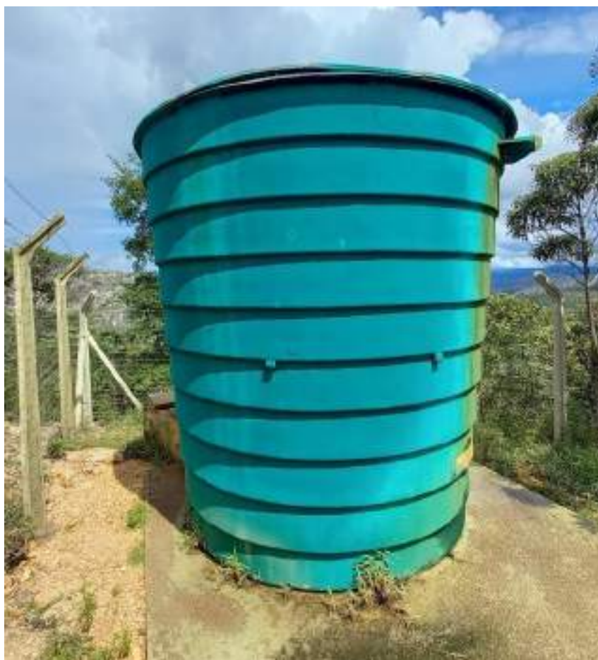
Figura 101 – Reservatório de Extração.
