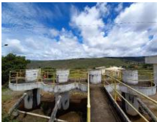
Figura 118 – Filtros da ETA de Senador Mourão.
