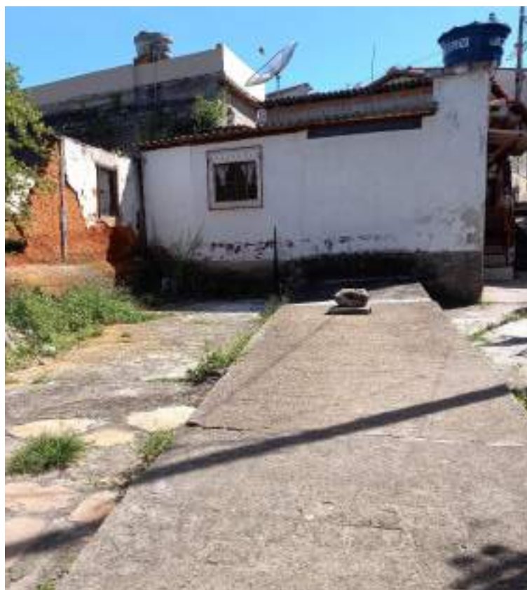
Figura 285 – Casa construída em cima de galeria de água pluvial. Fonte: Profill Engenharia e Ambiente, 2020.
