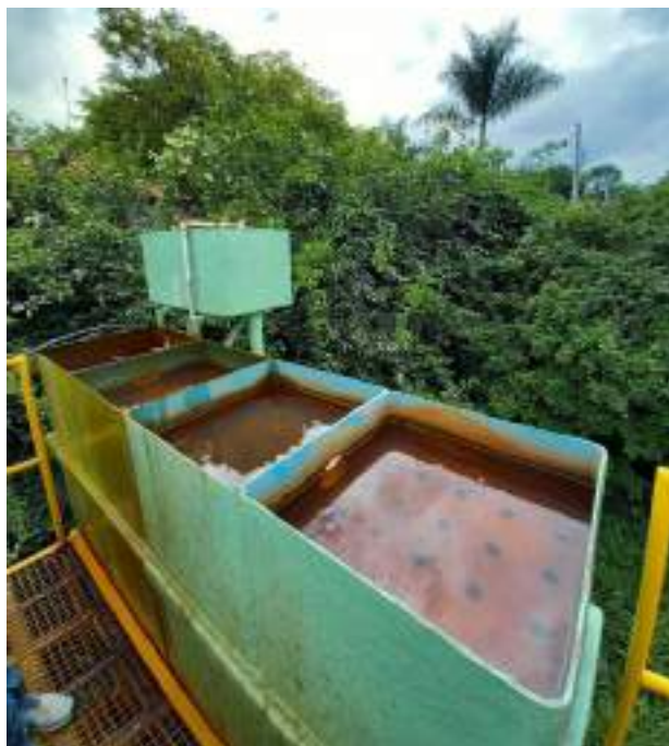
Figura 97 – Floculador da ETA de Extração.
