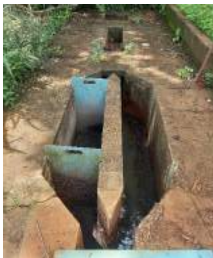
Figura 209 – Tratamento preliminar da ETE de Planalto de Minas. Fonte: Profill Engenharia e Ambiente, 2020.
