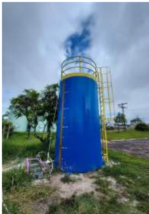
Figura 60 – Reservatório de armazenamento da cal em suspensão.
