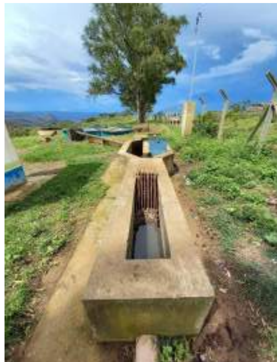
Figura 183 – Tratamento preliminar da ETE de São João da Chapada. Fonte: Profill Engenharia e Ambiente, 2020.
