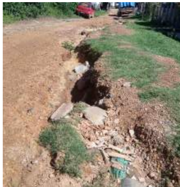
Figura 283 – Problema de erosão no distrito de Conselheiro Mata. Fonte: Profill Engenharia e Ambiente, 2020.
