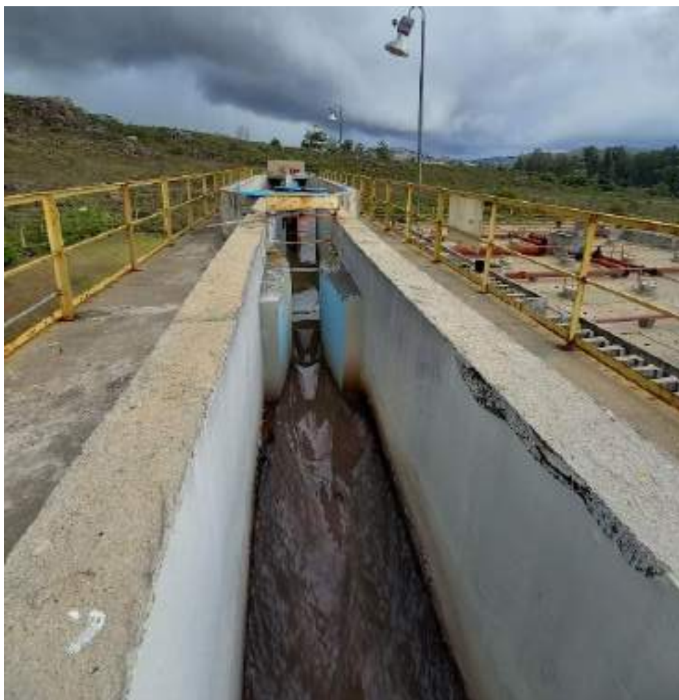
Figura 164 – Tratamento preliminar da ETE da sede municipal.
