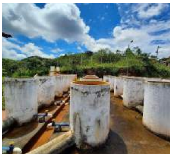
Figura 116 – Floculadores da ETA de Senador Mourão.
