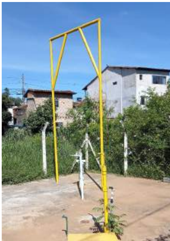
Figura 72 – Poço E01 da sede municipal. Fonte: Profill Engenharia e Ambiente, 2020.
