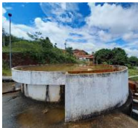
Figura 117 – Decantador da ETA de Senador Mourão.
