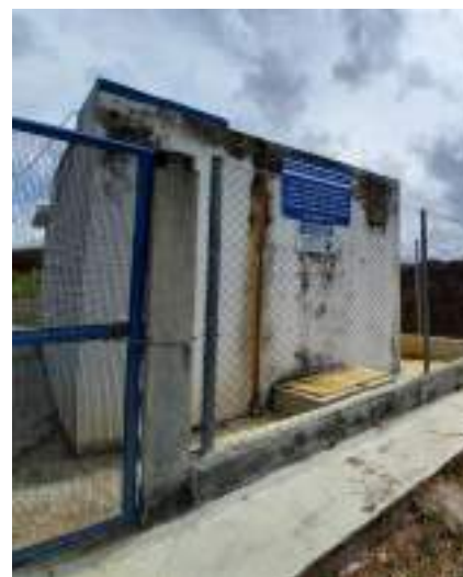
Figura 65 – Reservatório R06 – Jardim da Serra da sede municipal.
