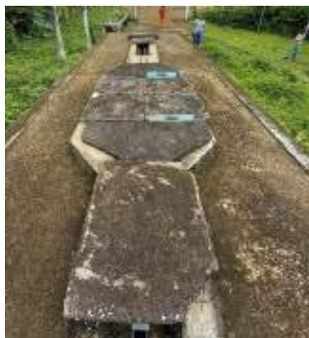
Figura 193 – Tratamento preliminar da ETE de Inhaí. Fonte: Profill Engenharia e Ambiente, 2020.
