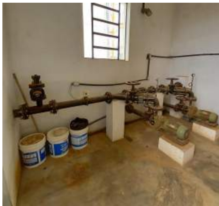
Figura 113 – Estação elevatória de água tratada de Inhaí. Fonte: Profill Engenharia e Ambiente, 2020.
