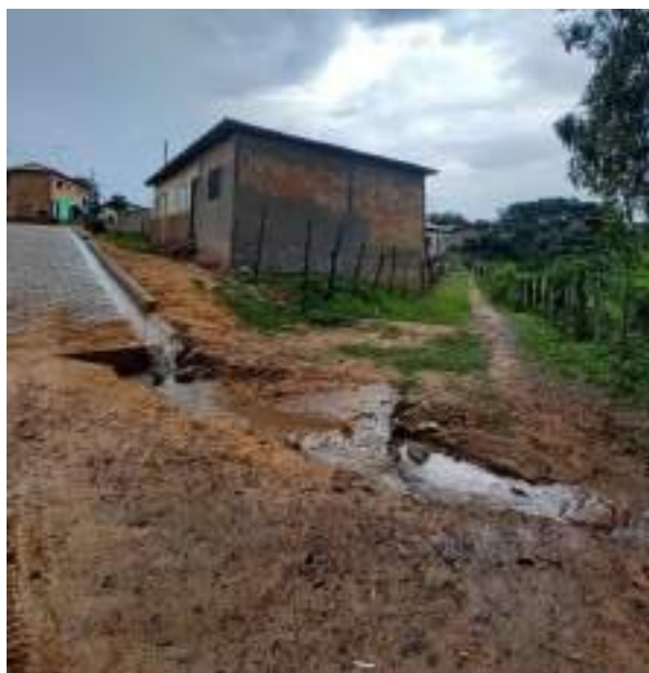
Figura 282 - Problema de erosão no distrito de São João da Chapada. Fonte: Profill Engenharia e Ambiente, 2020.
