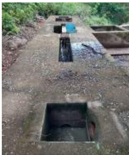
Figura 197 – Tratamento preliminar da ETE de Senador Mourão. Fonte: Profill Engenharia e Ambiente, 2020.
