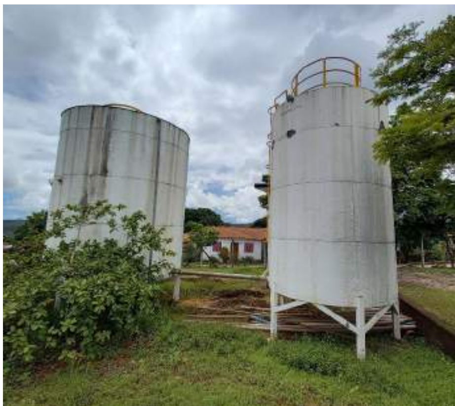
Figura 111 – Reservatórios RAP01 e RAP 02 de Inhaí. Fonte: Profill Engenharia e Ambiente, 2020.
