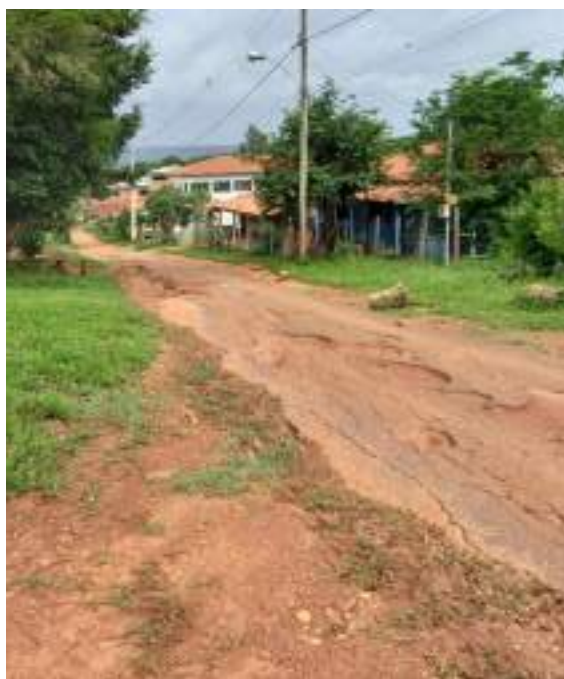
Figura 286 – Asfalto deteriorado em Desembargador Otoni. Fonte: Profill Engenharia e Ambiente, 2020.
