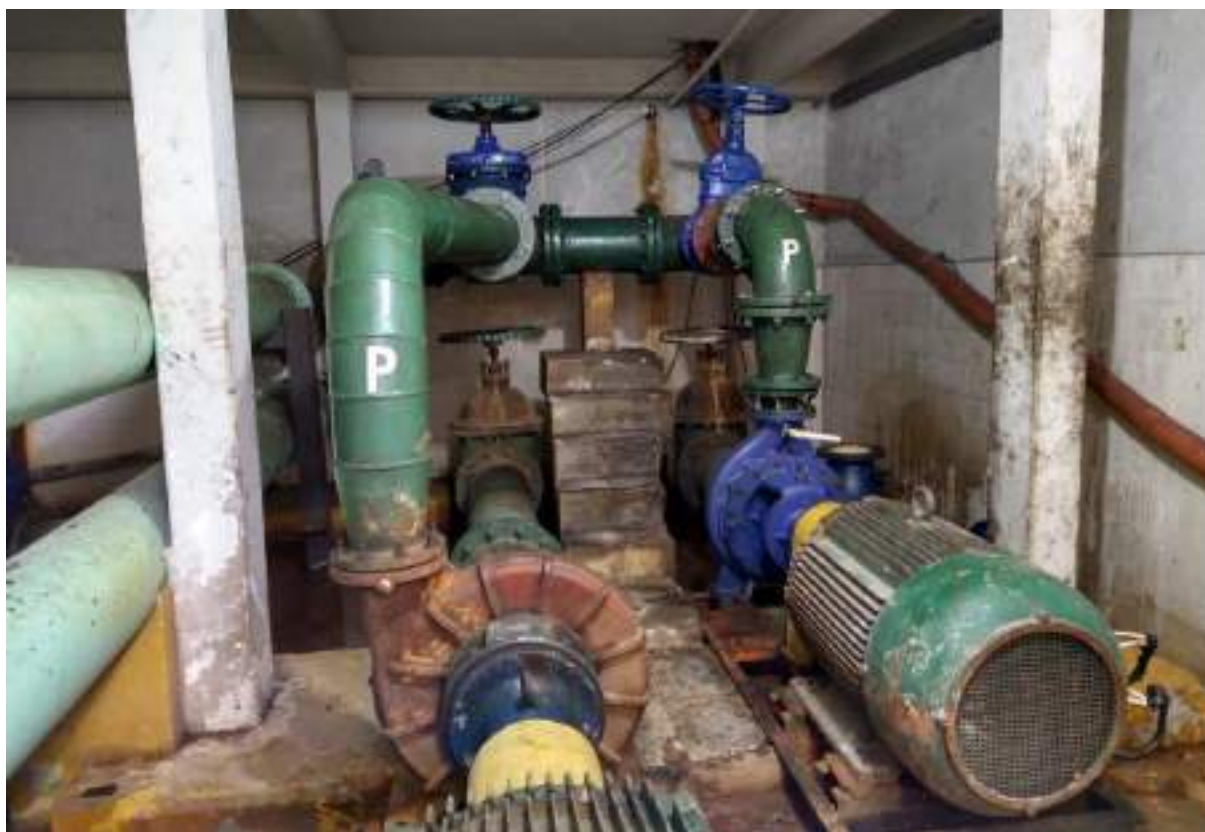
Figura 61 – EEAT 01 da sede municipal.
