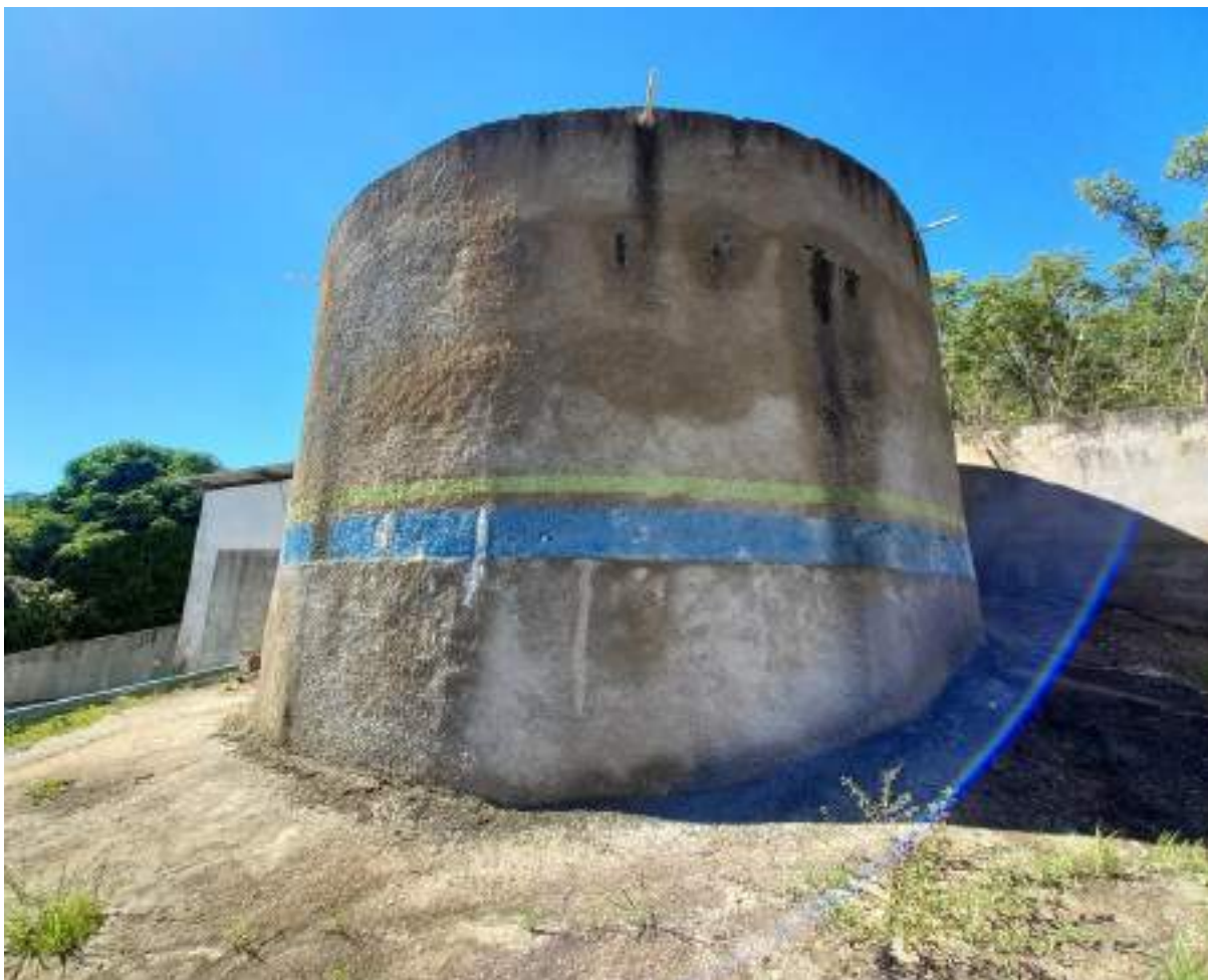
Figura 79 – Reservatório RAP 01 em Conselheiro Mata. Fonte: Profill Engenharia e Ambiente, 2020.
