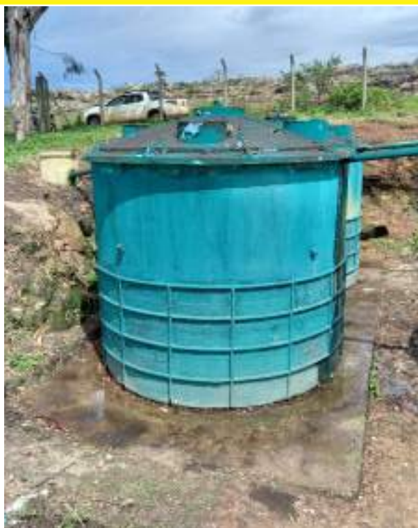
Figura 215 – Vazamento no filtro da ETE de São João da Chapada.
