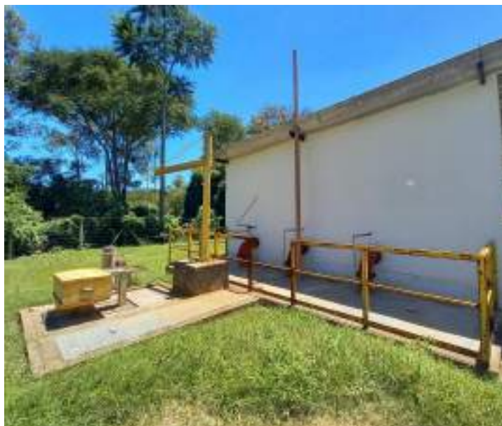
Figura 161 – Caixa de areia e bombas da EEE Final. Fonte: Profill Engenharia e Ambiente, 2020.
