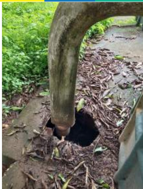
Figura 216 – Estrutura deteriorada na ETE de Inhaí.
