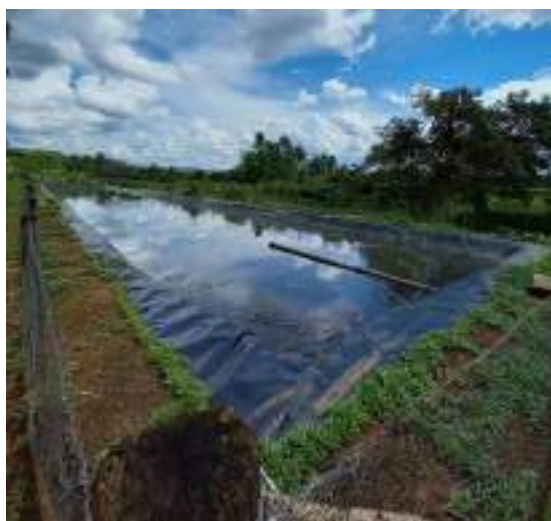
Figura 211 – Lagoa de maturação da ETE de Planalto de Minas. Fonte: Profill Engenharia e Ambiente, 2020.
