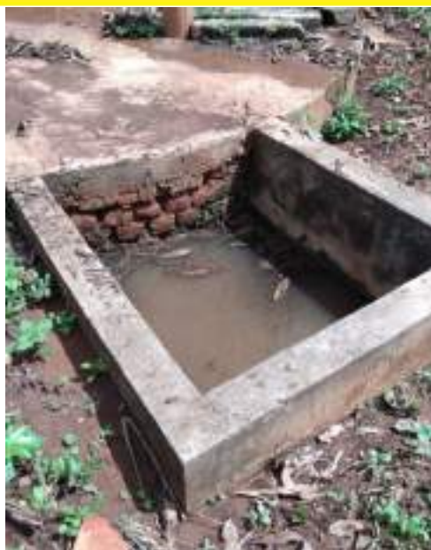
Figura 217 – Filtro entupido na ETE de Planalto de Minas.
