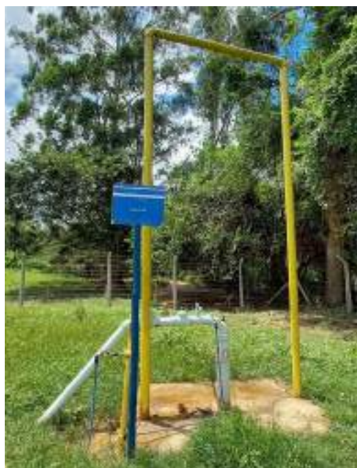
Figura 74 – Poço C05 da sede municipal. Fonte: Profill Engenharia e Ambiente, 2020.
