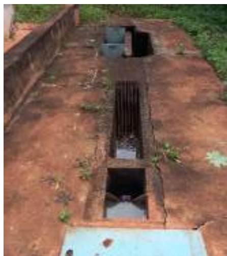
Figura 203 – Tratamento preliminar da ETE de Desembargador Otoni. Fonte: Profill Engenharia e Ambiente, 2020.
