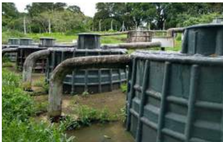
Figura 194 – Filtros e reatores (ao fundo) da ETE de Inhaí. Fonte: Profill Engenharia e Ambiente, 2020.
