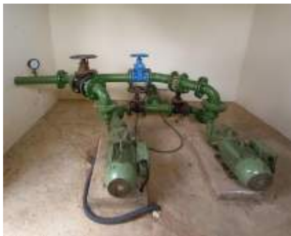
Figura 120 – Booster da Rua Diamantina de Senador Mourão. Fonte: Profill Engenharia e Ambiente, 2020.
