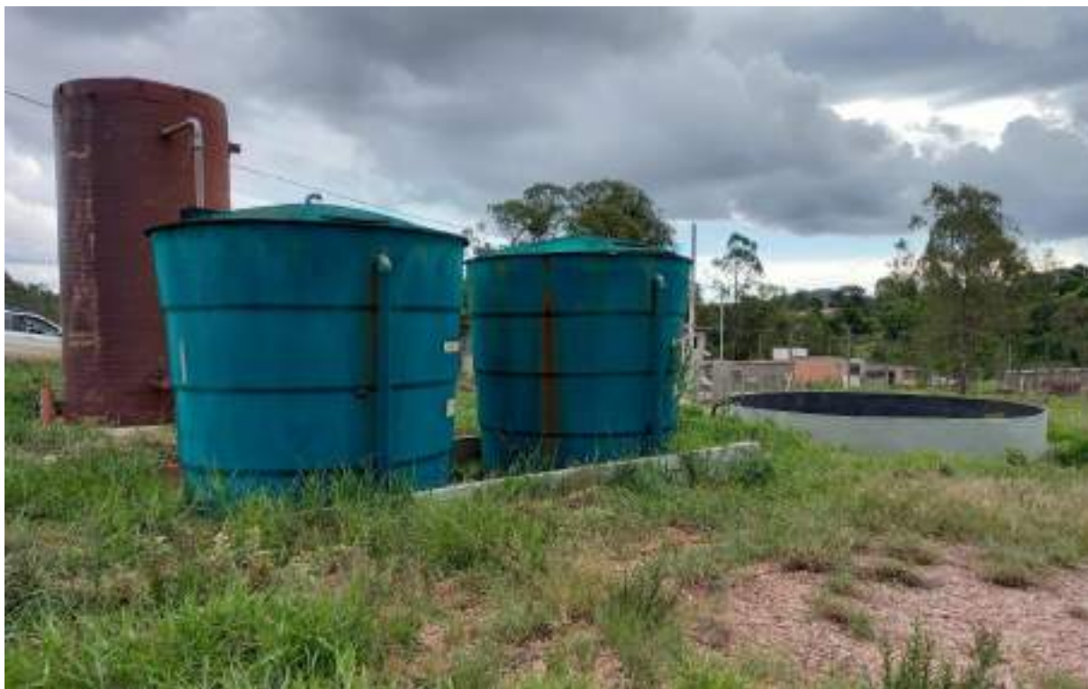
Figura 178 – ETE de Guinda. Fonte: Profill Engenharia e Ambiente, 2020.
