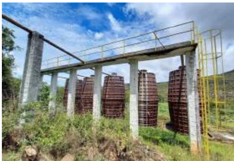
Figura 198 – Reatores UASB da ETE de Senador Mourão. Fonte: Profill Engenharia e Ambiente, 2020.
