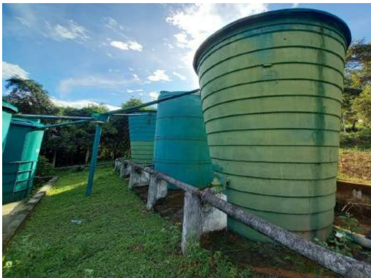
Figura 119 - ETE de Mendanha. Fonte: Profill Engenharia e Ambiente, 2020.
