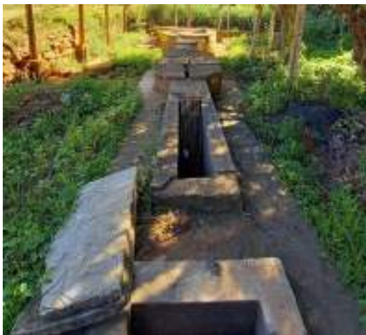
Figura 100 - EEE de Conselheiro Mata. Fonte: Profill Engenharia e Ambiente, 2020.
