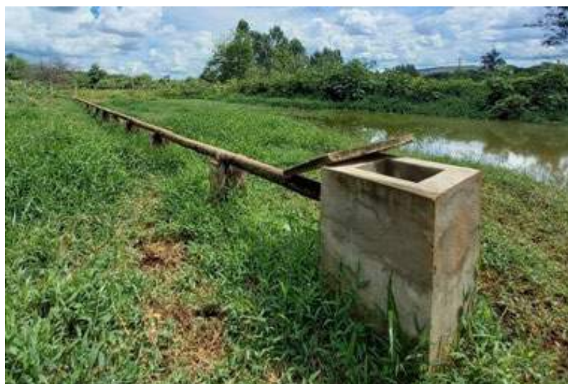
Figura 141 - Sistema de gotejamento da ETE de Planalto de Minas.
