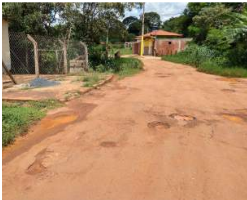
Figura 177 - Asfalto deteriorado em Senador Mourão.
