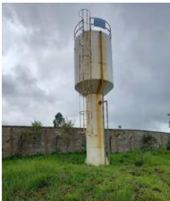
Figura 41 - Reservatório R11 - Vista da Serra.
