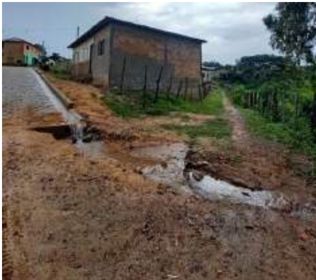
Figura 172 - Erosão em São João da Chapada.
