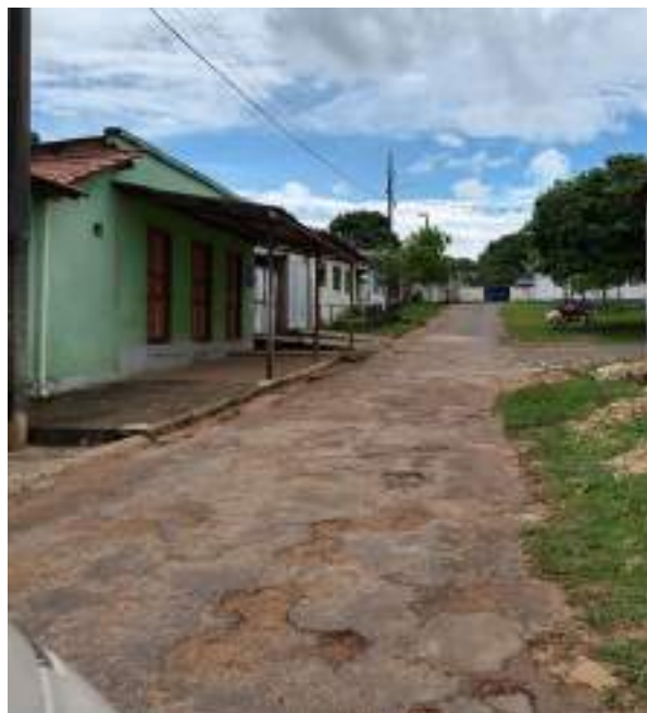
Figura 176 - Asfalto deteriorado em Inhaí.
