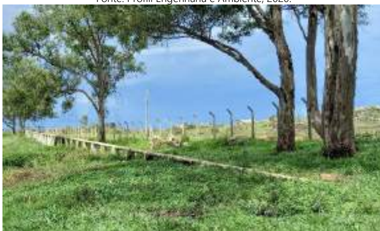
Figura 114 - Gotejamento da ETE de São João da Chapada. Fonte: Profill Engenharia e Ambiente, 2020.
