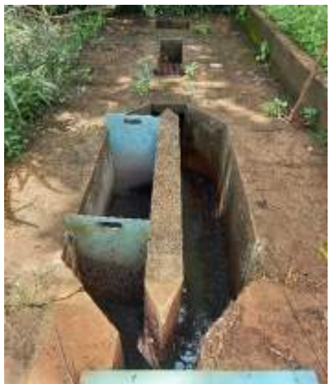
Figura 138 - Tratamento preliminar da ETE de Planalto de Minas.
