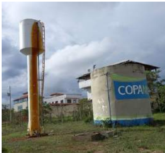
Figura 49 - Reservatórios RAP 01 e REL 02 em Guinda.
