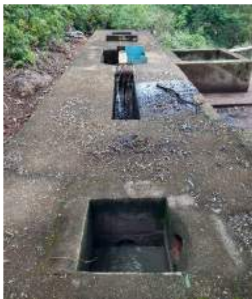
Figura 126 - Tratamento preliminar da ETE de Senador Mourão.
