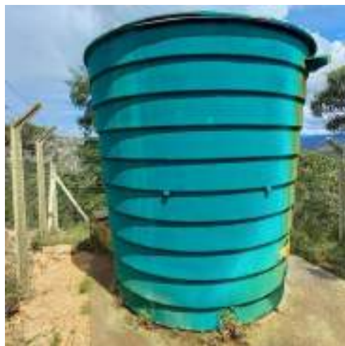
Figura 62 - Reservatório de Extração.
