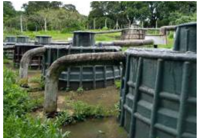
Figura 123 - Filtros e reatores da ETE de Inhaí.
