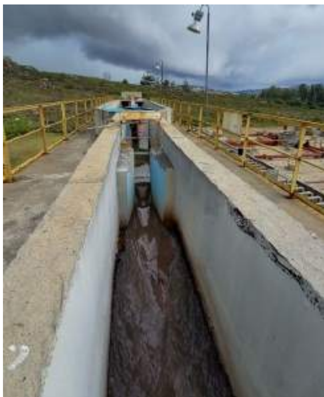
Figura 94 - Tratamento preliminar da ETE da sede municipal.
