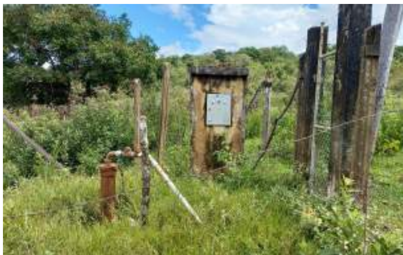
Figura 88 - Captação subterrânea na comunidade Boa Vista. Fonte: Profill Engenharia e Ambiente, 2020.
