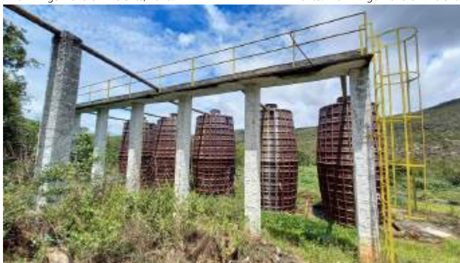
Figura 128 - Reatores UASB da ETE de Senador Mourão.
