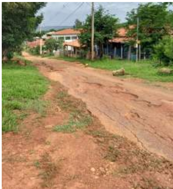
Figura 175 - Asfalto deteriorado em Desembargador Otoni.
