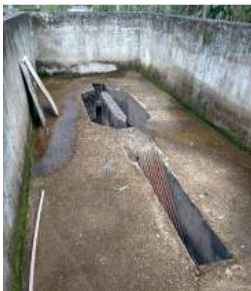
Figura 117 - EEE 01 de Mendanha. Fonte: Profill Engenharia e Ambiente, 2020.
