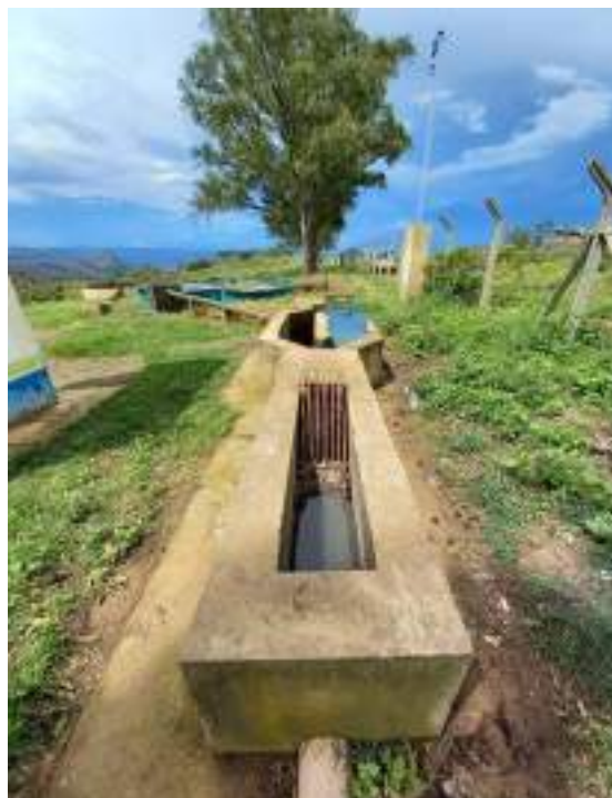
Figura 112 - Tratamento preliminar da ETE de São João da Chapada. Fonte: Profill Engenharia e Ambiente, 2020.
