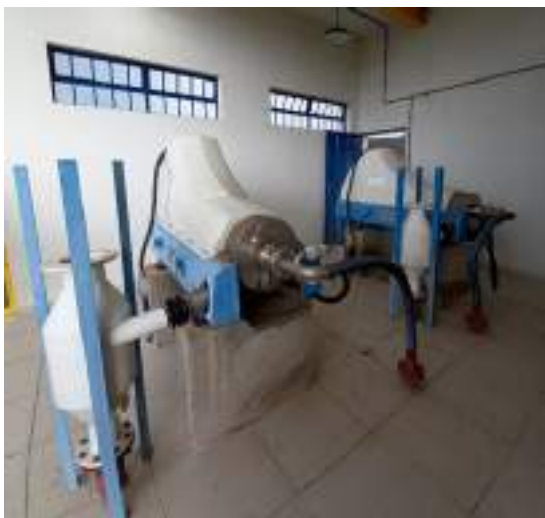
Figura 97 - Desidratação do lodo da ETE da sede municipal.
