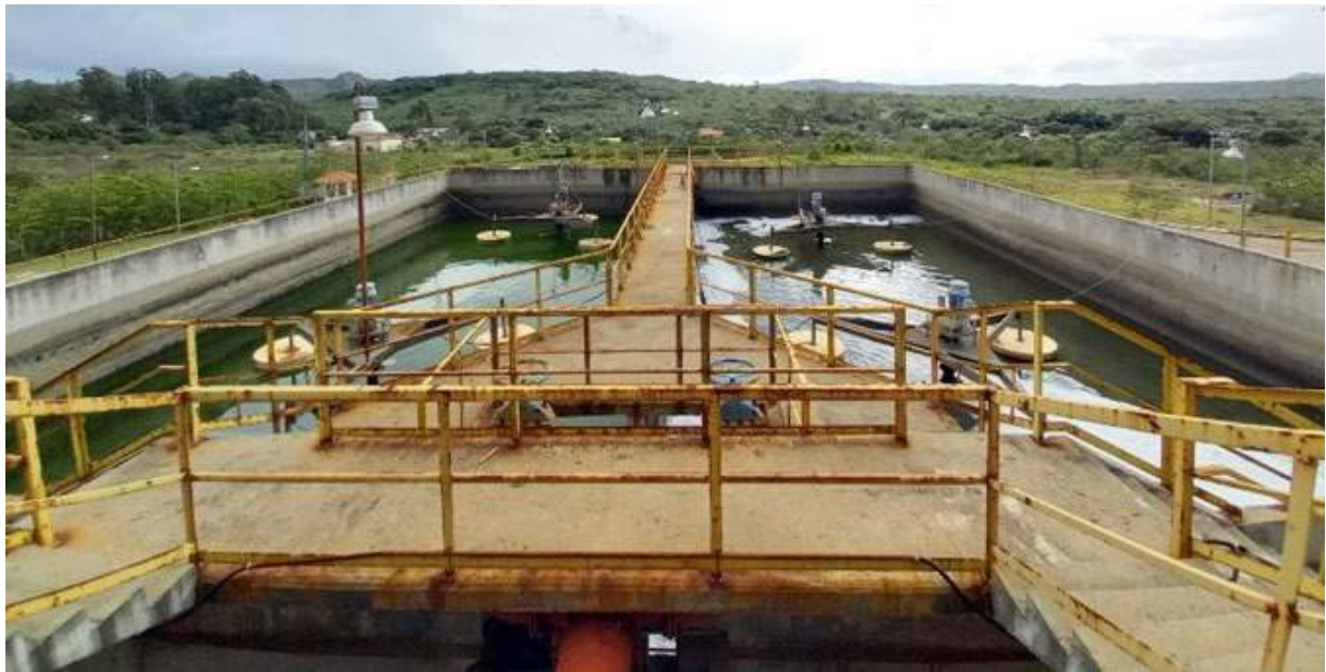
Figura 96 - Reatores de lodo ativado da ETE da sede municipal.
