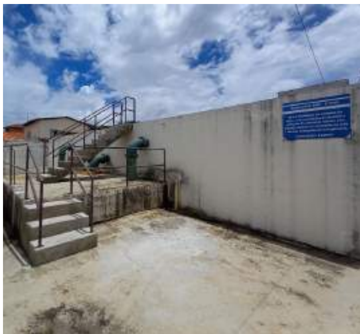
Figura 38 - Reservatório R09 - R1000 da sede municipal.
