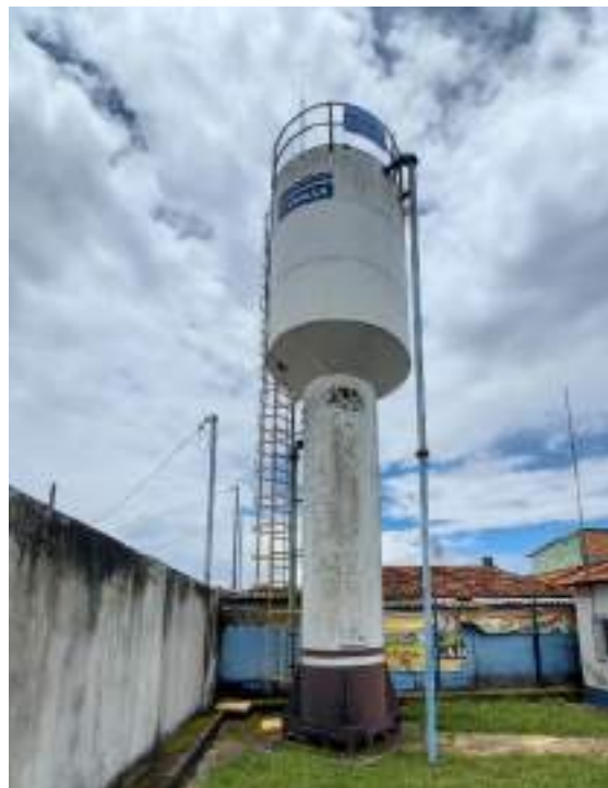
Figura 37 - Reservatório R08 - Casas Populares elevado da sede municipal.
