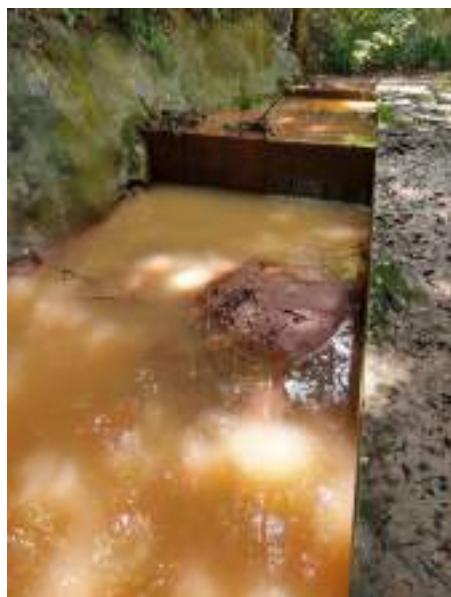
Figura 73 - Captação superficial de Senador Mourão.
