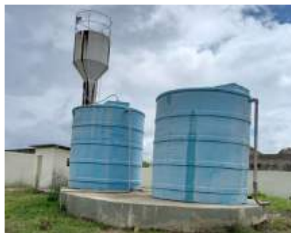
Figura 53 - Reservatórios RAP 01 e RAP 02 em Sopa.
