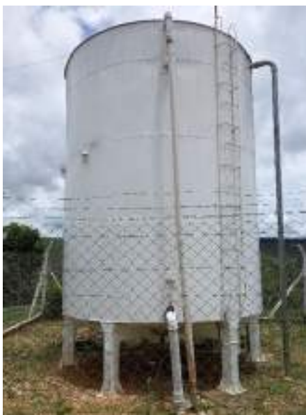
Figura 74 - Reservatório apoiado de Senador Mourão.
