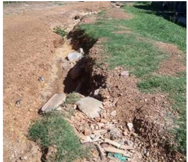
Figura 173 - Erosão no distrito de Conselheiro Mata.
