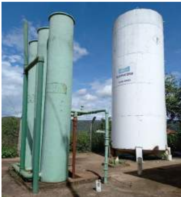
Figura 68 - Filtro e reservatório de Maria Nunes. Fonte: Profill Engenharia e Ambiente, 2020.
