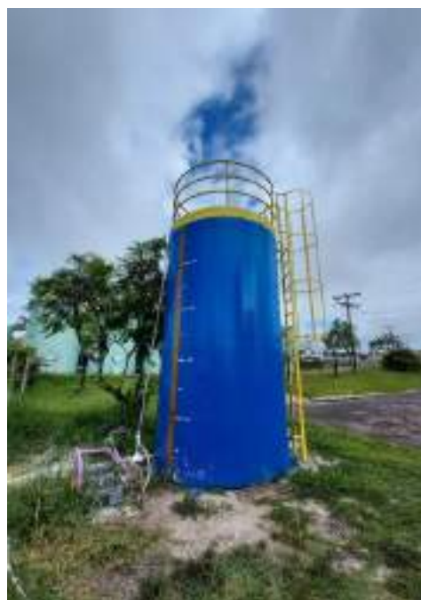
Figura 30 - Reservatório de armazenamento da cal em suspensão. Fonte: Profill Engenharia e Ambiente, 2020.
