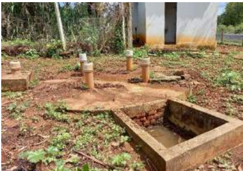
Figura 139 - Filtro da ETE de Planalto de Minas.
