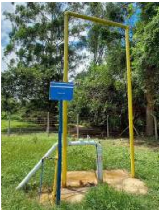
Figura 42 - Poço C05 da sede municipal.
