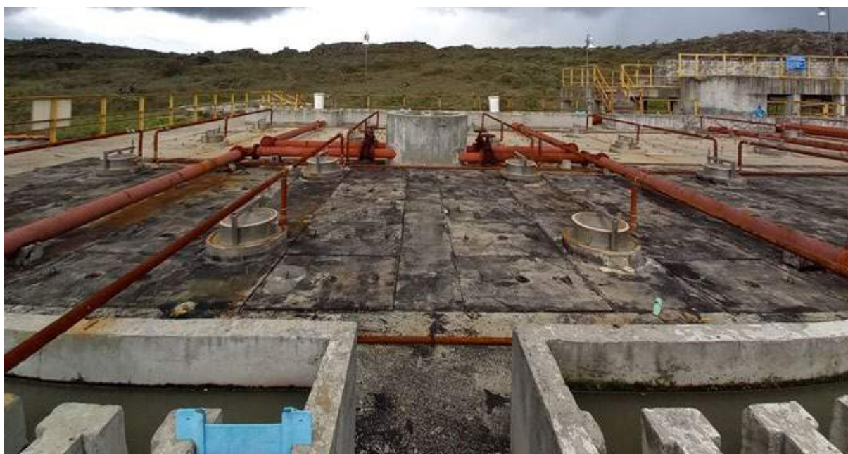
Figura 95 - Reatores UASB da ETE da sede municipal.
