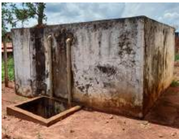
Figura 82 - Reservatório RAP 01 de Planalto de Minas.
