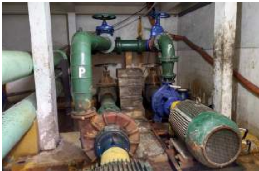
Figura 31 - EEAT 01 da sede municipal.
