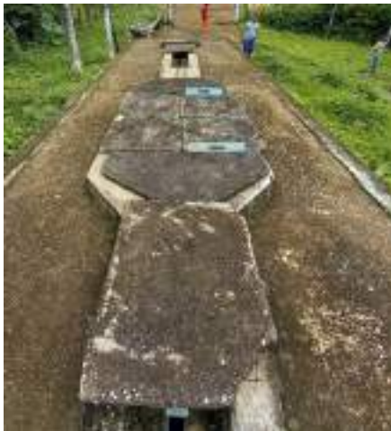
Figura 122 - Tratamento preliminar da ETE Inhaí.
