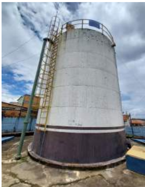
Figura 36 - Reservatório R07 - Casas Populares apoiado da sede municipal.
