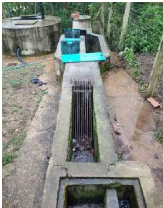
Figura 111 - EEE de São João da Chapada. Fonte: Profill Engenharia e Ambiente, 2020.
