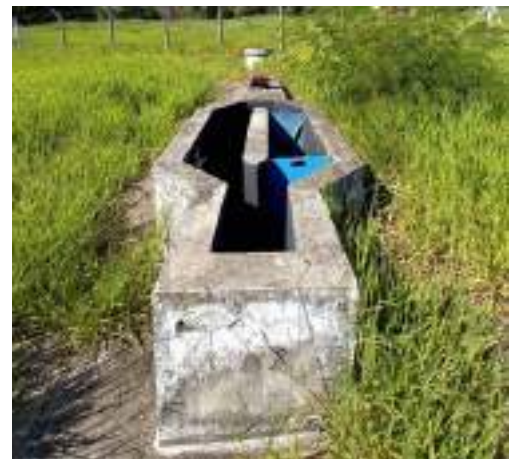
Figura 101 - Tratamento preliminar da ETE de Conselheiro Mata. Fonte: Profill Engenharia e Ambiente, 2020.
