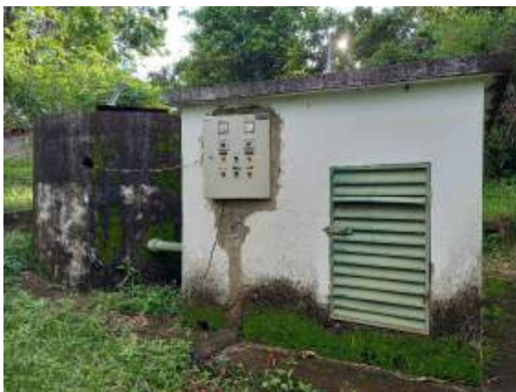
Figura 118 - EEE 02 de Mendanha. Fonte: Profill Engenharia e Ambiente, 2020.
