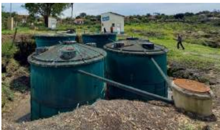
Figura 113 - Reatores e filtros da ETE de São João da Chapada. Fonte: Profill Engenharia e Ambiente, 2020.
