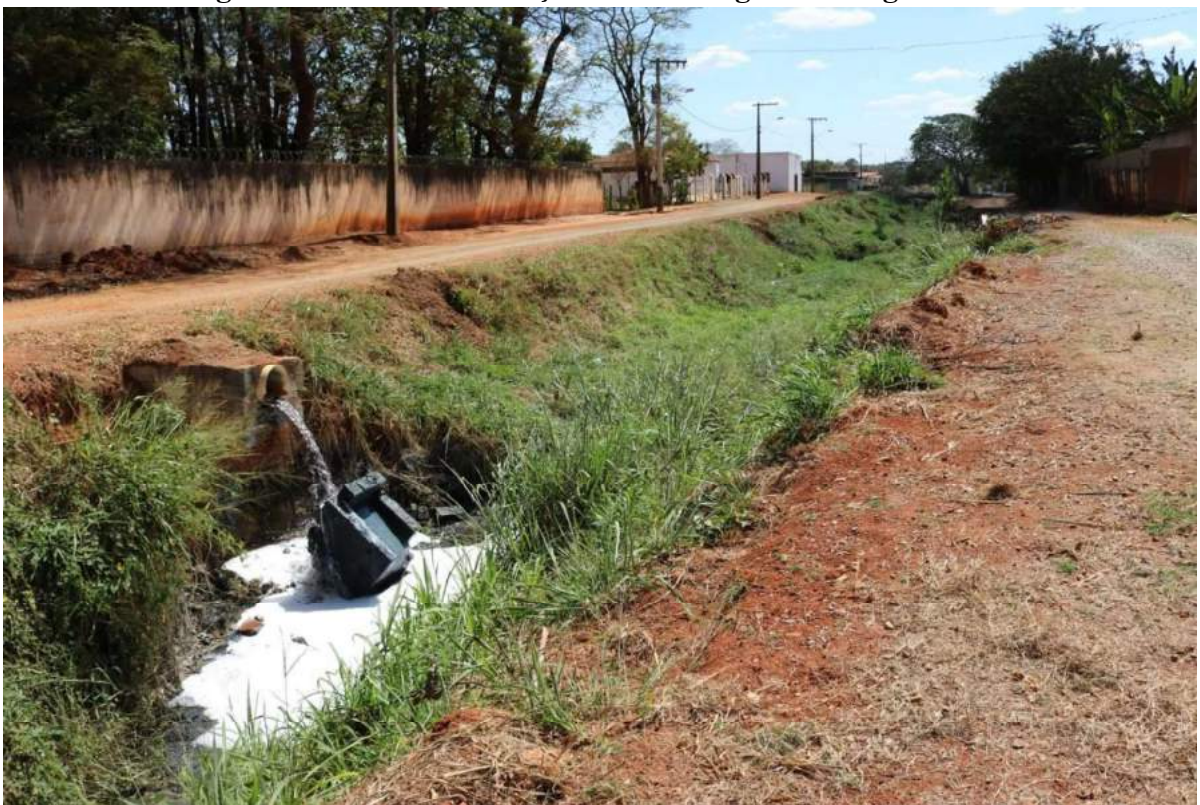
Figura 155 -Ponto de Lançamento de Esgoto Córrego do Beco
