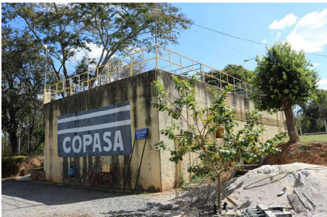
Figura 36-Estação de Tratamento de Água
