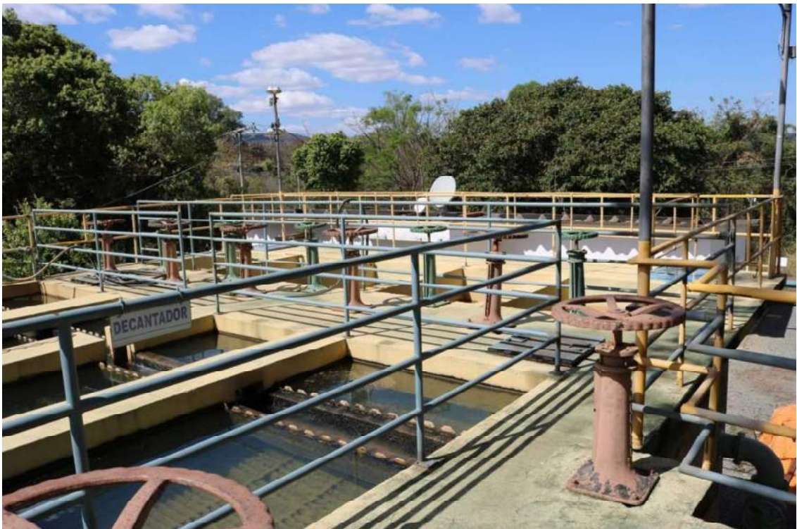
Figura 38-Estação de Tratamento de Água
