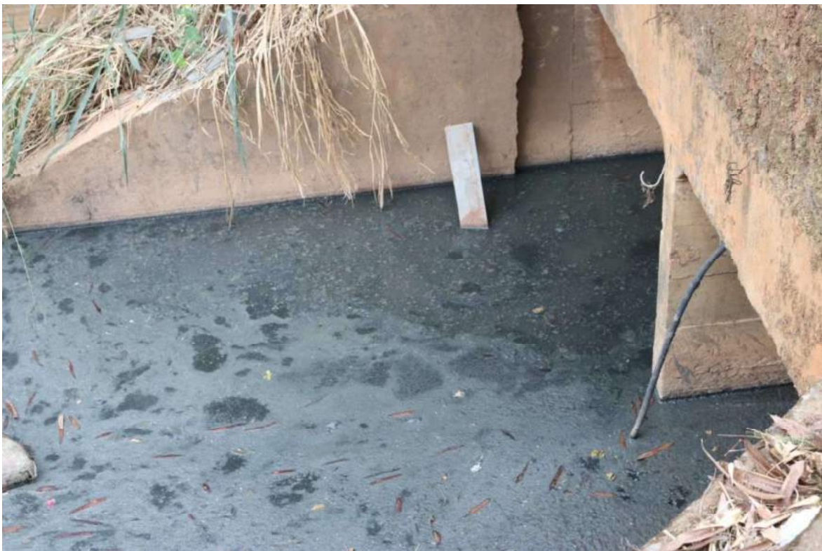
Figura 123 -Ponto de Lançamento de Esgoto Córrego Matias
