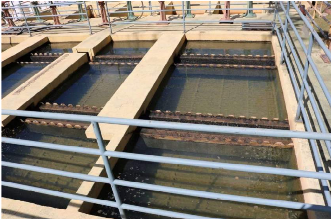
Figura 39-Estação de Tratamento de Água
