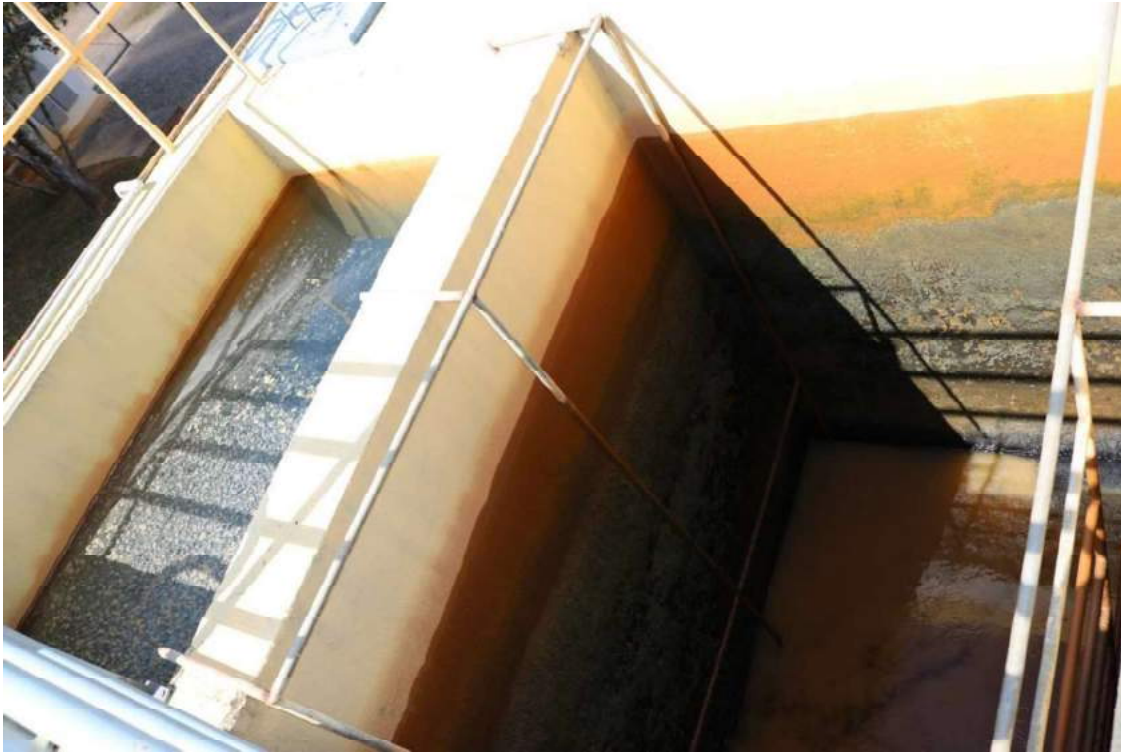
Figura 45-Estação de Tratamento de Água
