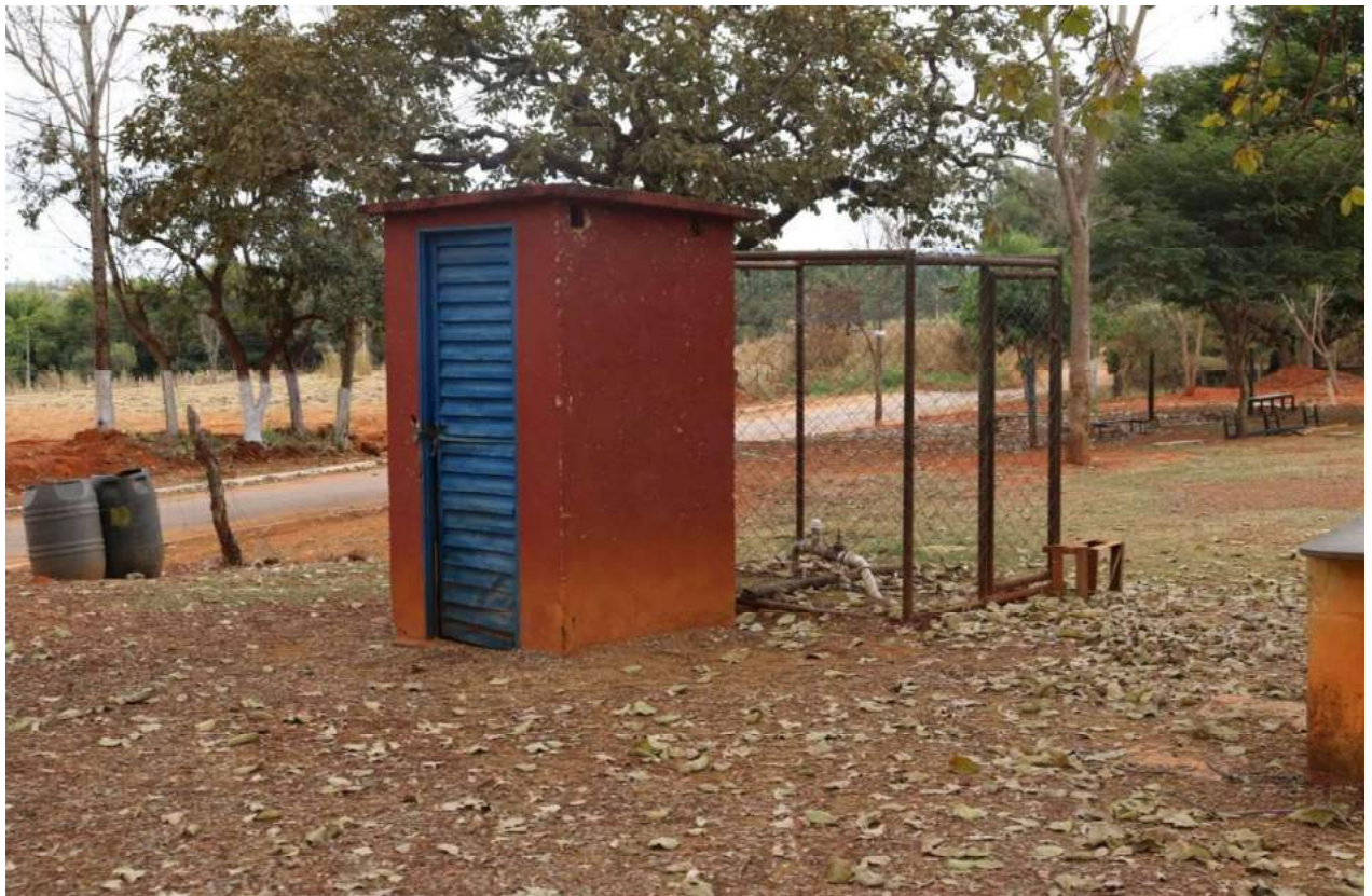
Figura 57-Poço Artesiano Picada
