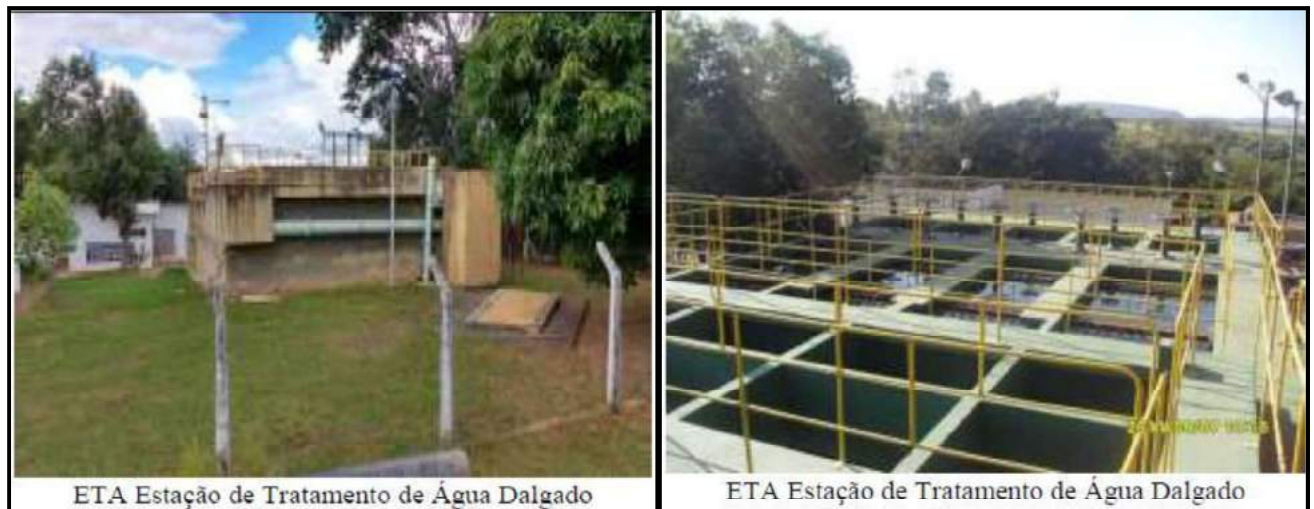
Figura 51-Estação de Tratamento de Água Dalgado
