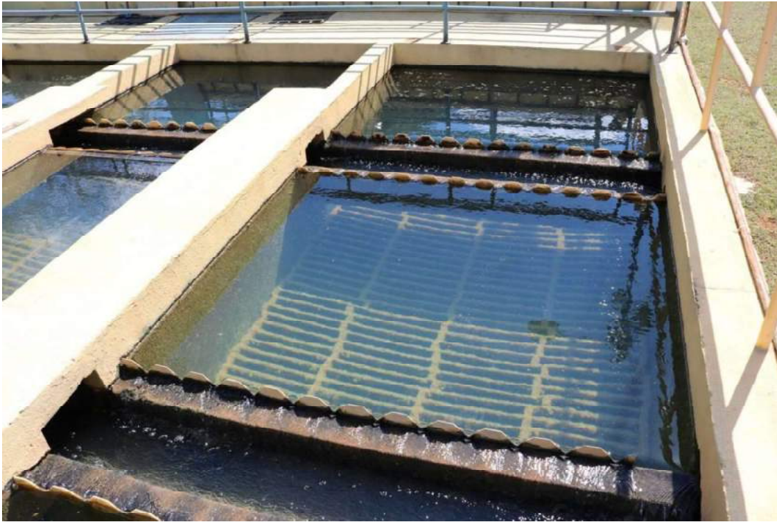
Figura 43-Estação de Tratamento de Água
