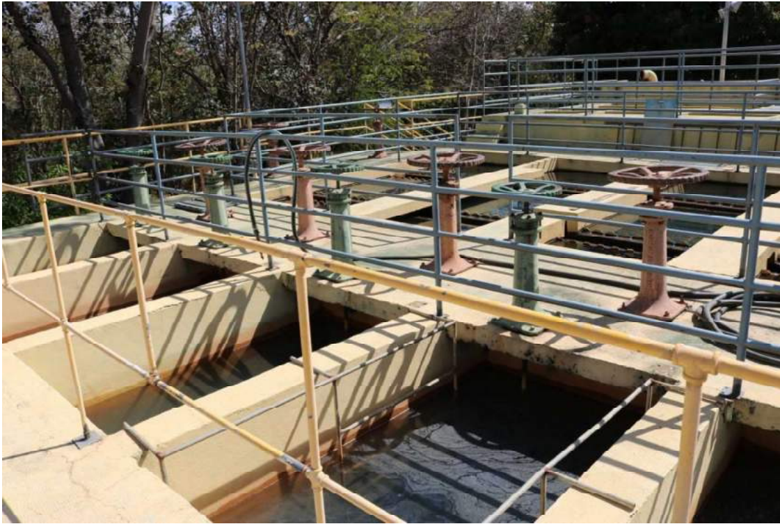
Figura 47-Estação de Tratamento de Água
