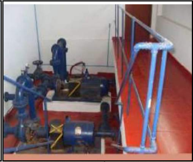
EAT 3 Estação Elevatória de Água Tratada Beco Matias
