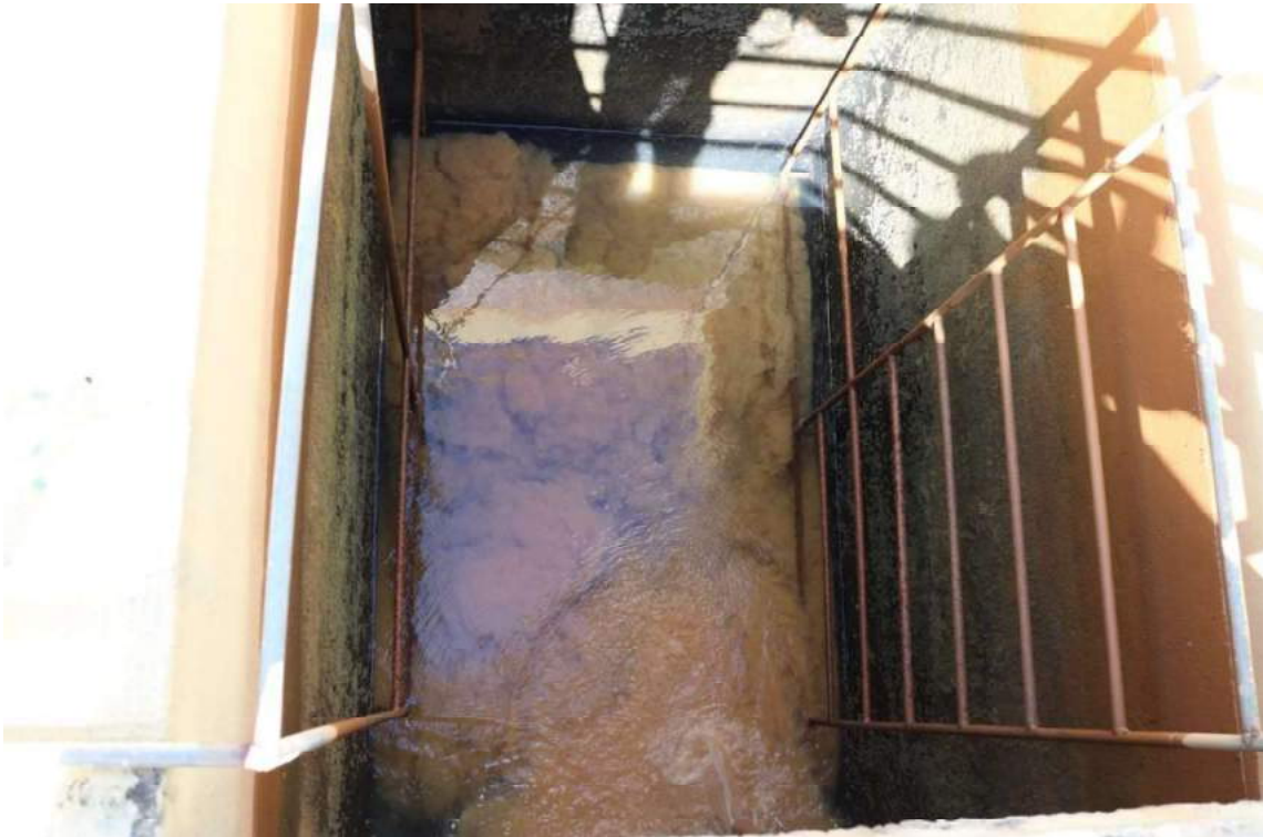
Figura 44-Estação de Tratamento de Água
