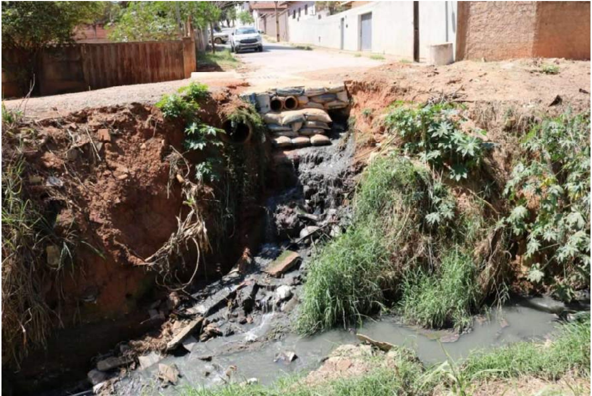
Figura 144 -Ponto de Lançamento de Esgoto Córrego do Beco
