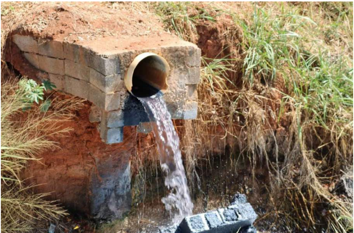
Figura 153 -Ponto de Lançamento de Esgoto Córrego do Beco
