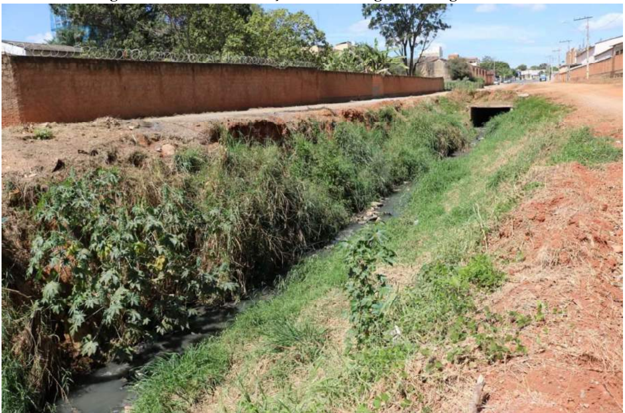
Figura 145 -Ponto de Lançamento de Esgoto Córrego do Beco
