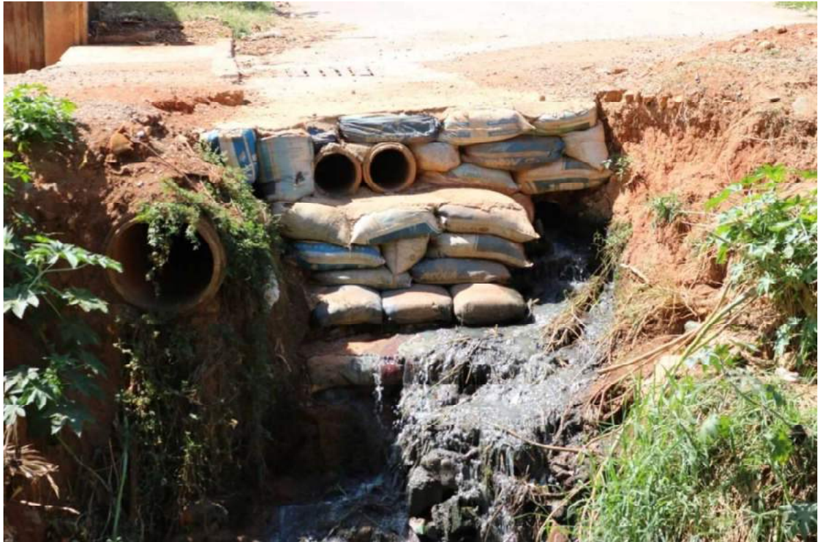
Figura 142 -Ponto de Lançamento de Esgoto Córrego do Beco
