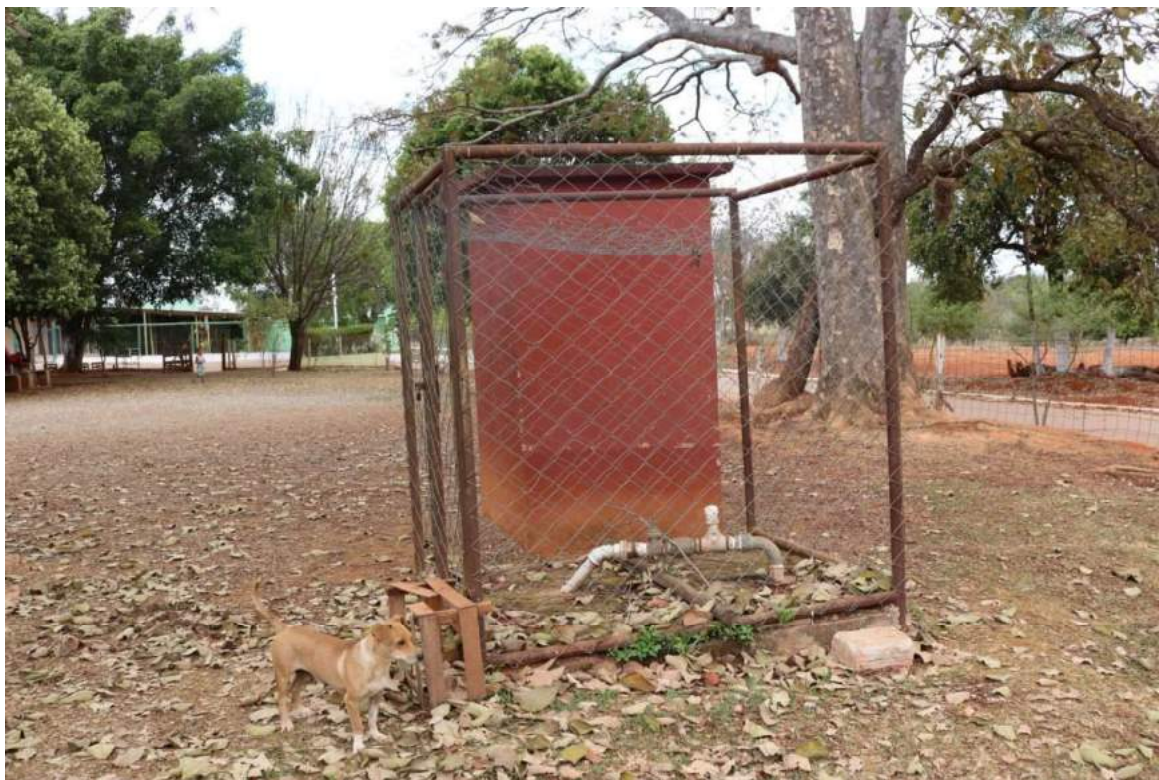
Figura 59-Poço Artesiano Picada
