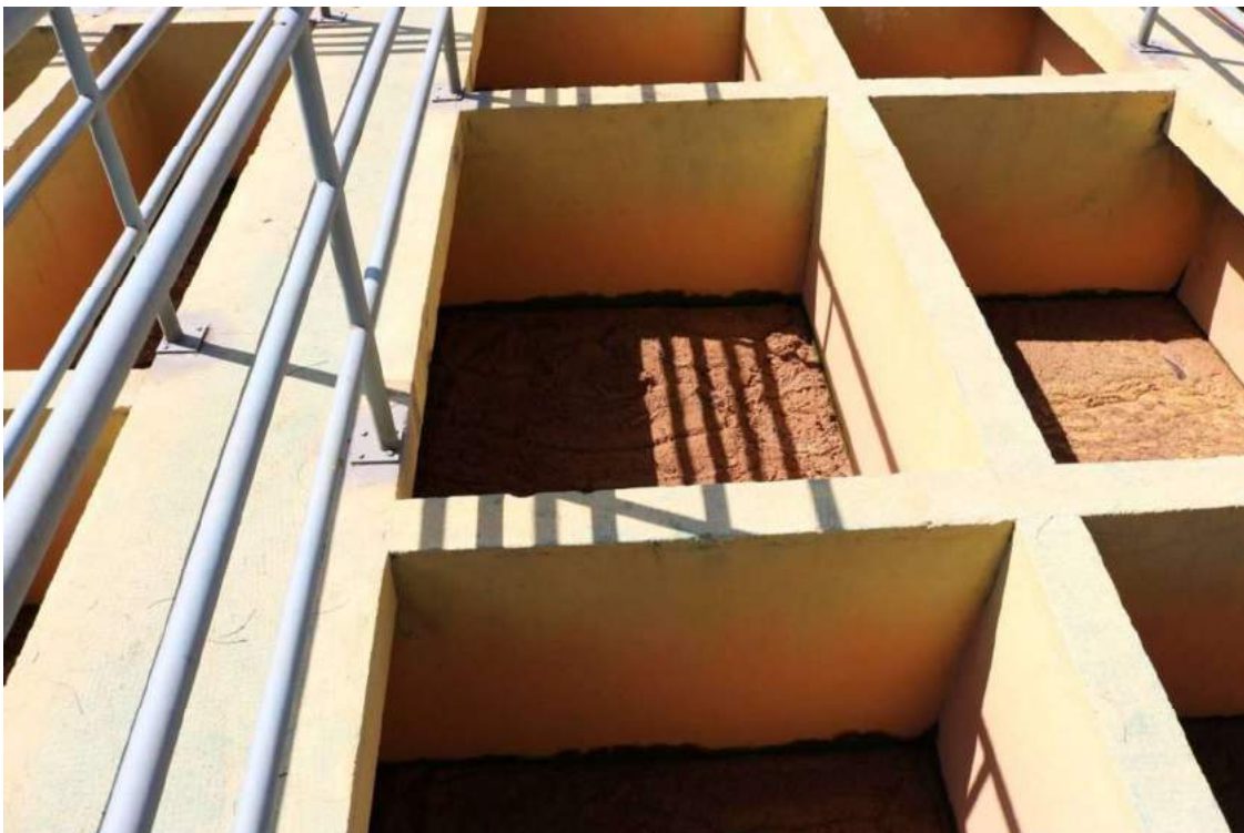
Figura 48-Estação de Tratamento de Água
