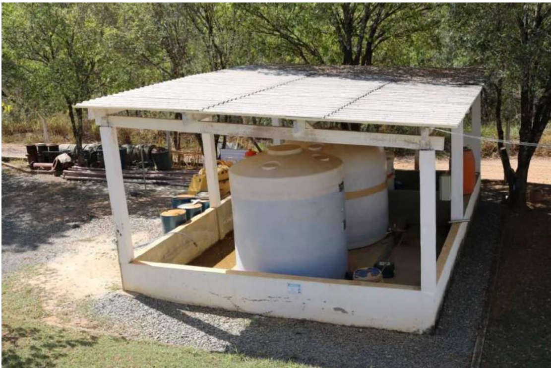
Figura 42-Estação de Tratamento de Água
