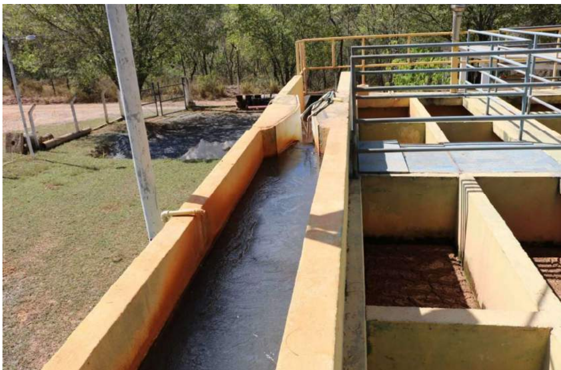
Figura 50-Estação de Tratamento de Água
