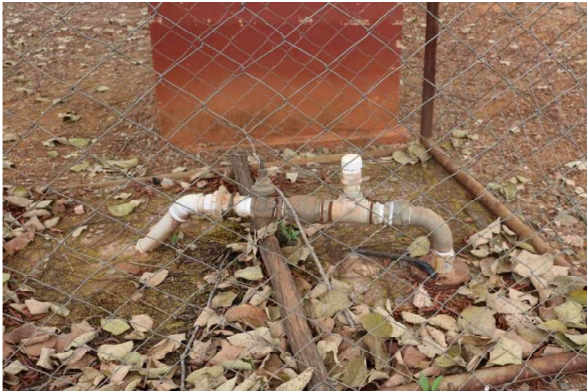
Figura 58-Poço Artesiano Picada
