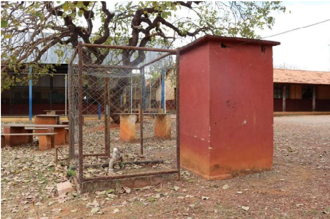
Figura 60 Poço Artesiano Picada
