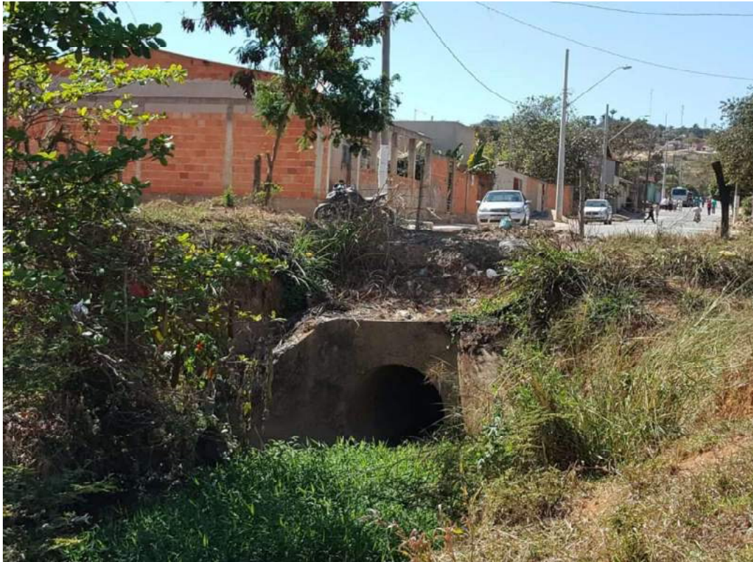
Figura 120-Ponto de Lançamento de Esgoto Córrego Matias
