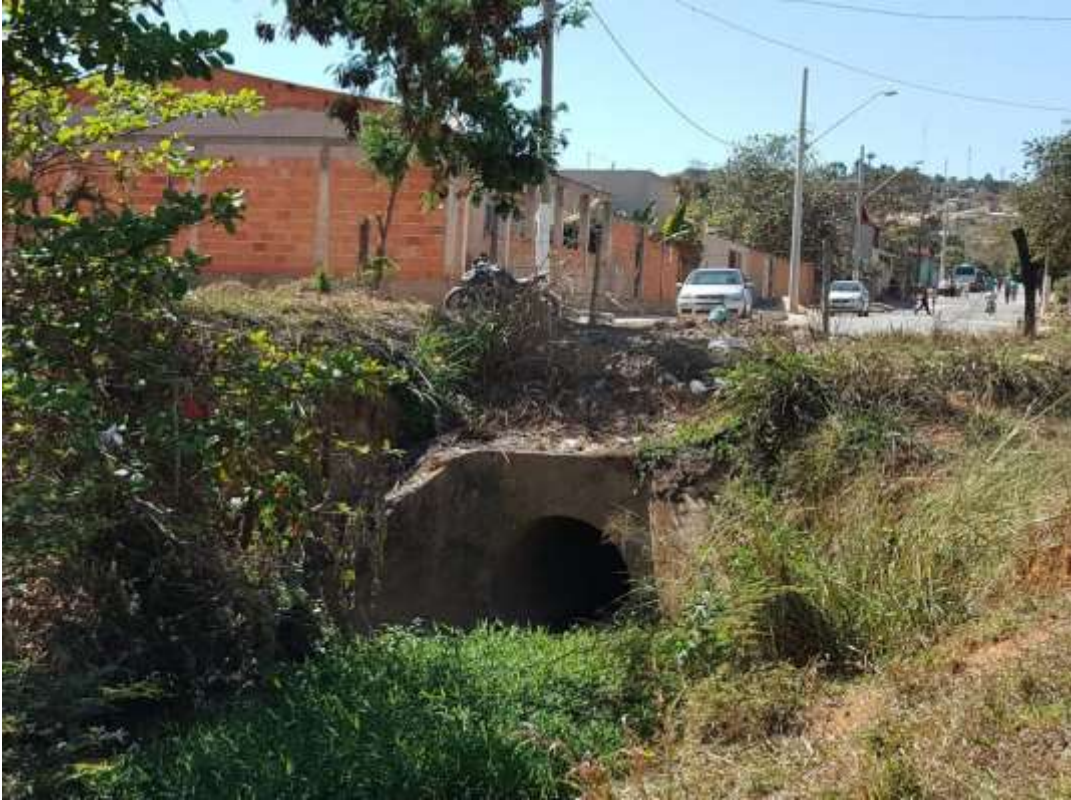
Figura 160-Ponto de Lançamento de Esgoto Córrego Matias
