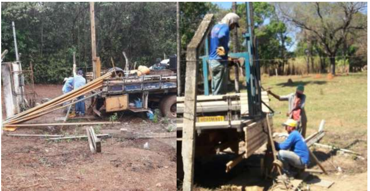
Figura 129-Poço Artesiano Pontinha
