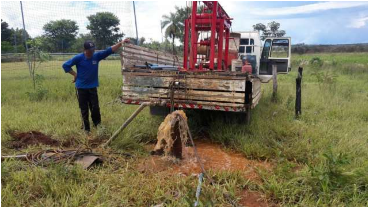
Figura 134-Poço Artesiano Pontinha
