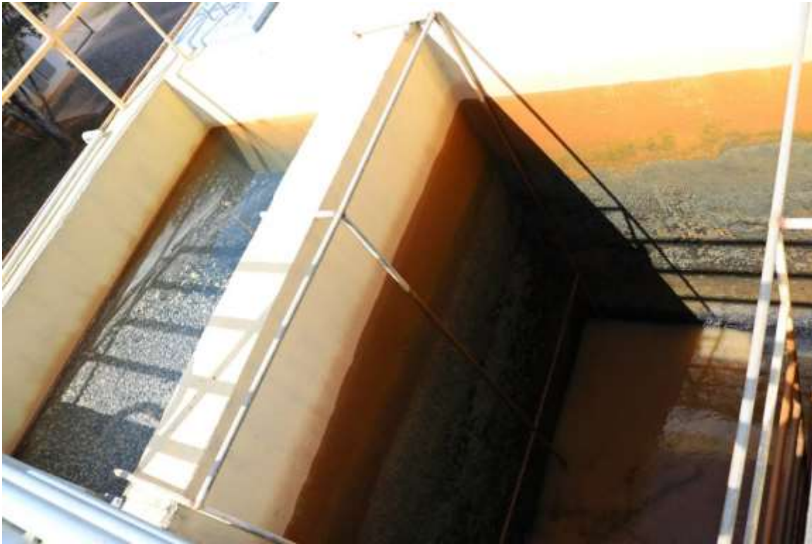
Figura 84-Estação de Tratamento de Água
