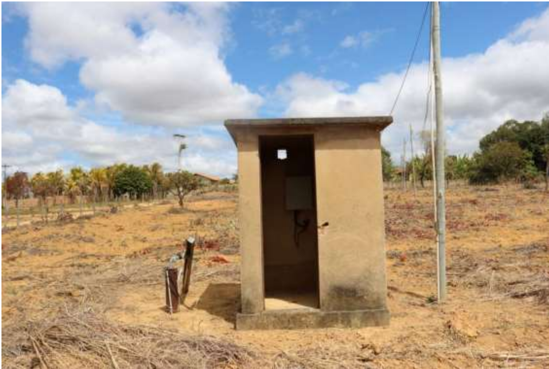
Figura 122-Poço Artesiano Embiruçu
