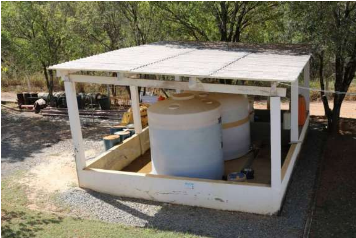
Figura 81-Estação de Tratamento de Água
