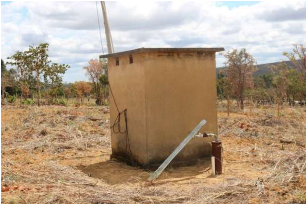
Figura 120- Poço Artesiano Embiruçu
