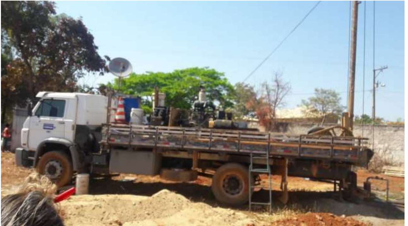
Figura 130-Poço Artesiano Pontinha
