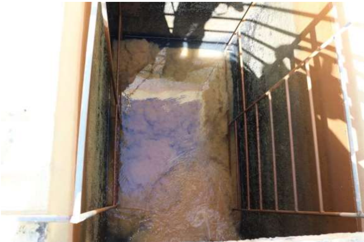
Figura 83-Estação de Tratamento de Água
