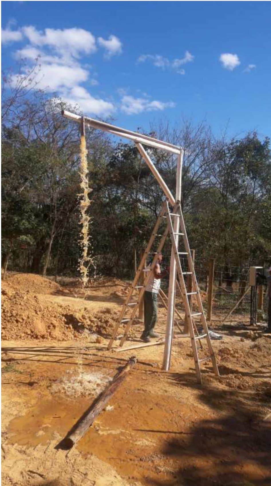
Figura 126-Poço Artesiano Lajes
