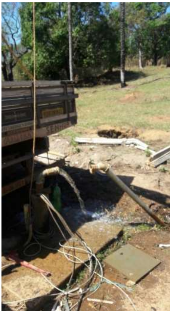
Figura 127-Poço Artesiano Pontinha
