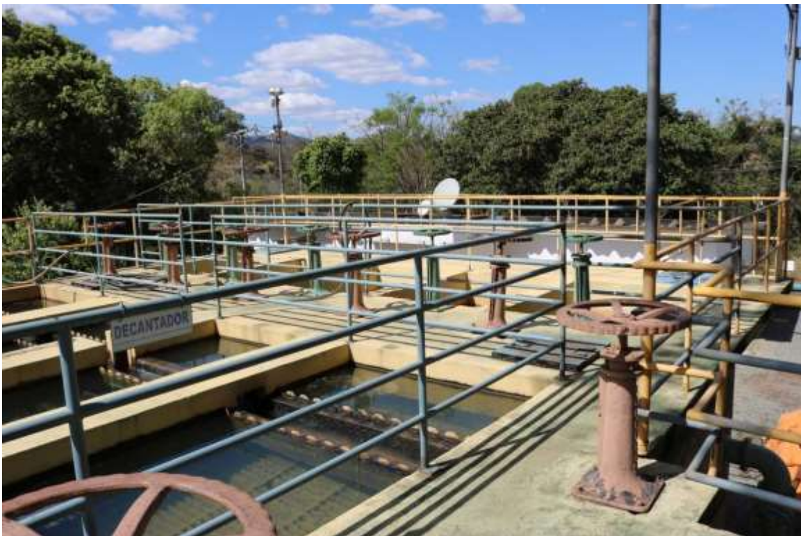
Figura 77-Estação de Tratamento de Água
