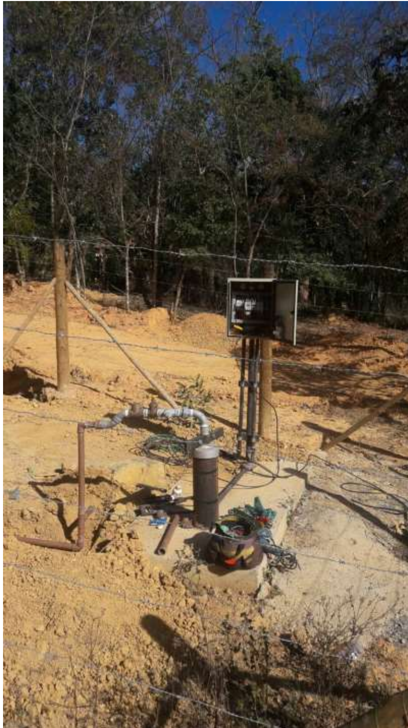
Figura 124-Poço Artesiano Lajes
