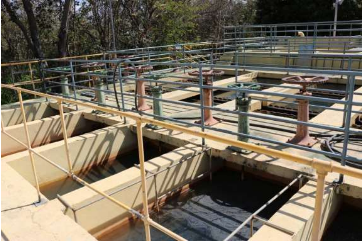
Figura 86-Estação de Tratamento de Água
