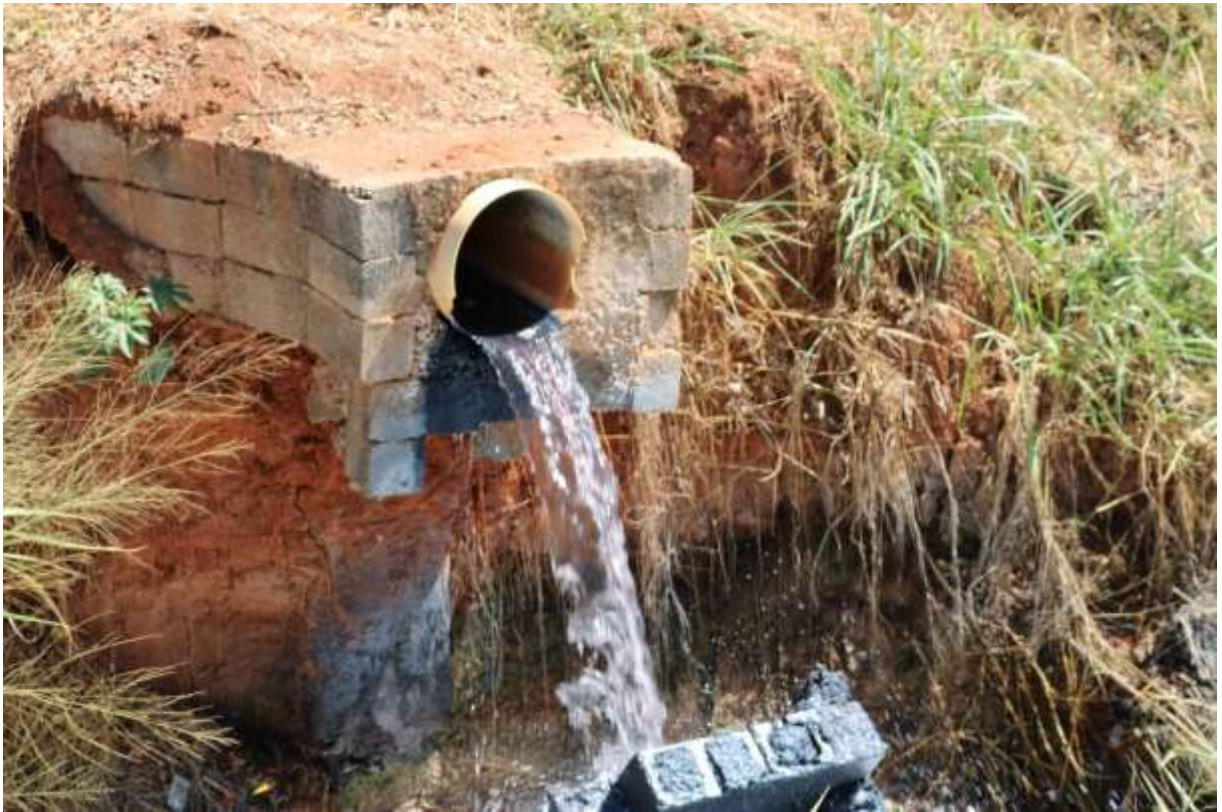
Figura 193-Ponto de Lançamento de Esgoto Córrego do Beco
