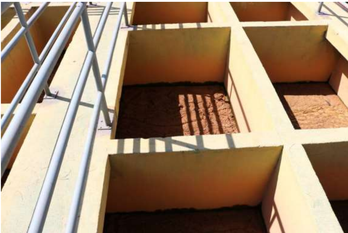
Figura 87-Estação de Tratamento de Água
