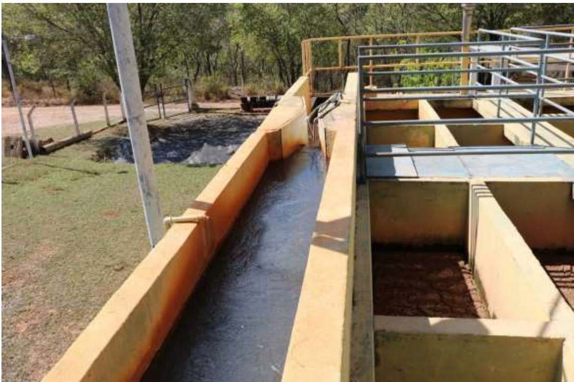
Figura 89-Estação de Tratamento de Água
