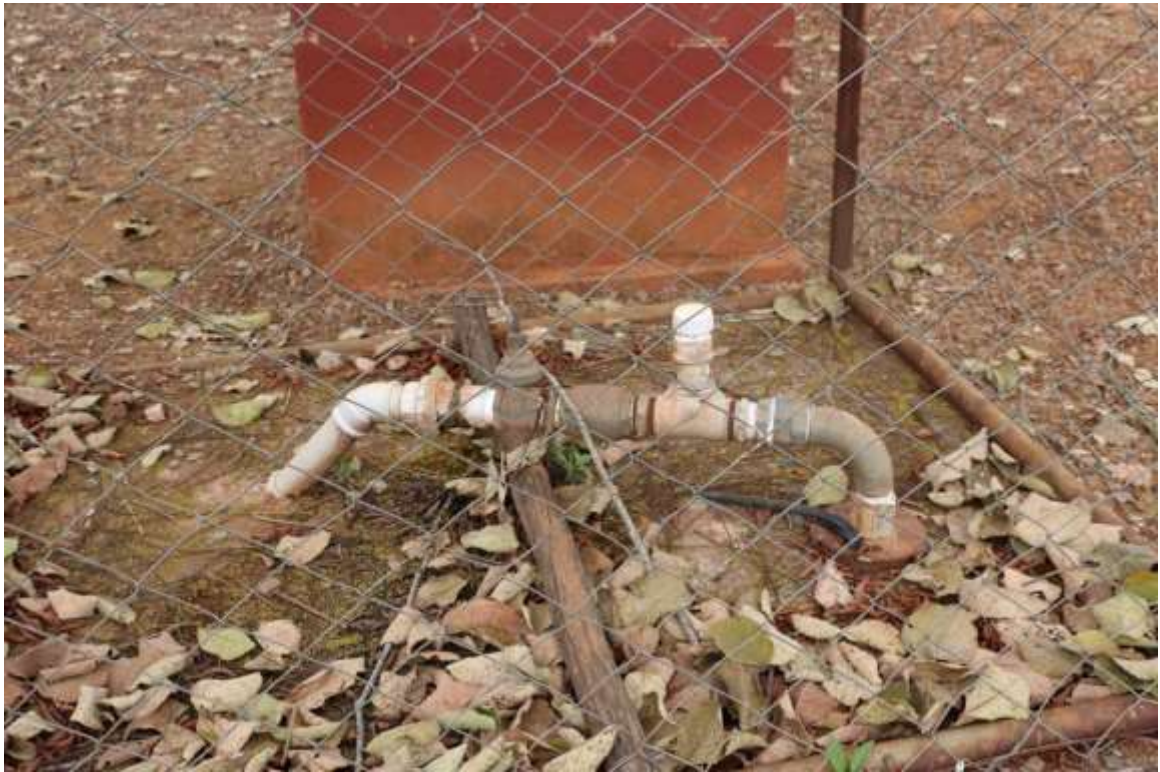
Figura 98-Poço Artesiano Picada
