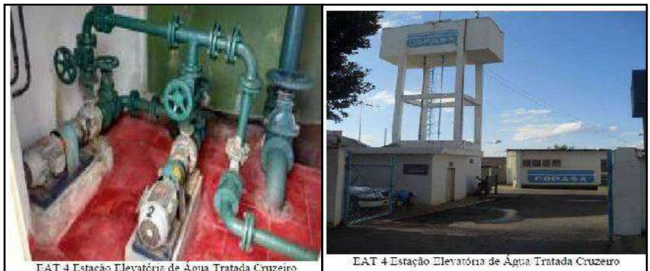
Figura 94-Estação Elevatória de Água Tratada Cruzeiro EAT 4
