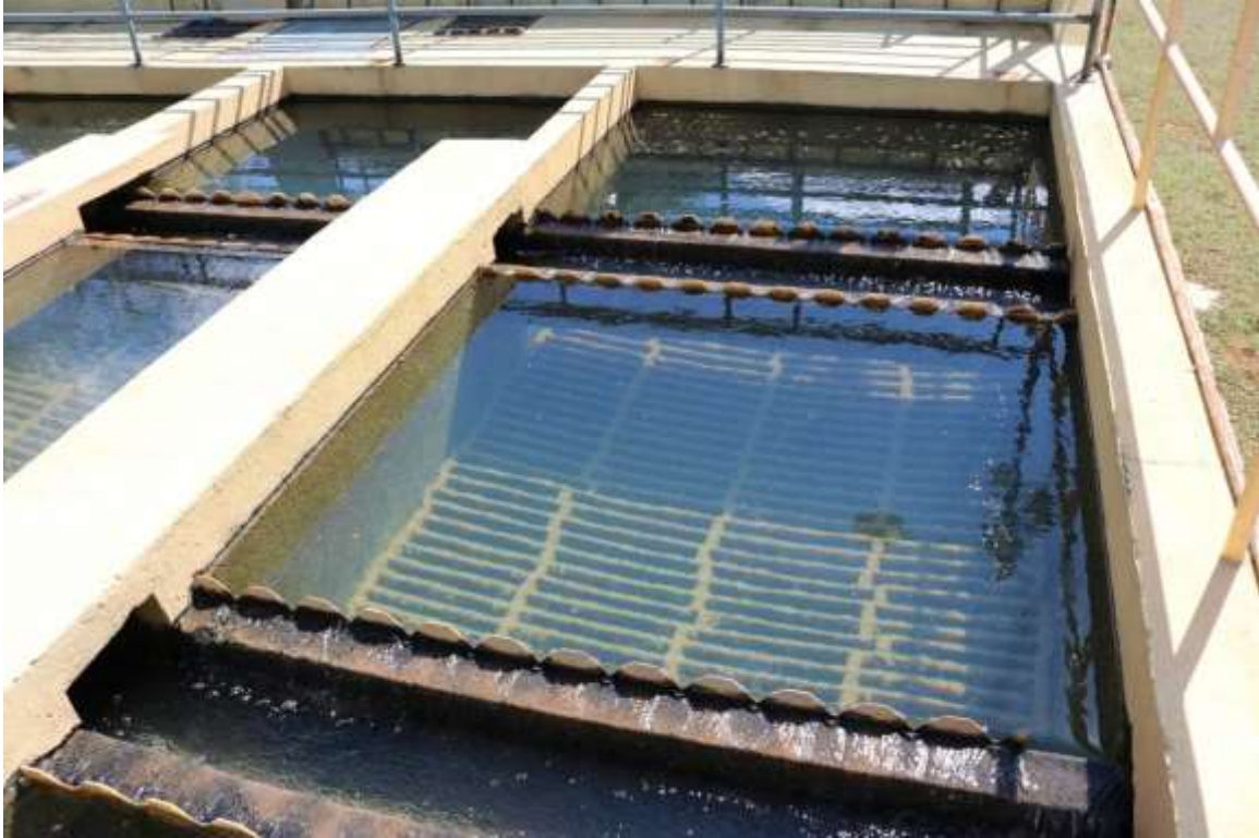
Figura 82-Estação de Tratamento de Água
