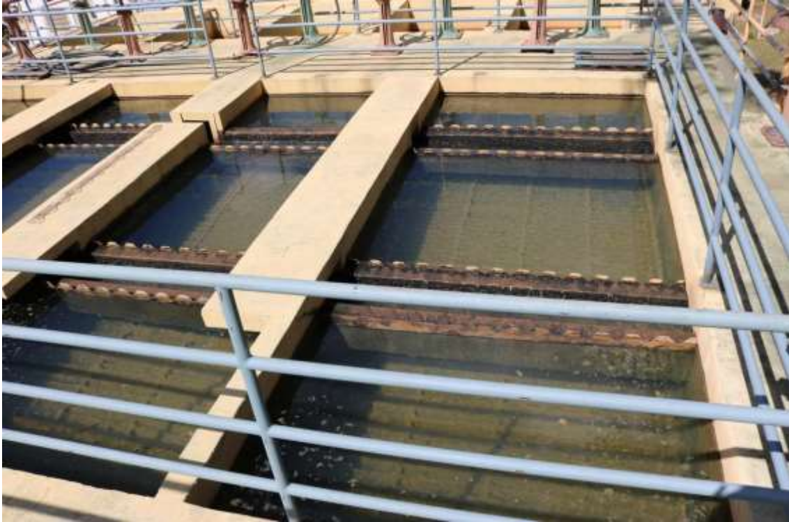
Figura 78-Estação de Tratamento de Água
