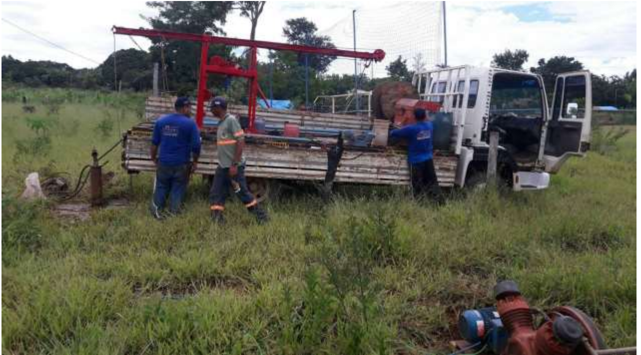
Figura 132-Poço Artesiano Pontinha
