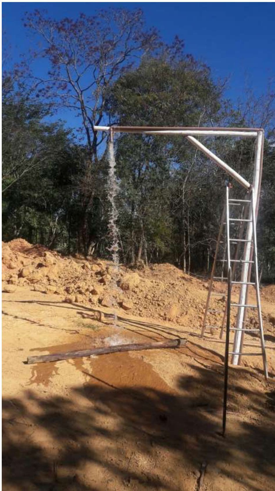
Figura 125-Poço Artesiano Lajes
