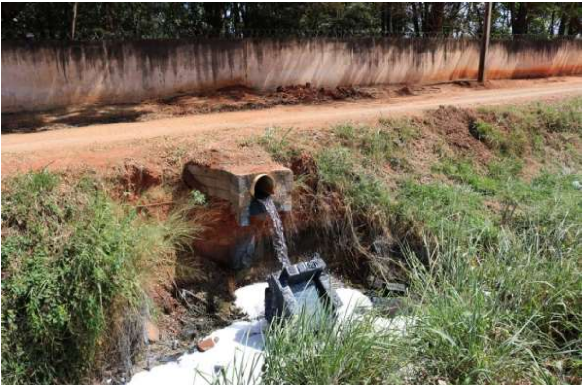
Figura 194-Ponto de Lançamento de Esgoto Córrego do Beco
