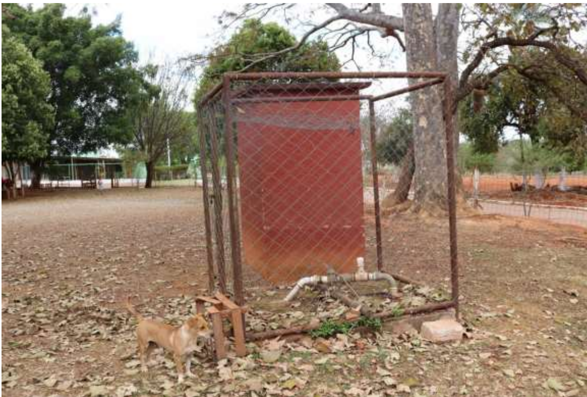
Figura 99-Poço Artesiano Picada
