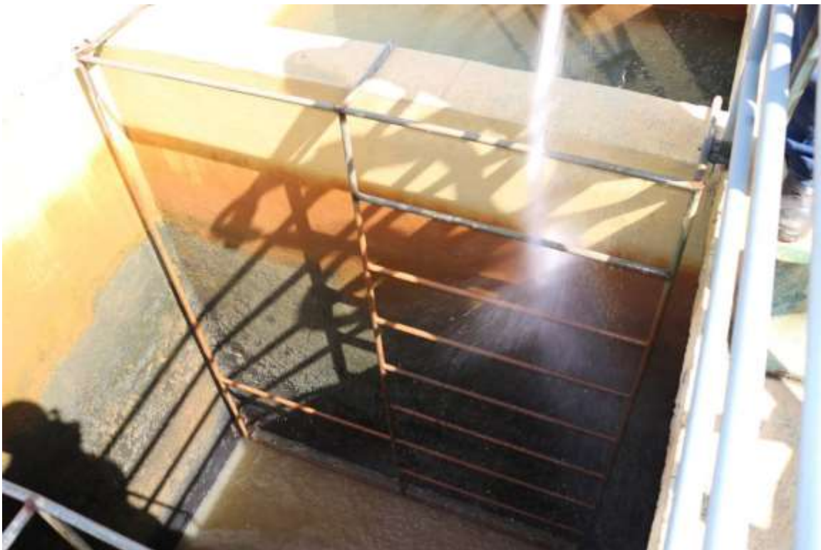
Figura 85-Estação de Tratamento de Água
