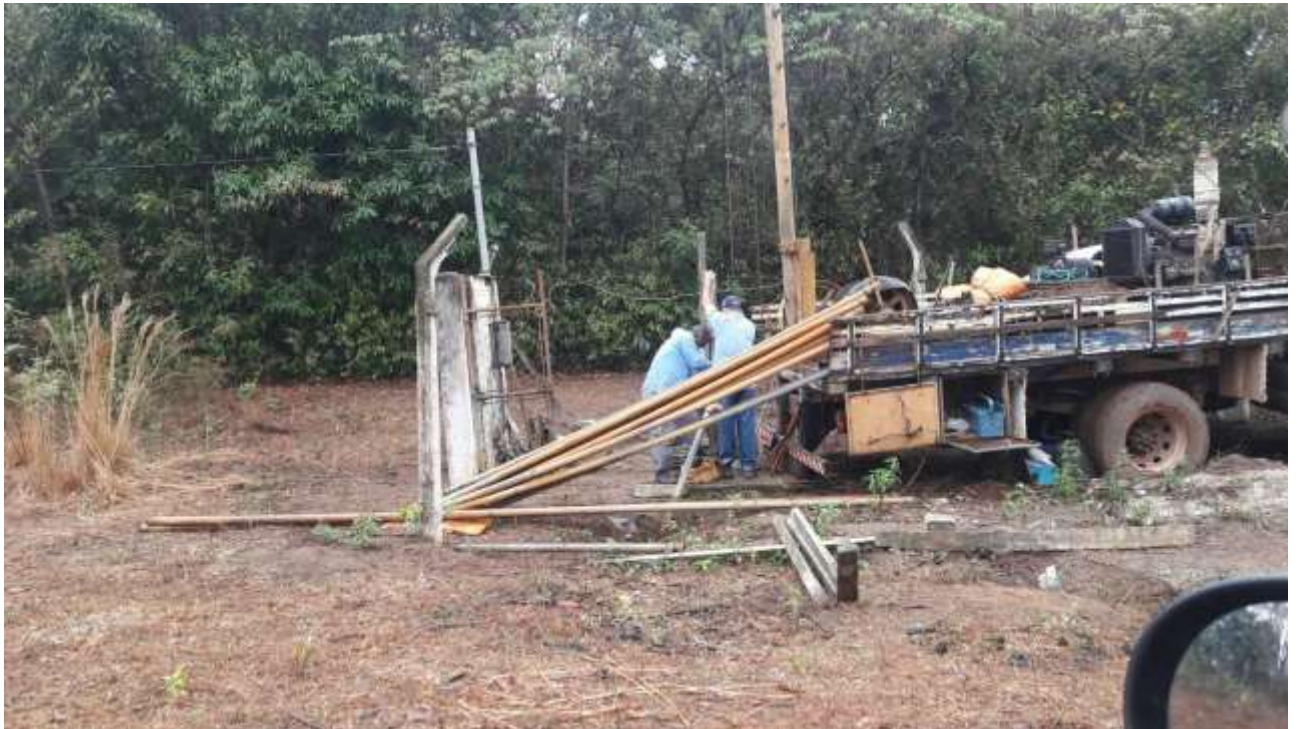
Figura 128-Poço Artesiano Pontinha
