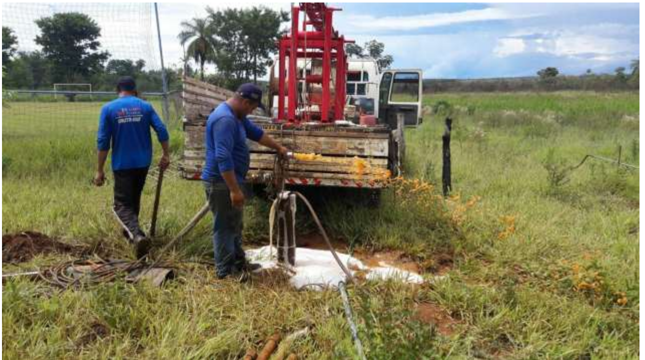
Figura 135-Poço Artesiano Pontinha
