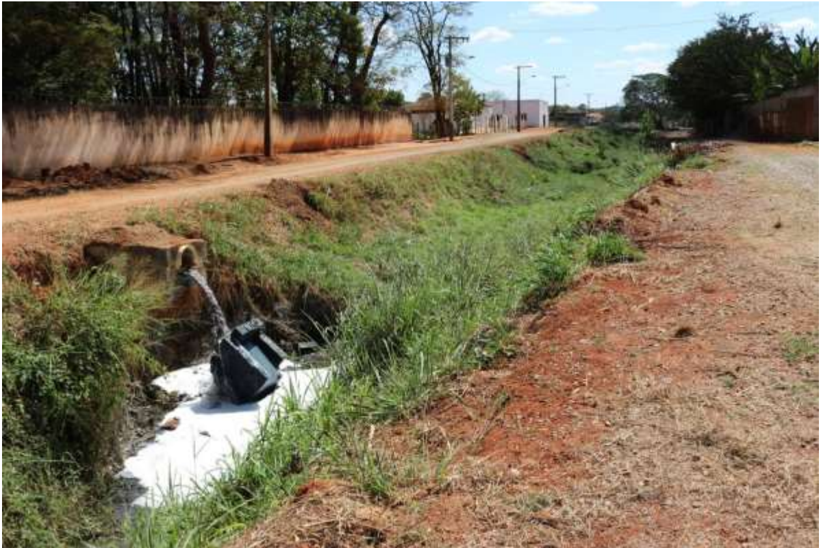
Figura 195-Ponto de Lançamento de Esgoto Córrego do Beco
