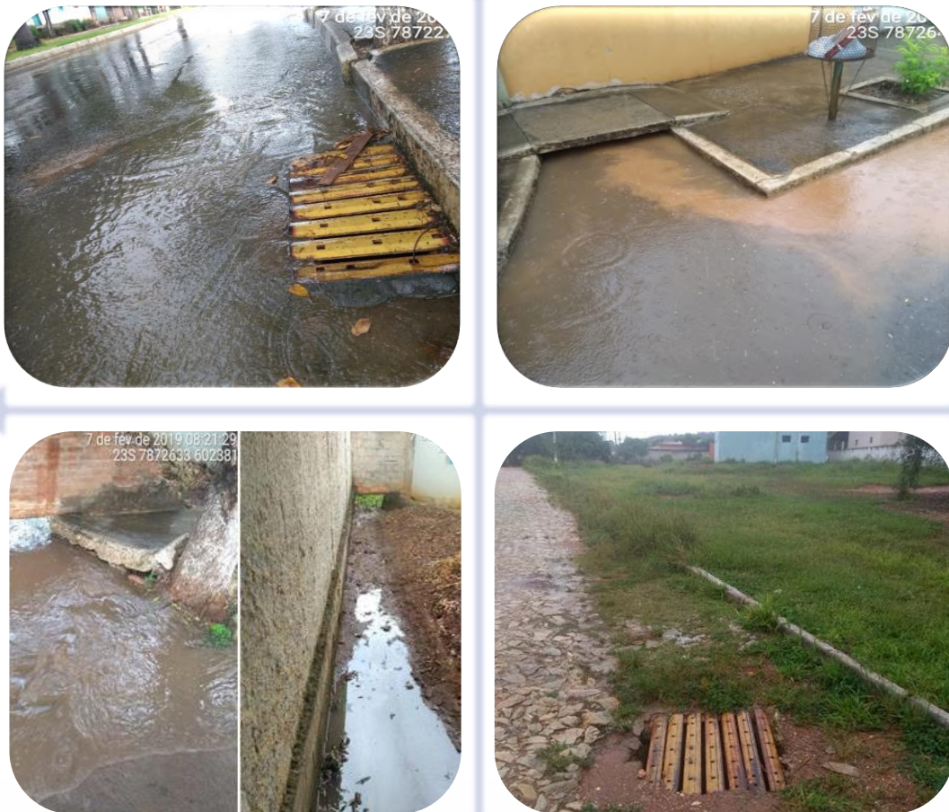
Figura 18 – Dispositivos de microdrenagem em situação precária identificados em Jequitibá, ou ausência de tais dispositivos na via, acarretando acúmulo de água
