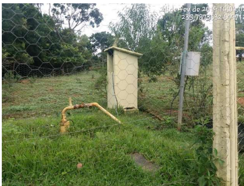
Figura 105 – Poço em Quebra Perna Fonte: Seletiva Consultoria e Projetos, 2019.
