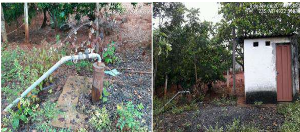
Figura 123 – Poço artesiano localizado em Retiro
