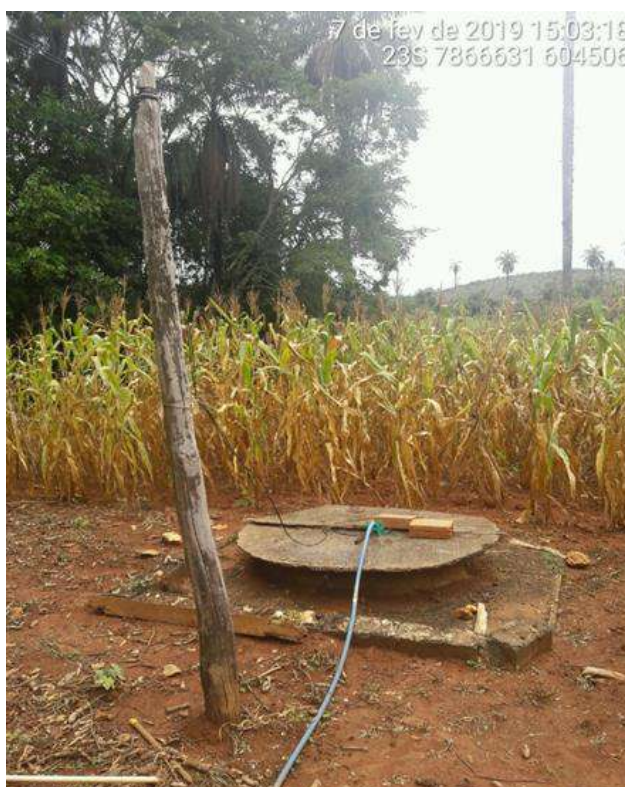
Figura 164 – Fossa rudimentar com suspiro em Bebedouro Fonte: Prefeitura Municipal, 2019.
