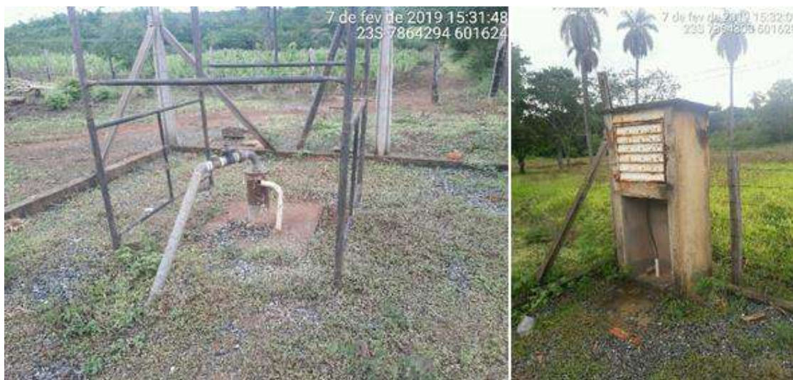
Figura 121 – Poço e padrão de energia em Campo Alegre Fonte: Seletiva Consultoria e Projetos, 2019.
