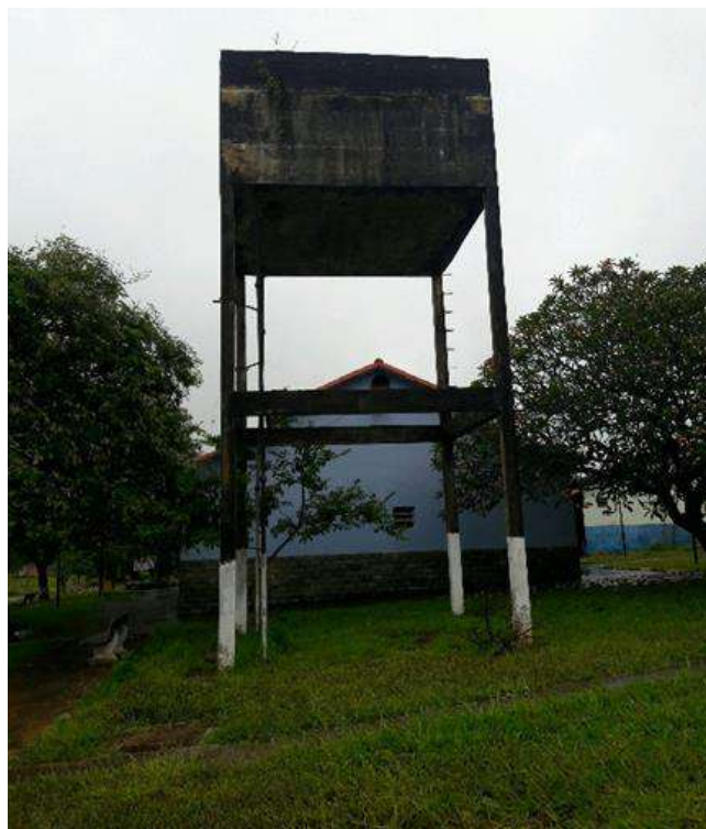
Figura 117 – Reservatório em Lagoa Santo Antônio
