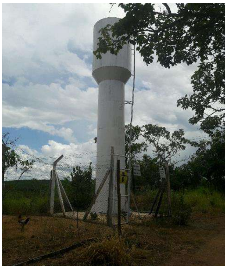
Figura 130 – Reservatório em Onça Fonte: Seletiva Consultoria e Projetos, 2019.
