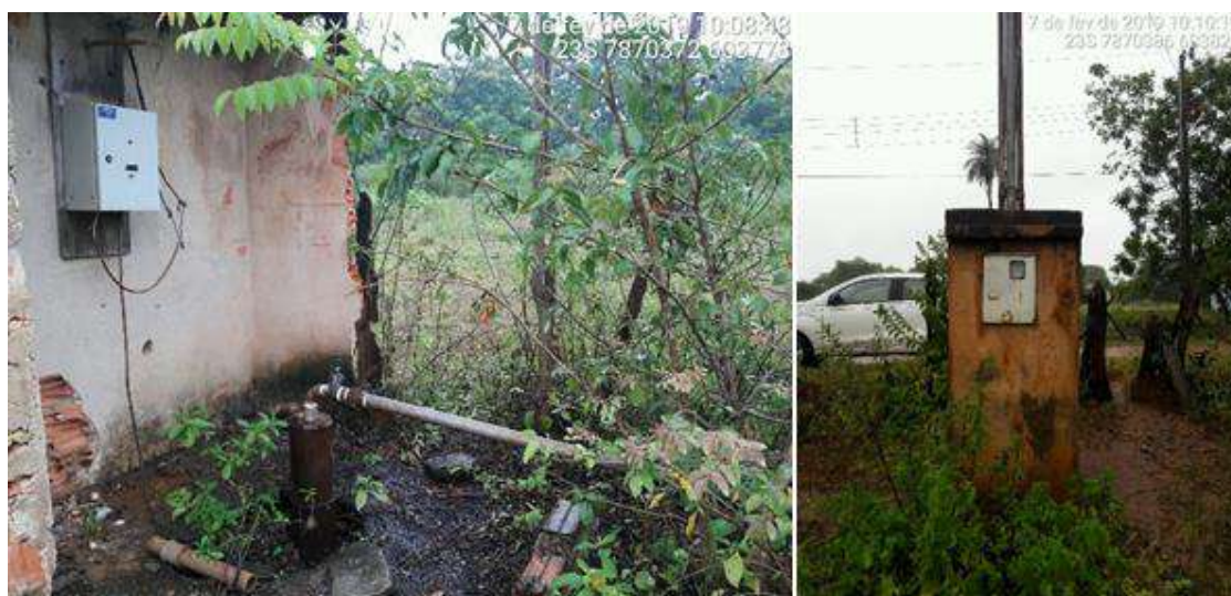
Figura 115 – Poço e padrão de energia em Lagoa Santo Antônio Fonte: Seletiva Consultoria e Projetos, 2019.
