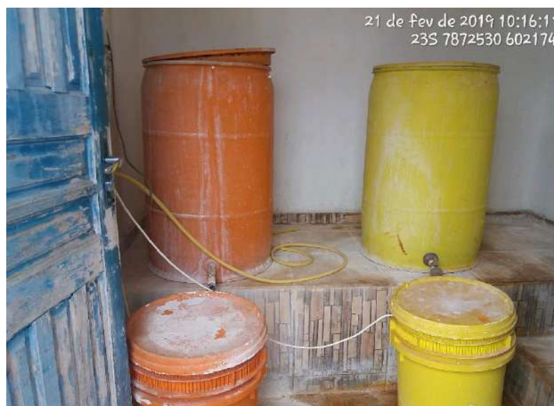
Figura 98 – Bombonas para dosagem de cloro e flúor Fonte: Seletiva Consultoria e Projetos, 2019.
