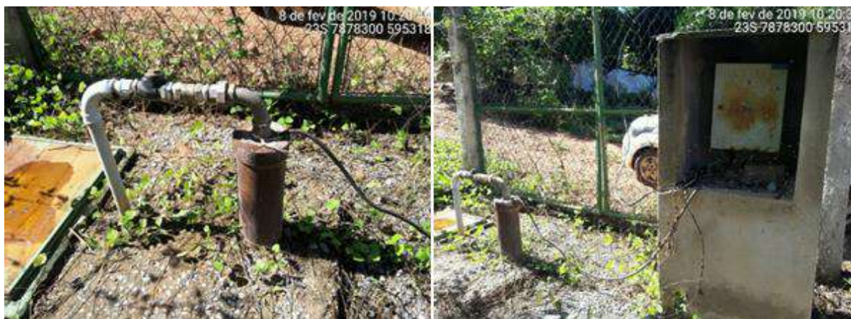
Figura 125 – Poço e padrão de energia em Coqueiros
