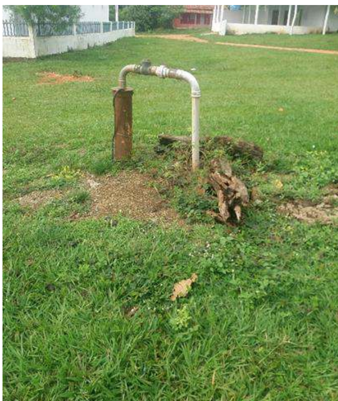
Figura 107 – Poço em Vargem Formosa Fonte: Seletiva Consultoria e Projetos, 2019.
