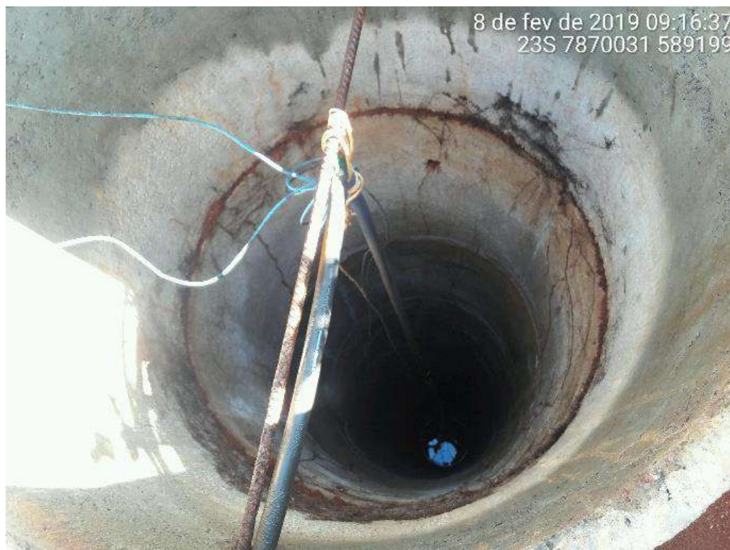
Figura 144 – Cisterna comunitária em Muchila Fonte: Seletiva Consultoria e Projetos, 2019.
