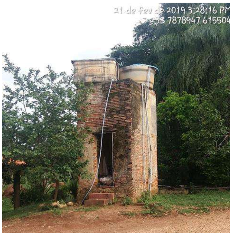
Figura 111 – Reservatórios de amianto em residência de Raiz Fonte: Seletiva Consultoria e Projetos, 2019.
