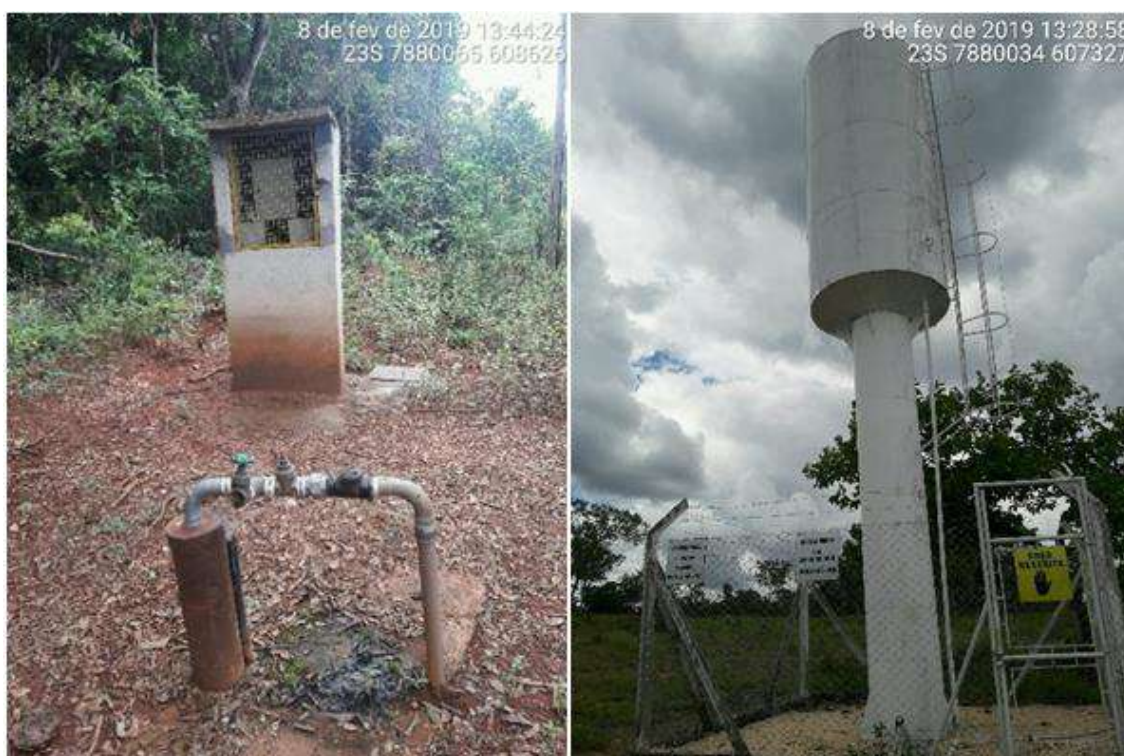
Figura 132 – Área do poço artesiano e reservatório em Onça Fonte: Seletiva Consultoria e Projetos, 2019.
