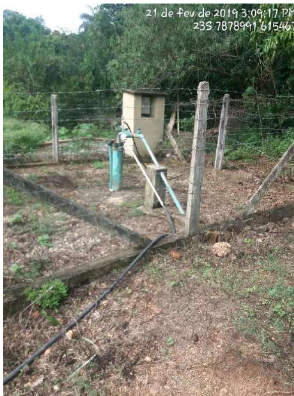
Figura 109 – Poço em Raiz Fonte: Seletiva Consultoria e Projetos, 2019.
