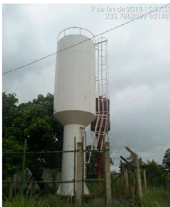
Figura 122 – Reservatório em Campo Alegre Fonte: Seletiva Consultoria e Projetos, 2019.
