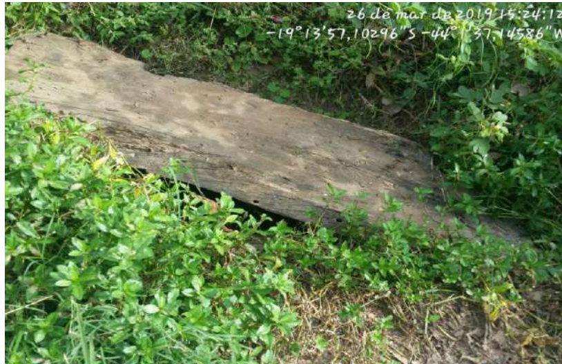
Figura 213 – Caixa de passagem das águas excedentes da Lagoa Pedro Saturnino
