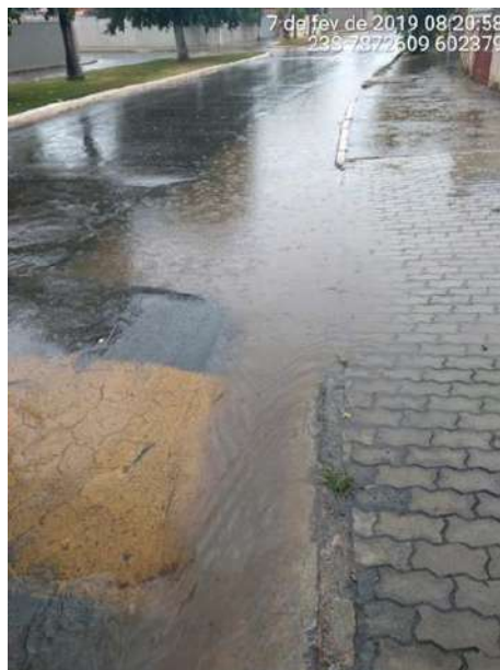
Figura 240 – Ponto de Alagamento na Rua Raimundo Ribeiro da Silva - Sede Fonte: Seletiva Consultoria e Projetos, 2019.
