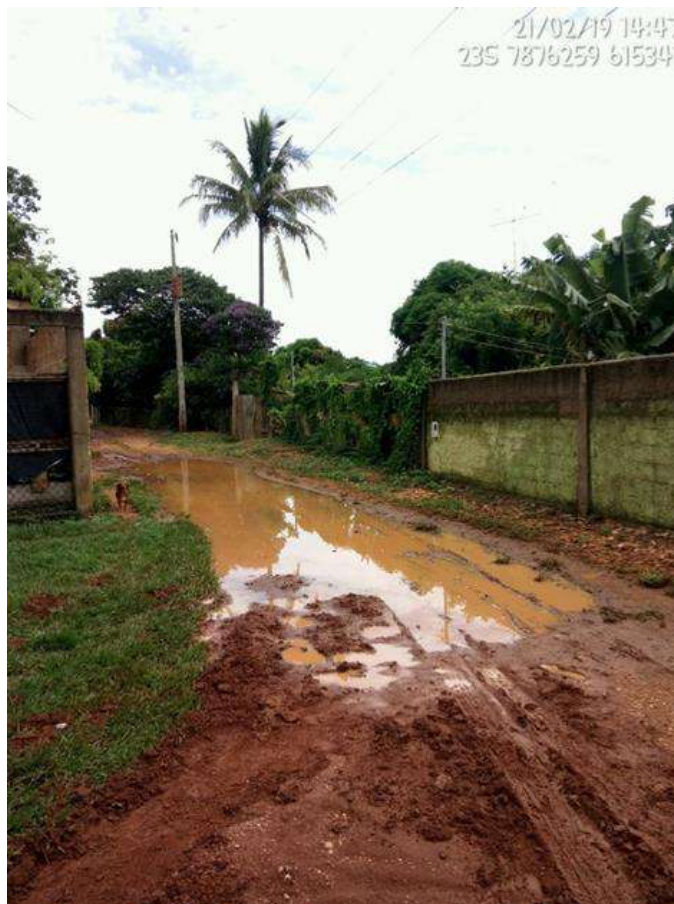
Figura 246 – Ponto de alagamento - Localidade de Vargem Formosa Fonte: Seletiva Consultoria e Projetos, 2019.
