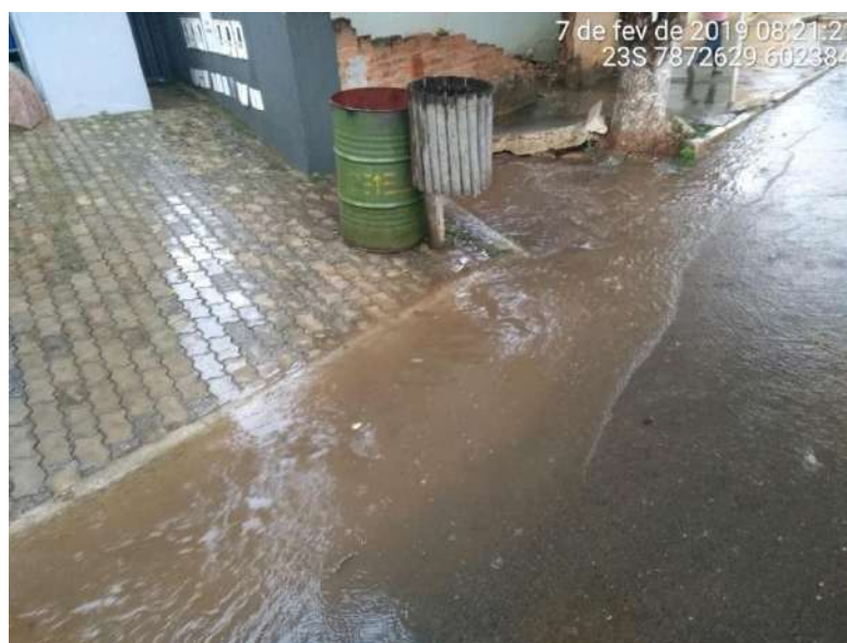
Figura 241 – Ponto de Alagamento na Rua Raimundo Ribeiro da Silva - Sede Fonte: Seletiva Consultoria e Projetos, 2019.
