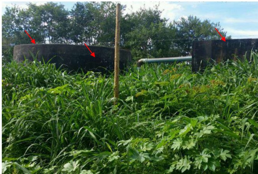
Figura 151 – Fissuras nas estruturas de alvenaria
