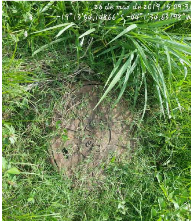
Figura 149 – Poço de visita Fonte: Seletiva Consultoria e Projetos, 2019.
