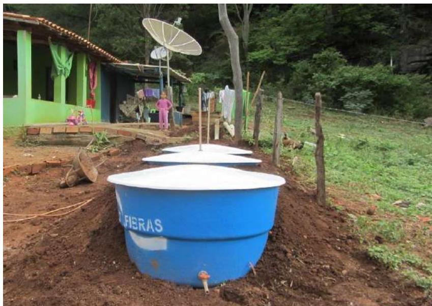
Figura 170 – Fossa séptica biodigestora em Peróbas Fonte: Projeto Barraginhas, 2015.
