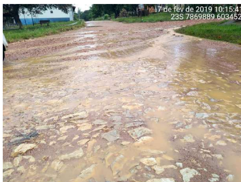
Figura 243 – Ponto de alagamento na Rua Pedro Saturnino - Comunidade de Lagoa Santo Antônio
