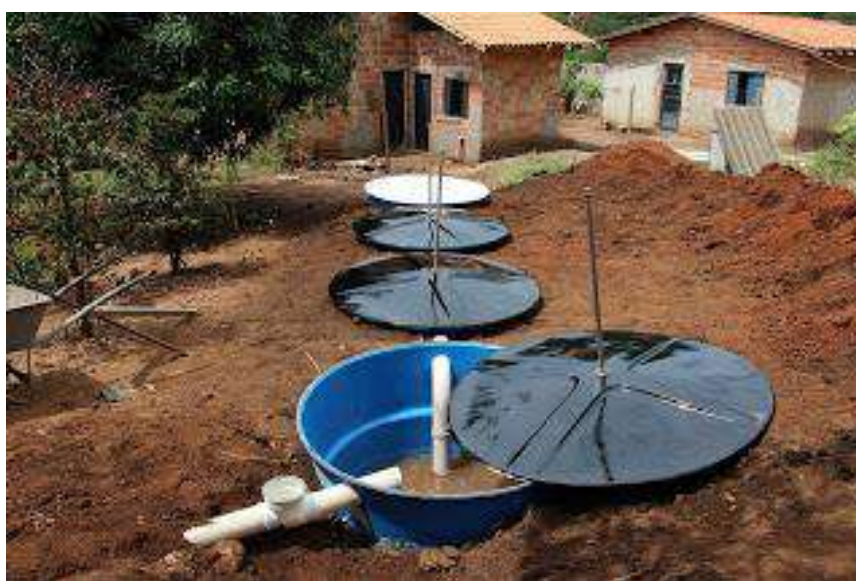
Figura 171 – Fossa séptica biodigestora em Peróbas Fonte: Projeto Barraginhas, 2015.
