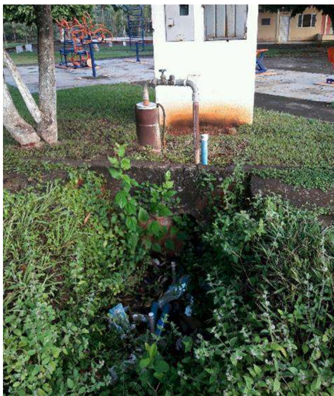
Figura 127 – Poço e padrão de energia em Vargem Bonita Fonte: Seletiva Consultoria e Projetos, 2019.
