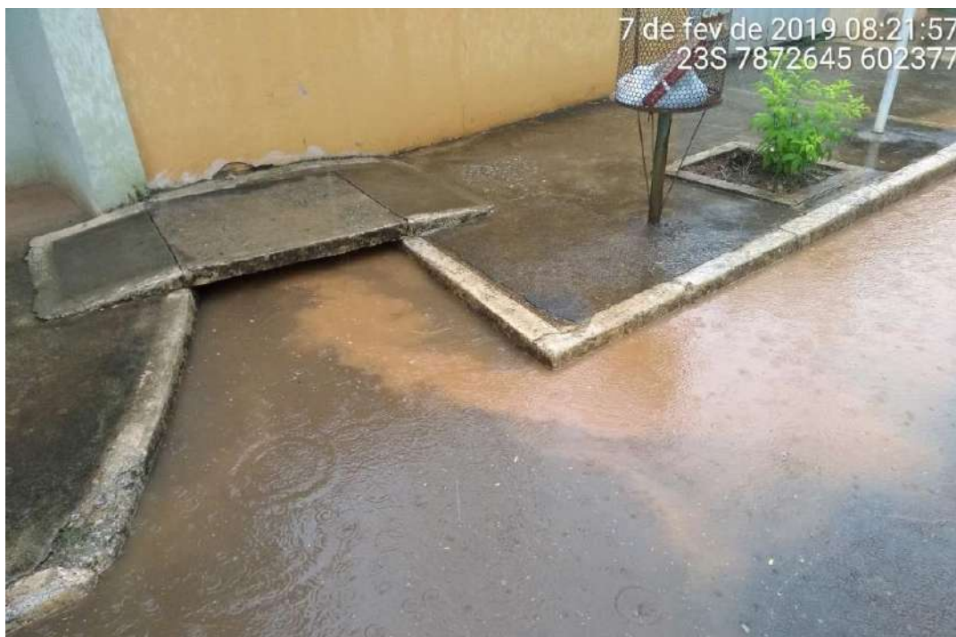
Figura 206 – Boca de lobo mal dimensionada na Rua Raimundo Ribeiro da Silva
