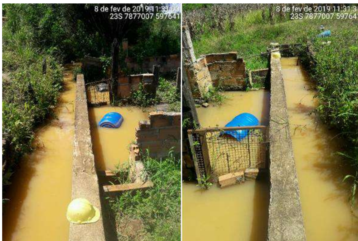
Figura 145 – Captação superficial em Barreiros Fonte: Seletiva Consultoria e Projetos, 2019.
