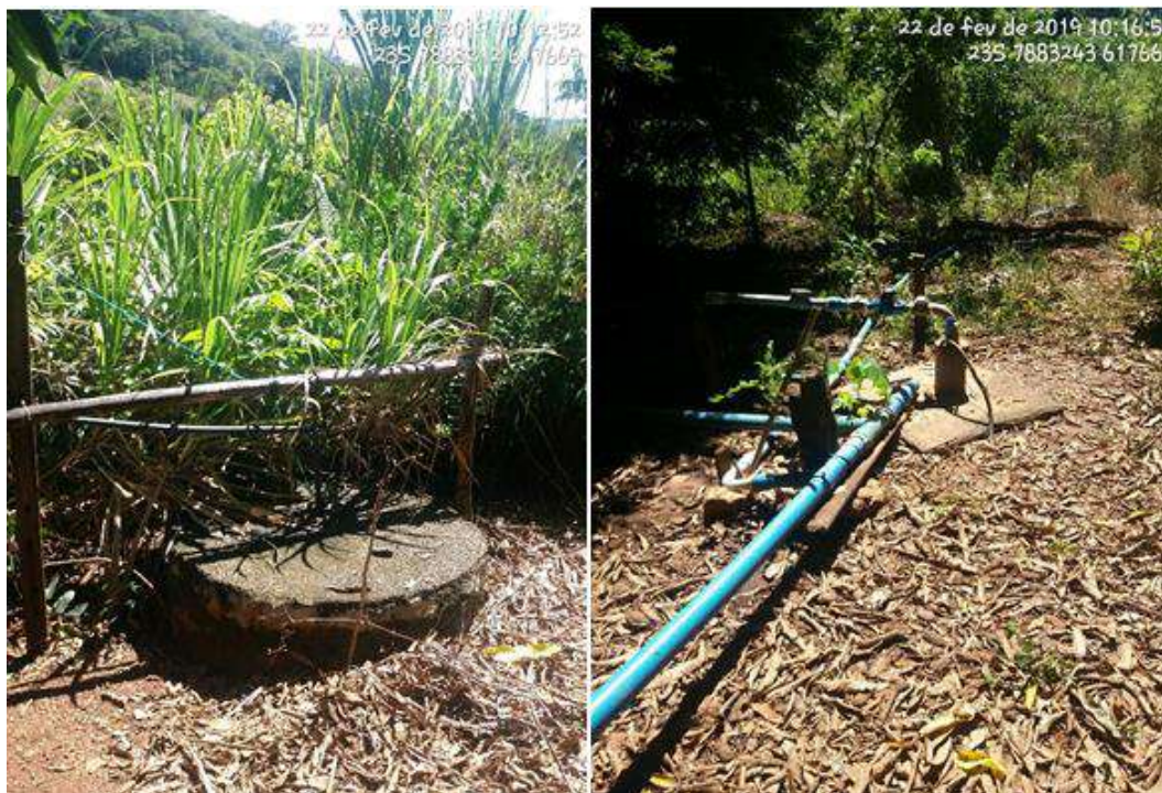
Figura 143 – Cisterna e poço artesiano em residência da localidade de Lapa Fonte: Seletiva Consultoria e Projetos, 2019.
