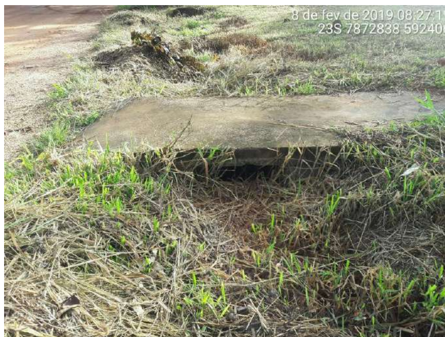
Figura 158 – Fossa rudimentar em Vargem Bonita Fonte: Prefeitura Municipal, 2019.
