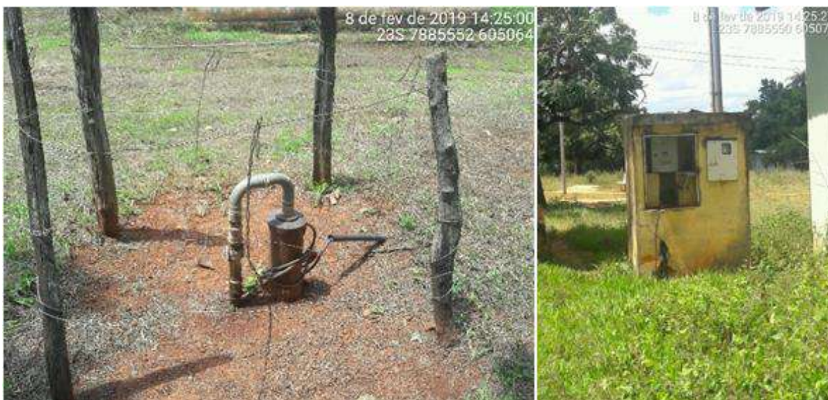
Figura 133 – Poço e padrão de energia em Bebedouro
