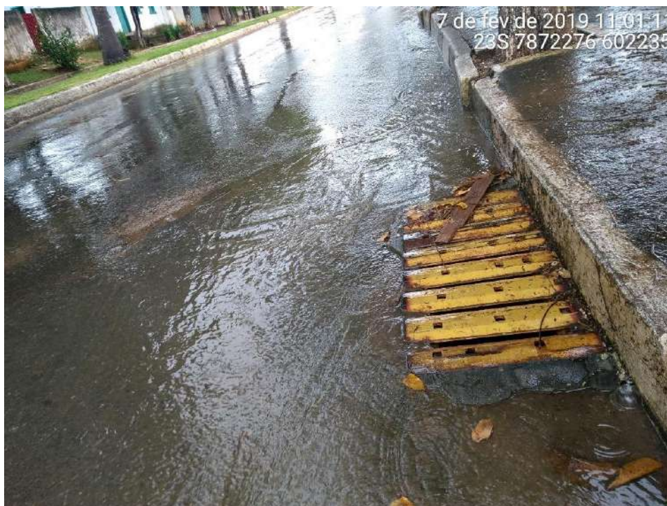
Figura 204 – Boca de lobo localizada na Rua Raimundo Ribeiro da Silva Fonte: Seletiva Consultoria e Projetos, 2019.
