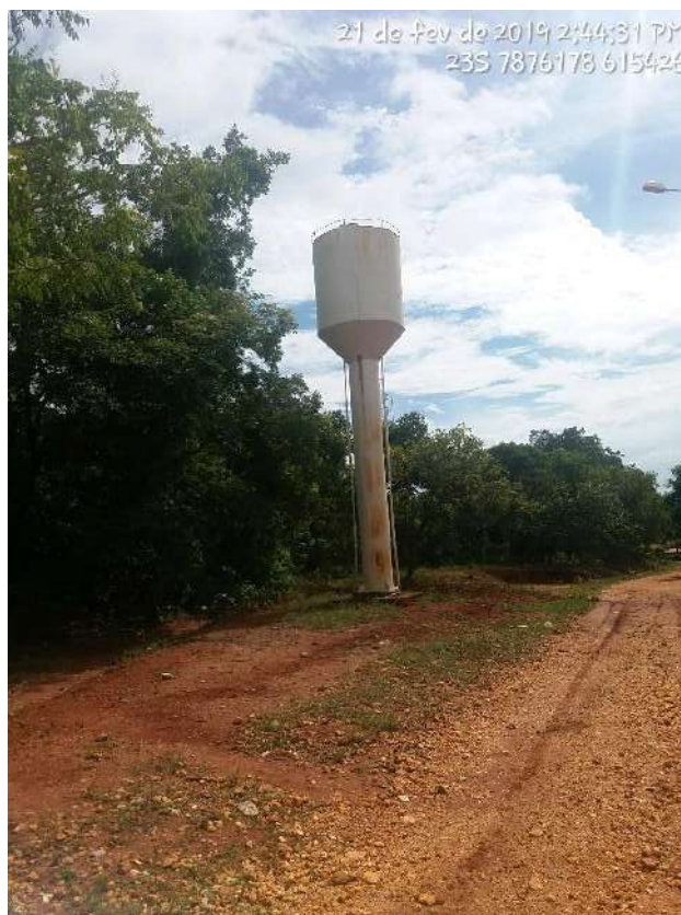
Figura 108 – Reservatório em Vargem Formosa Fonte: Seletiva Consultoria e Projetos, 2019.
