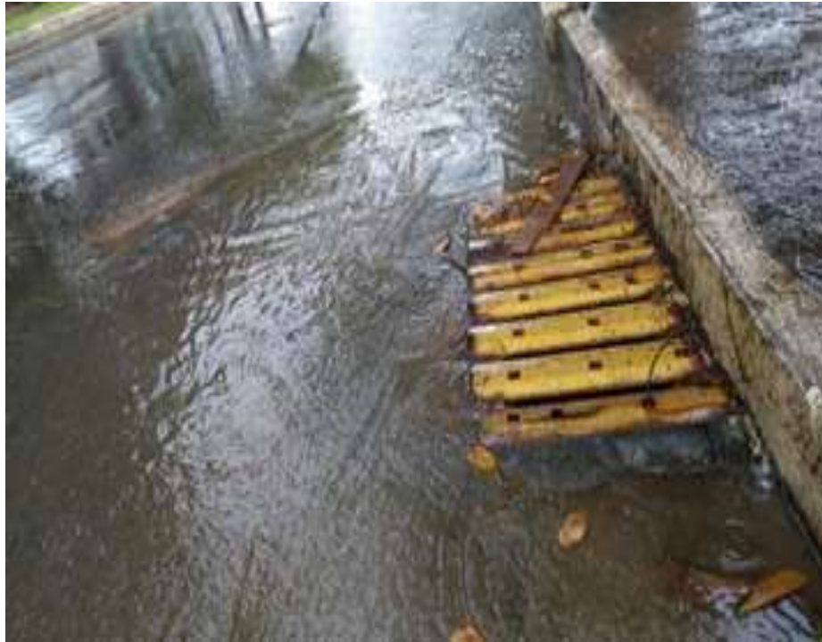
Figura 12: Estrutura Deficitária de Drenagem Encontrada no Município Fonte: Prefeitura de Jequitibá, 2019
