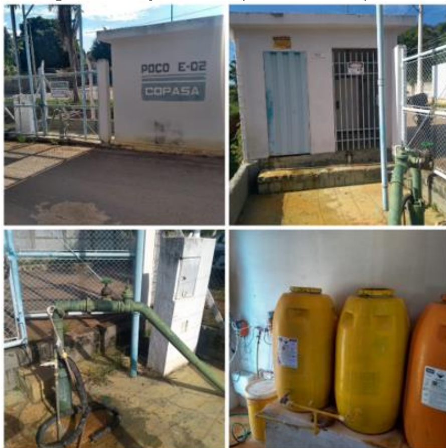
Figura 06 – Poço E-02 e respectiva casa de química
