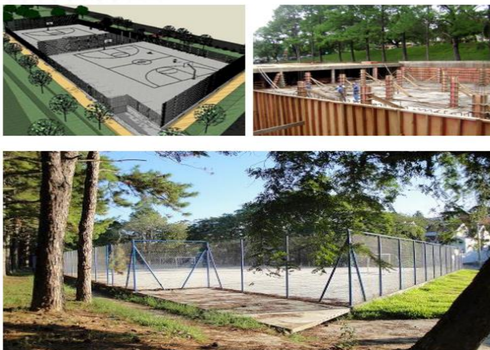
Figura 17: Reservatório de detenção fechado, construído em Porto Alegre - RS
