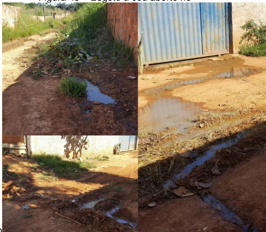
Figura 45 – Esgoto à céu aberto no
