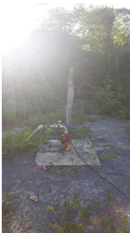
Figura 9.42 – Poço Tubular 3 - Santa Maria
