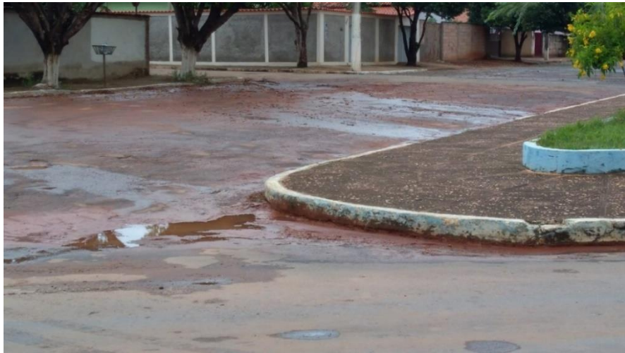
Figura 12.9 – Acúmulo de sedimentos nas ruas do centro
