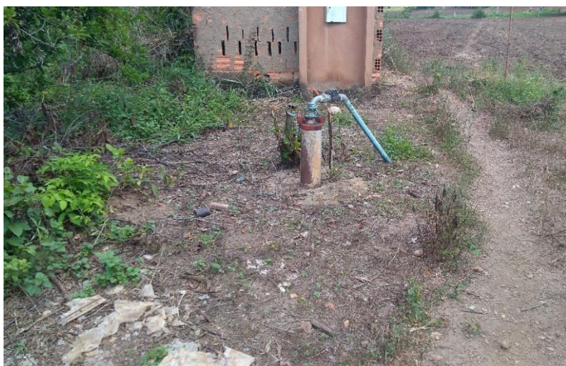
Figura 9.49 – Poço tubular 2 - Boqueirão
