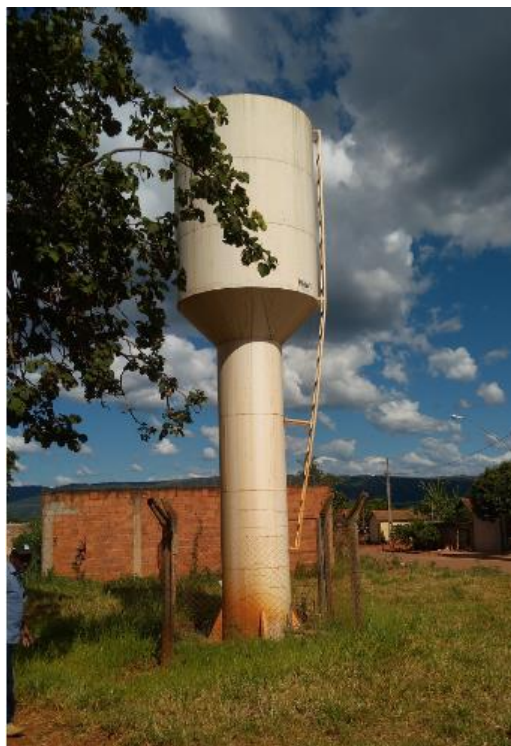
Figura 9.30 – Reservatório elevado - Sede
