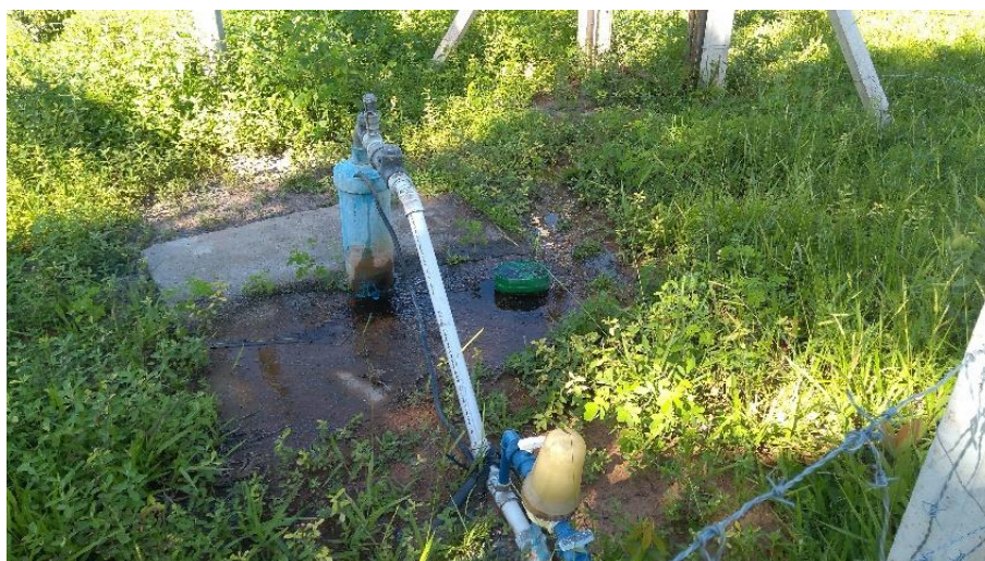
Figura 9.56 – Poço tubular 1 - Morada Nova
