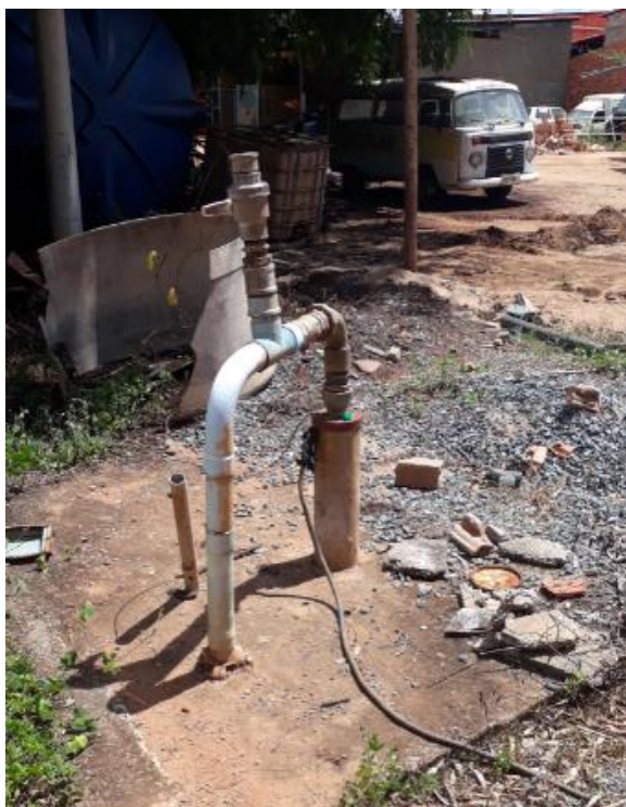
Figura 9.6 – Poço 02 - Sede (localizado ao lado do escritório do SAAE)
