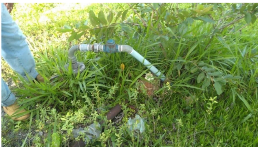
Figura 9.43 – Poço Tubular 4 - Santa Maria
