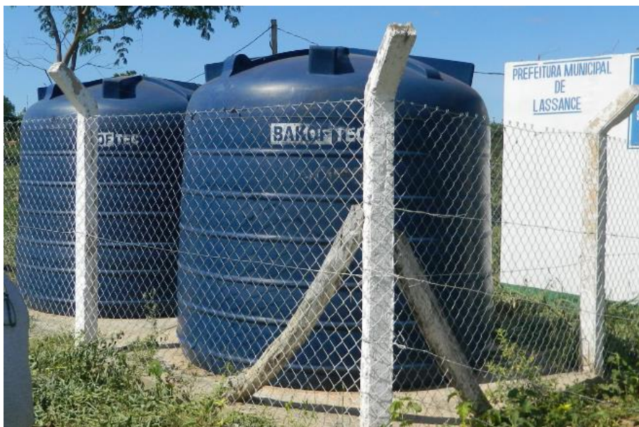
Figura 9.33 – Reservatório apoiado setor 3 - Brejo
