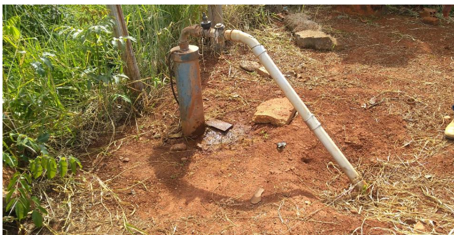
Figura 9.10 – Poço 07 (poço que abastece Nova Lassance)
