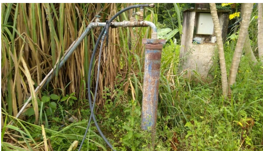
Figura 9.46 – Poço Tubular 7 - Santa Maria
