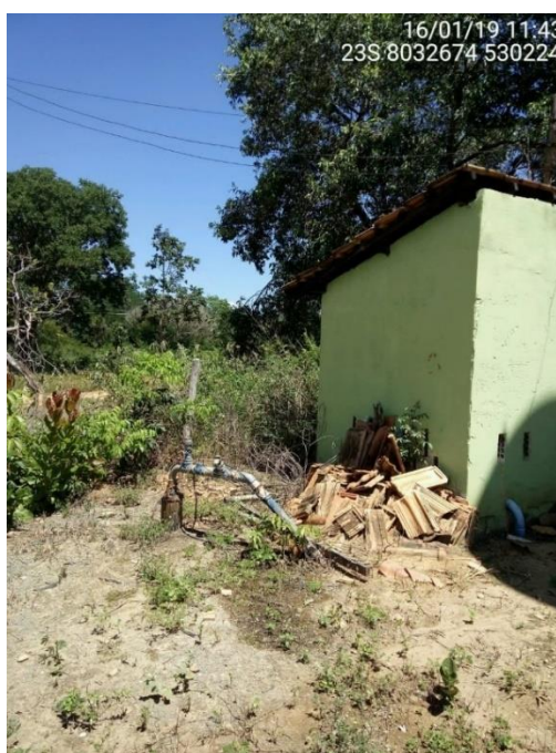
Figura 9.53 – Poço tubular 2 - Palmeiras
