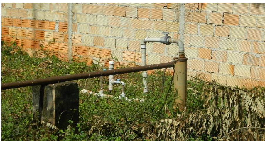
Figura 9.16 – Poço 01 - Brejo (próximo ao Posto de Saúde)
