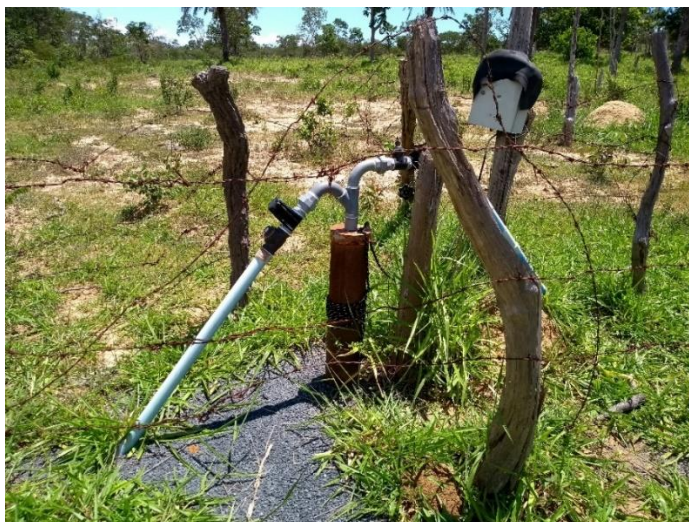
Figura 9.59 – Poço tubular - Lavadinho
