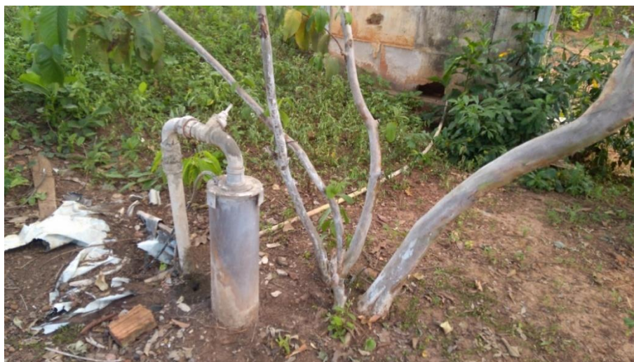
Figura 9.50 – Poço tubular 3 - Boqueirão
