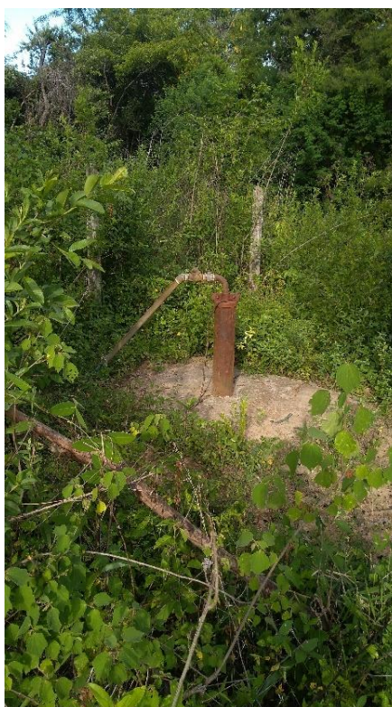
Figura 9.41 – Poço Tubular 2 - Santa Maria
