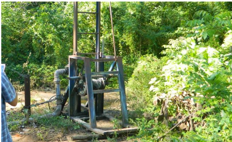
Figura 9.9 – Poço 02 - Sede (entorno do poço artesiano)
