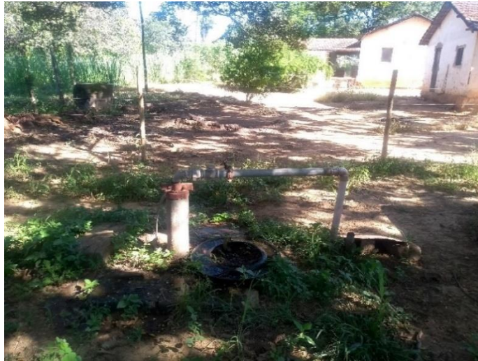
Figura 9.61 – Poço tubular 1 - Onça
