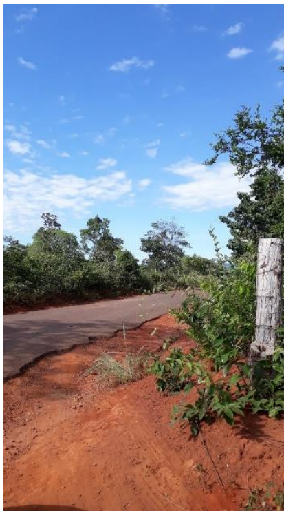
Figura 12.16 – Problemas de pavimentação na estrada de acesso - Brejo
