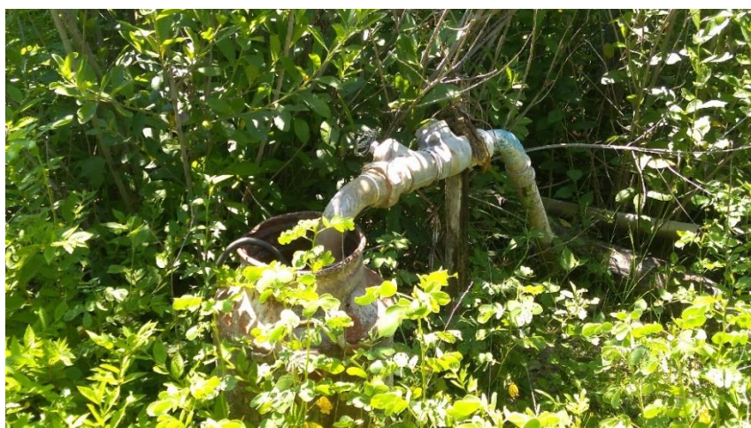
Figura 9.52 – Poço tubular 1 - Palmeiras
