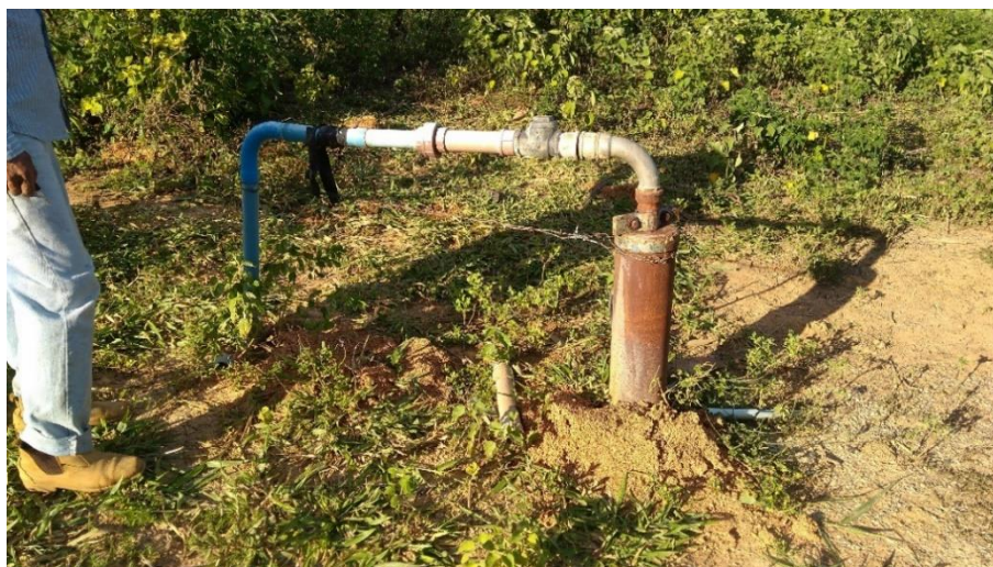
Figura 9.40 – Poço Tubular 1 - Santa Maria
