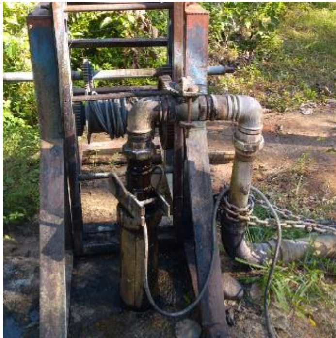
Figura 9.8 – Poço 05 - Sede (localizado em um terreno atrás da ETA)
