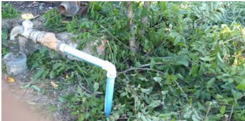
Figura 9.22 – Poço 04 - Brejo (Poço alugado pelo SAAE)
