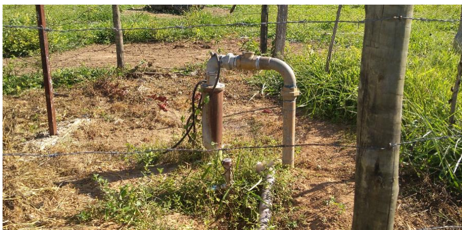
Figura 9.12 – Poço Sr. Osmar - Sede
