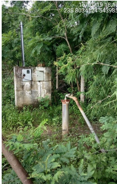
Figura 9.55 – Poço tubular 2 - Tira Barro
