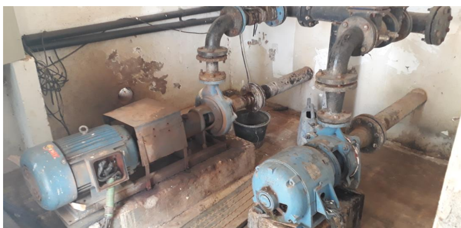
Figura 9.26 – Estação elevatória de água tratada
