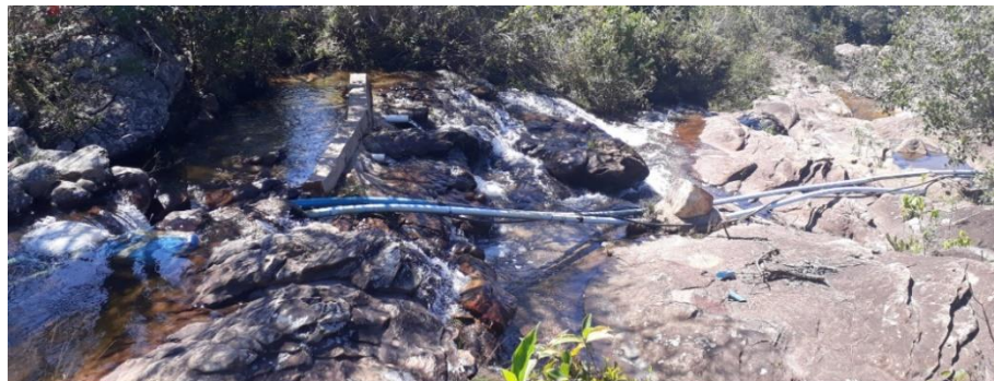
Figura 9.29 – Captação Superficial Tombadouro - Foto 2
