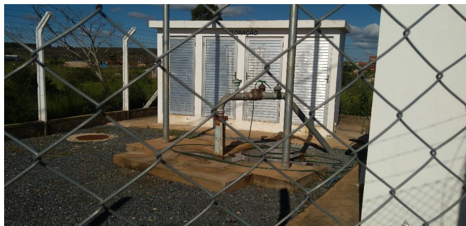
Figura 9.9 – Proteção poço artesiano C-01 (sede)
