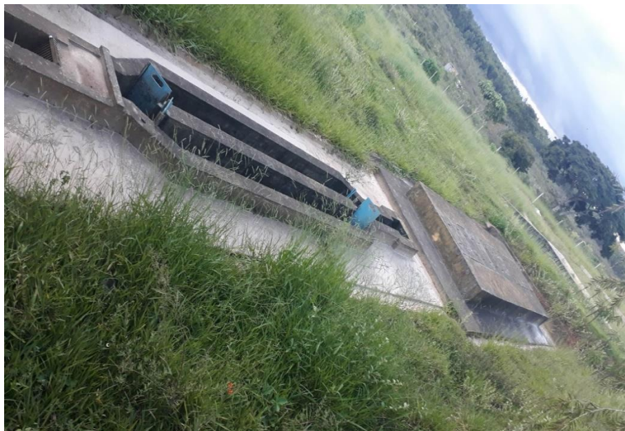
Figura 10.8 – Tratamento Preliminar – Desarenadores
