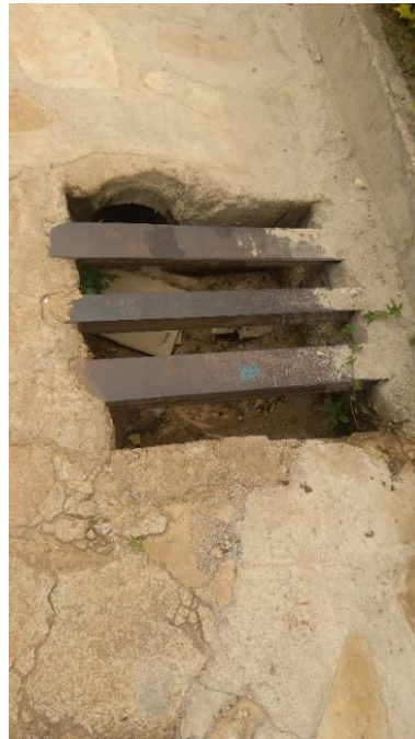
Figura 12.13 – Boca de Lobo em Cachimbos
