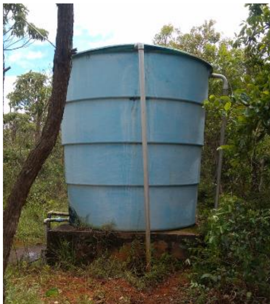
Figura 9.47 – Reservatório apoiado - Palmital
