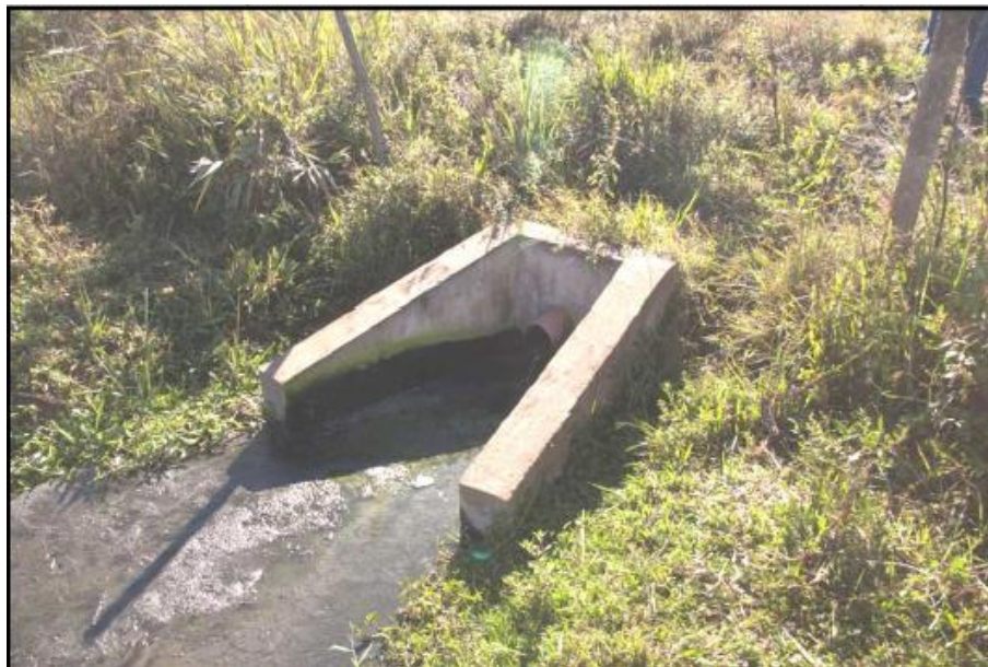
Figura 10.12 – Ala de lançamento do efluente tratado
