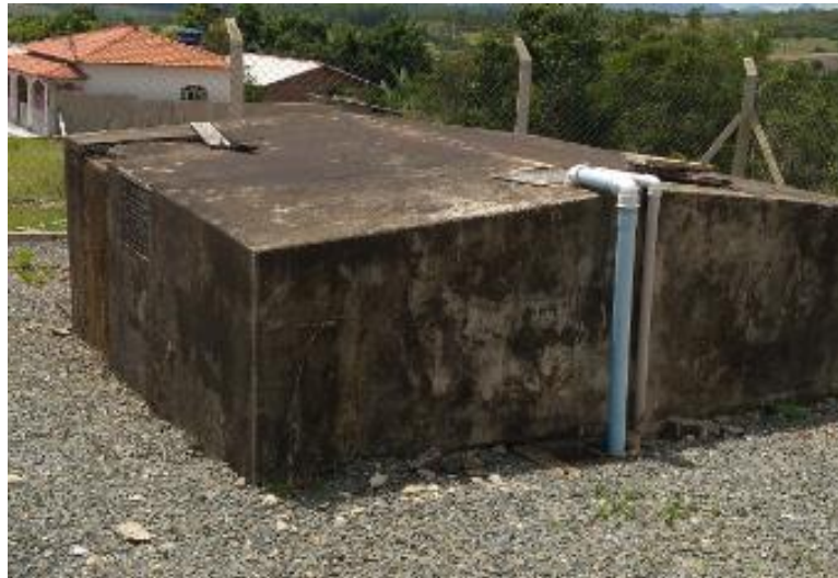
Figura 9.40 – Reservatório semienterrado - Tombadouro
