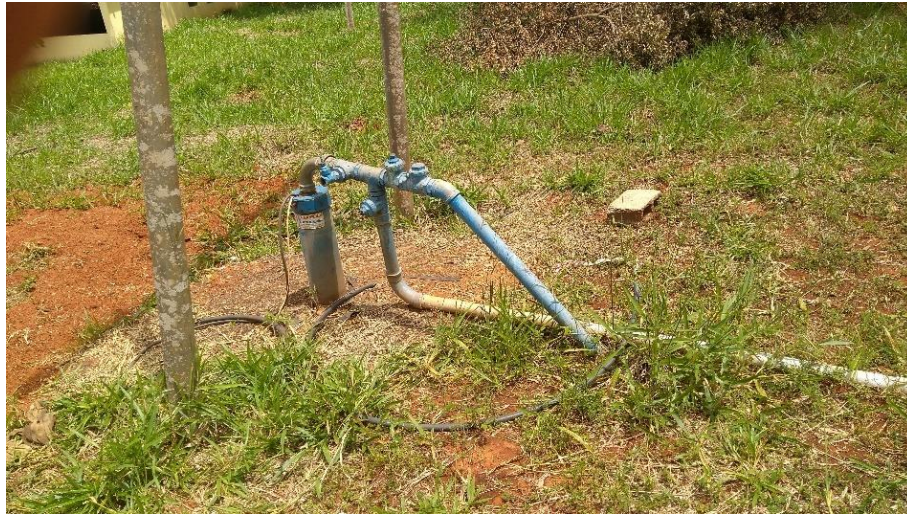
Figura 9.38 – Poço vazão 0.50 L/s – Palmital
