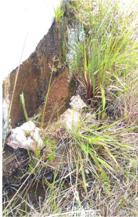
Figura 9.50 – Vazamento no reservatório apoiado de Cubas
