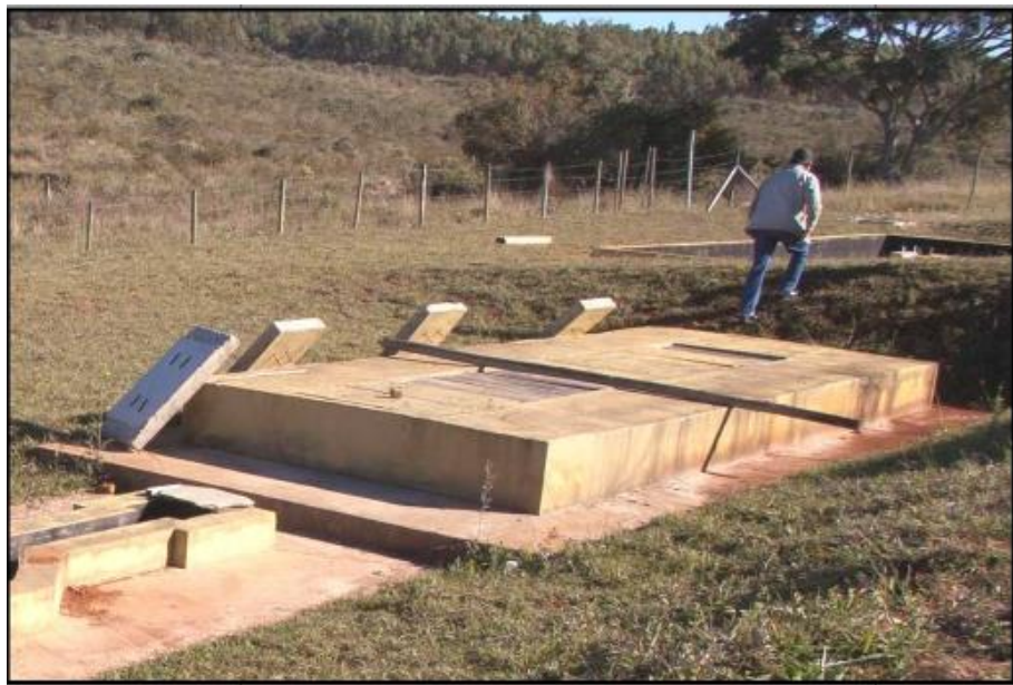
Figura 10.5 – Estação Elevatória de Esgoto – 02
