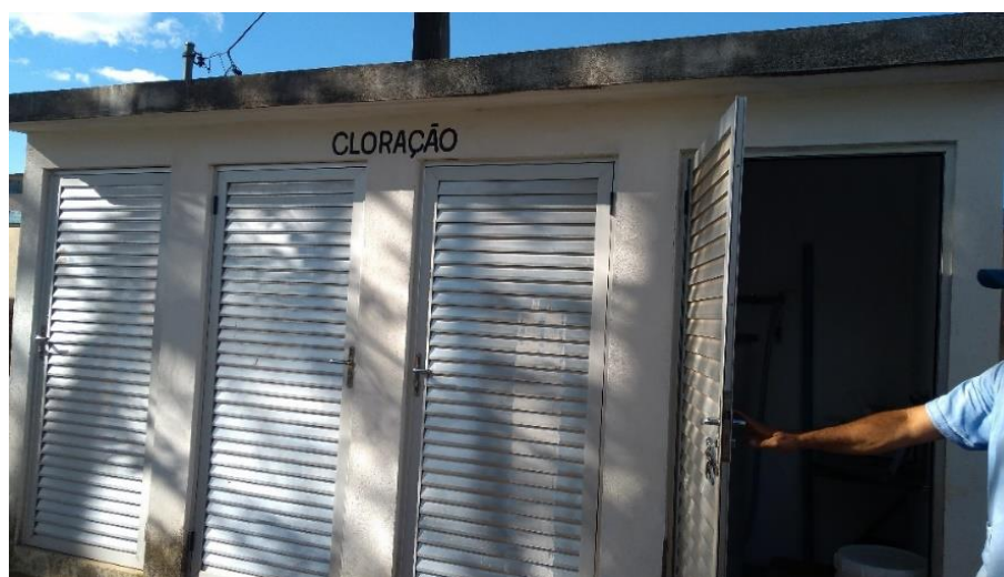
Figura 9.14 – Unidade de Tratamento
