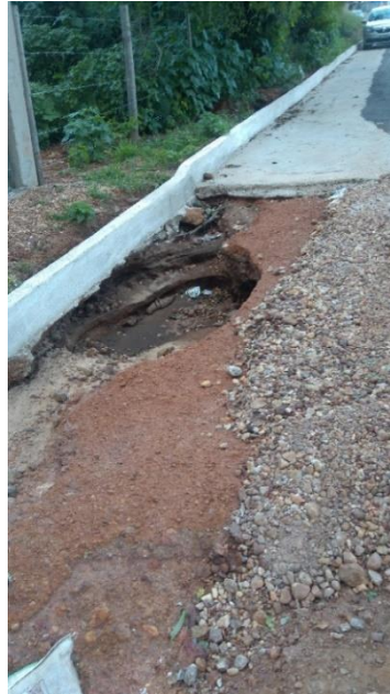
Figura 12.15 – Fim do asfalto e problemas na rua Florêncio Marques (Ponto 2) - Próximo à ETE
