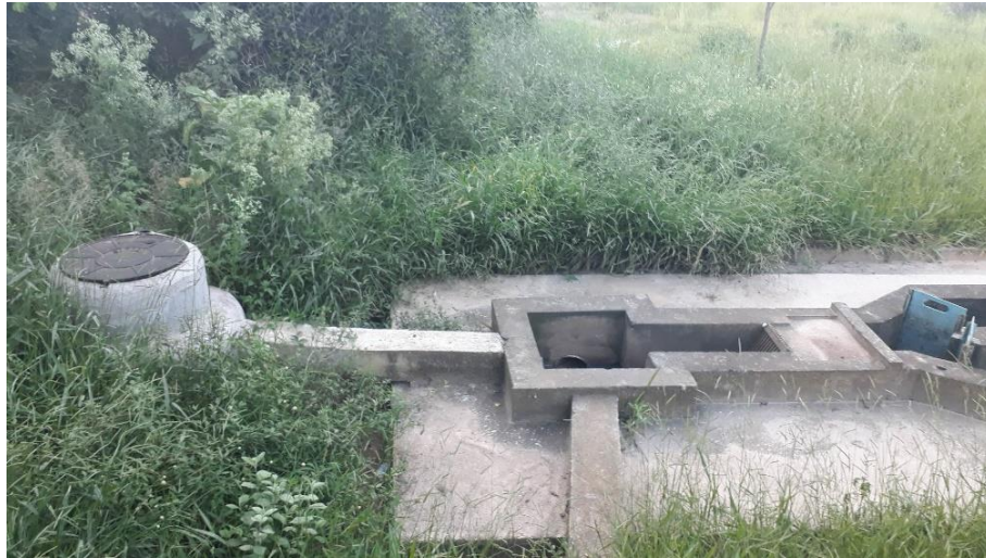
Figura 10.7 – Chegada do Tratamento Preliminar / Gradeamento
