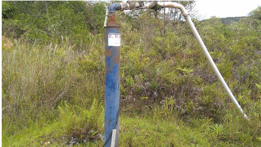
Figura 9.36 – Poço de captação - Poço Fundo
