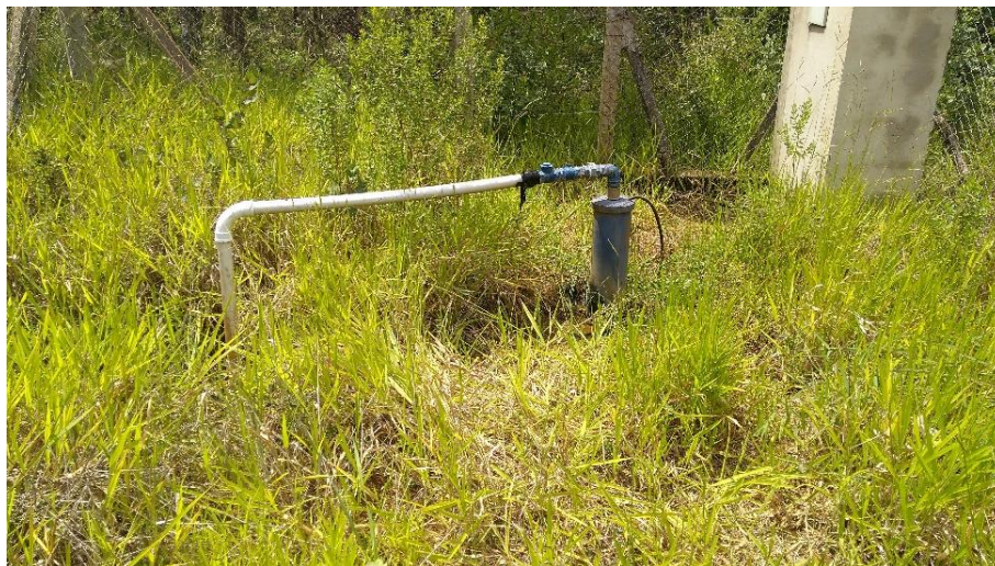
Figura 9.37 – Poço vazão 1.29 L/s – Palmital
