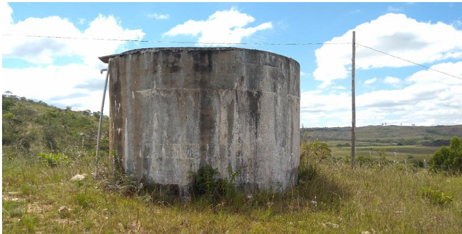
Figura 9.49 – Reservatório apoiado - Cubas
