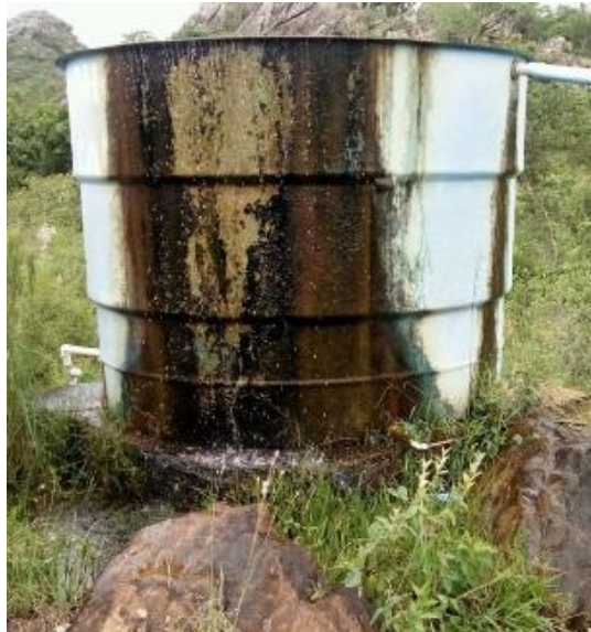
Figura 9.51 – Reservatório Fazenda Sta. Cruz
