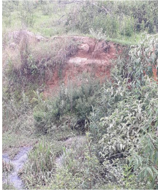
Figura 12.20 – Processo erosivo – Tombadouro
