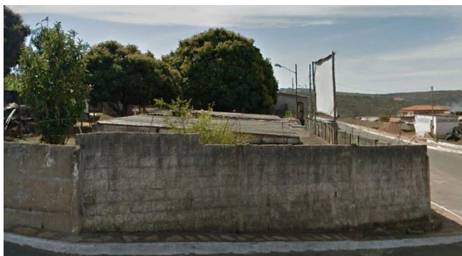
Figura 9.18 – Reservatório Semienterrado - 200 m 3
