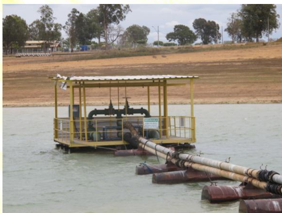
Figura 23 - Estação de Captação de Água – agosto de 2013
