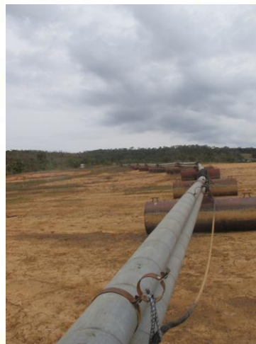
Figura 24 - Adutora de Água Bruta – agosto de 2013
