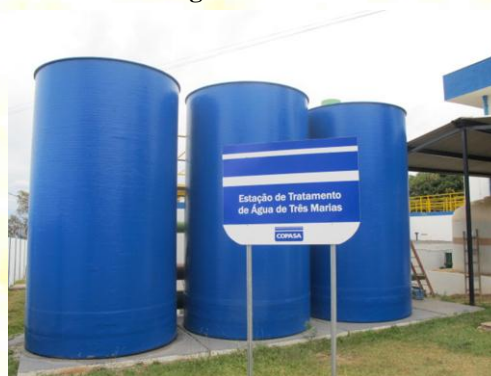
Figura 26 - Estação de Tratamento de Água – agosto de 2013
