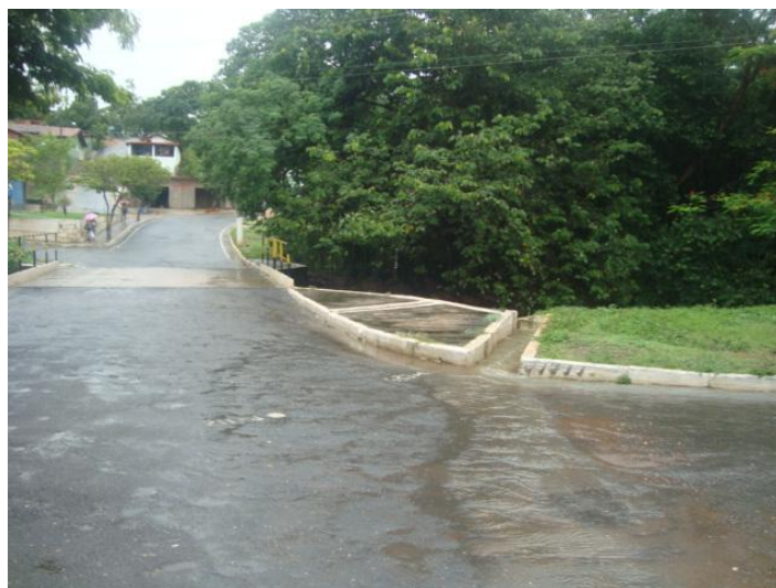
Figura 4.6 – Deficiência no sistema de microdrenagem – Sede do município
