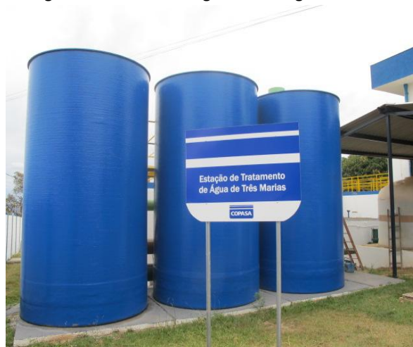
Figura 28- Estação de Tratamento de Água – agosto de 2013
