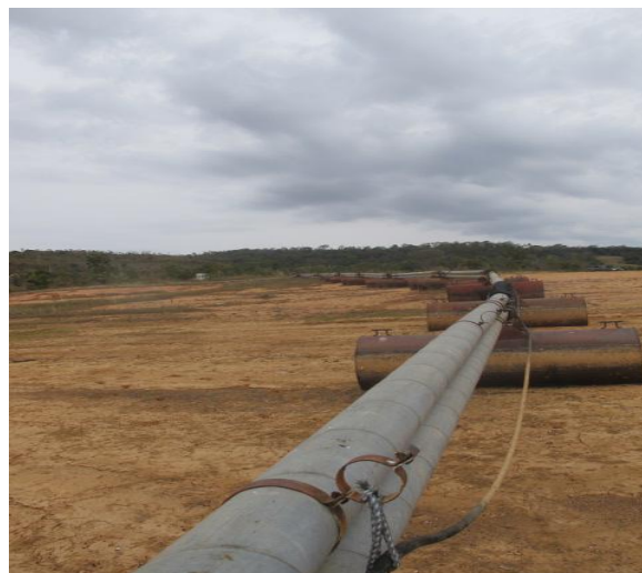
Figura 26 - Adutora de Água Bruta – agosto de 2013
