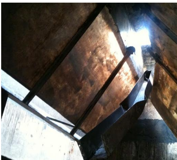
Figura 31 - Estação de Tratamento de Esgoto – agosto de 2013
