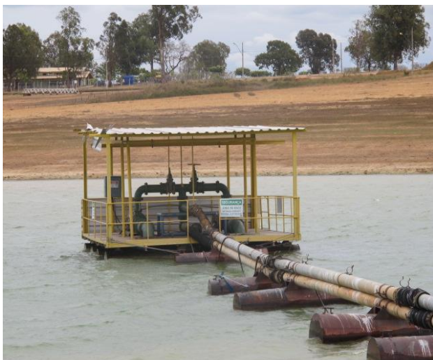
Figura 25 - Estação de Captação de Água – agosto de 2013
