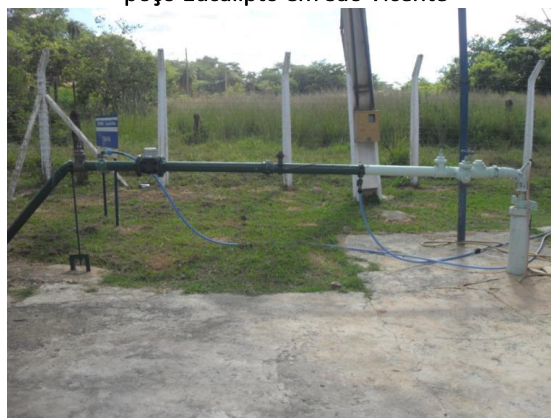
Figura 4.4 - Dosagem de cloro e flúor na adutora do poço Eucalipto em São Vicente
