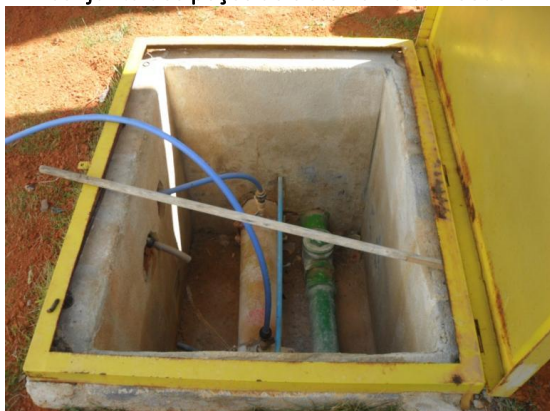
Figura 4.3 - Aplicação de cloro e flúor na adutora conjunta dos poços do sistema Baldim Sede
