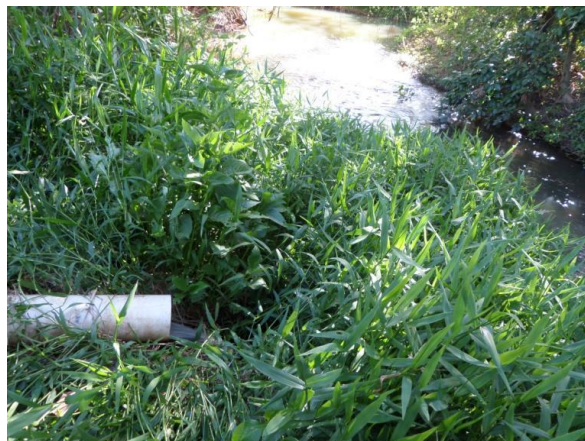
Figura 4.8 – Principal lançamento de esgoto de São Vicente
