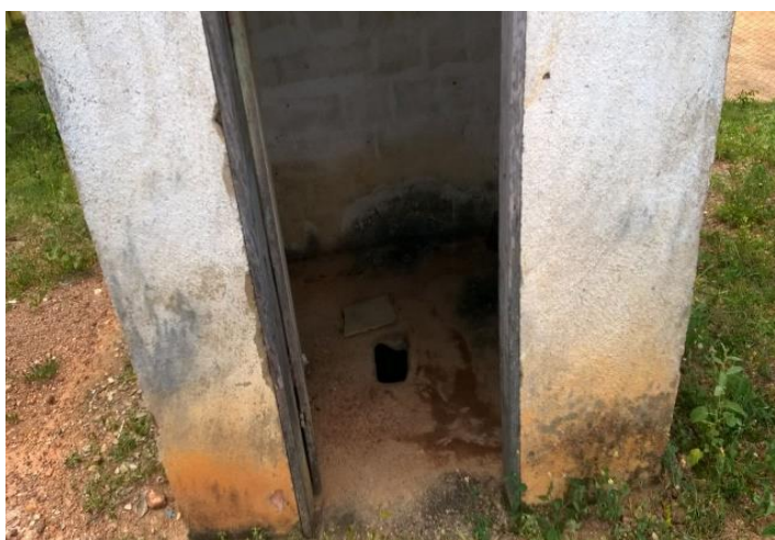
Figura 20: Fossa rudimentar - Comunidade Barra das Canoas Prefeitura Municipal de Cordisburgo, 2015
