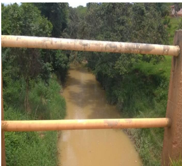
Figura 27: Macro drenagem de Cordisburgo
