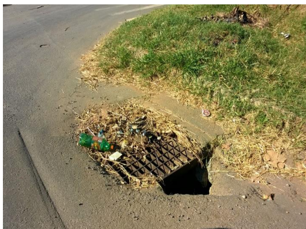
Figura 26: Boca de lobo com acúmulo de lixo Fonte: Prefeitura Municipal de Cordisburgo, 2015
