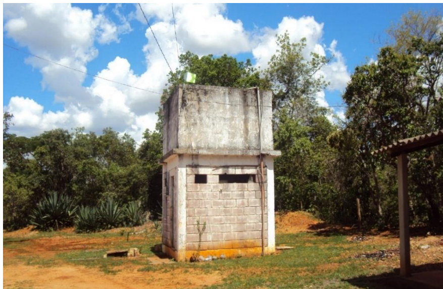
Figura 9: Reservatório de água - Carvalho de Almeida Fonte: Prefeitura Municipal de Araçáí, 2015
