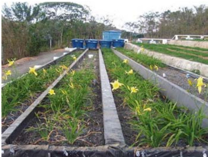
Figura 26: Tratamento de esgoto sanitário em sistemas alagados construídos cultivados com lírio amarelo
