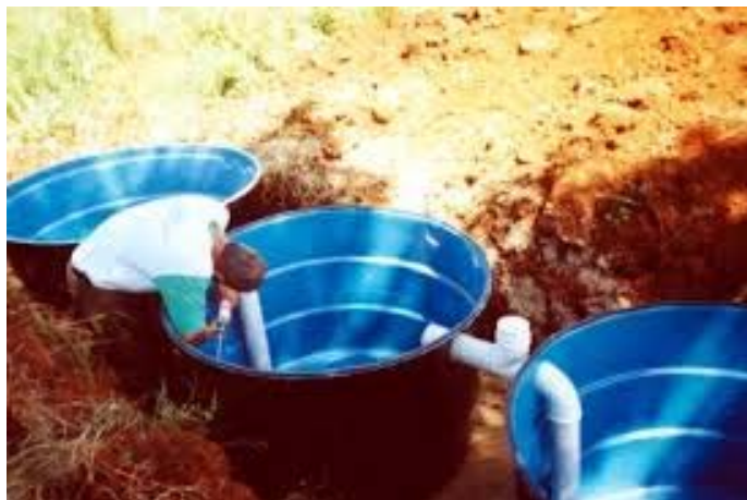
Figura 25: Fossa Séptica Fonte: Emater, 2014
