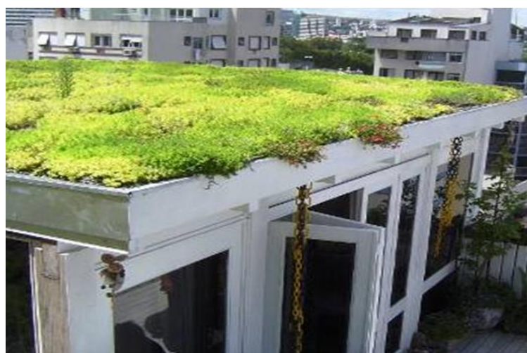
Figura 37: Telhado verde Fonte: MCidades, 2014
