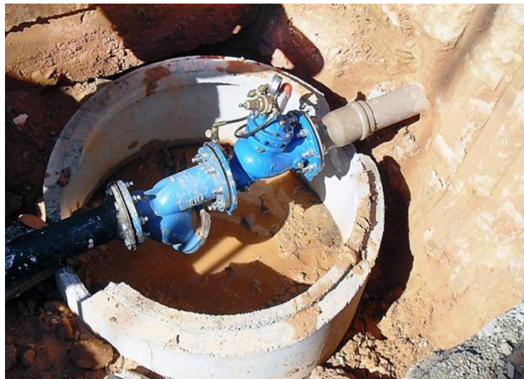
Figura : Válvula redutora de pressão
