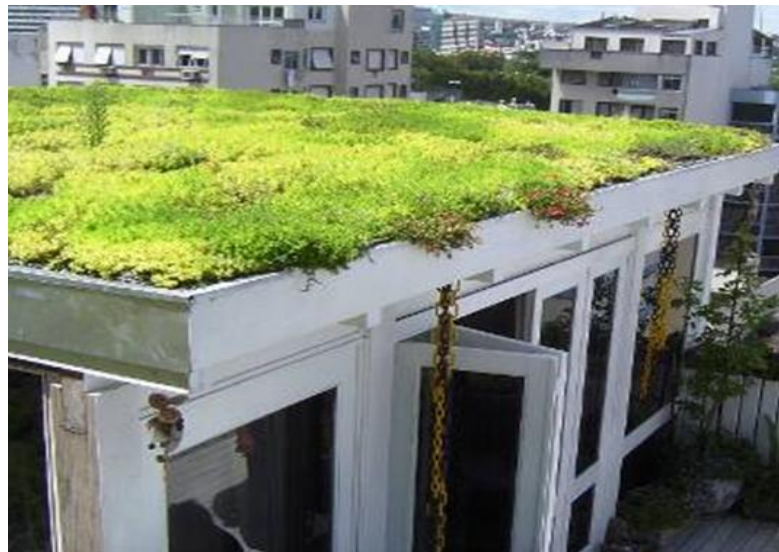
Figura : Telhado verde Fonte: MCidades, 2014
