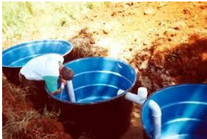
Figura 29: Fossa Séptica Fonte: Emater, 2014
