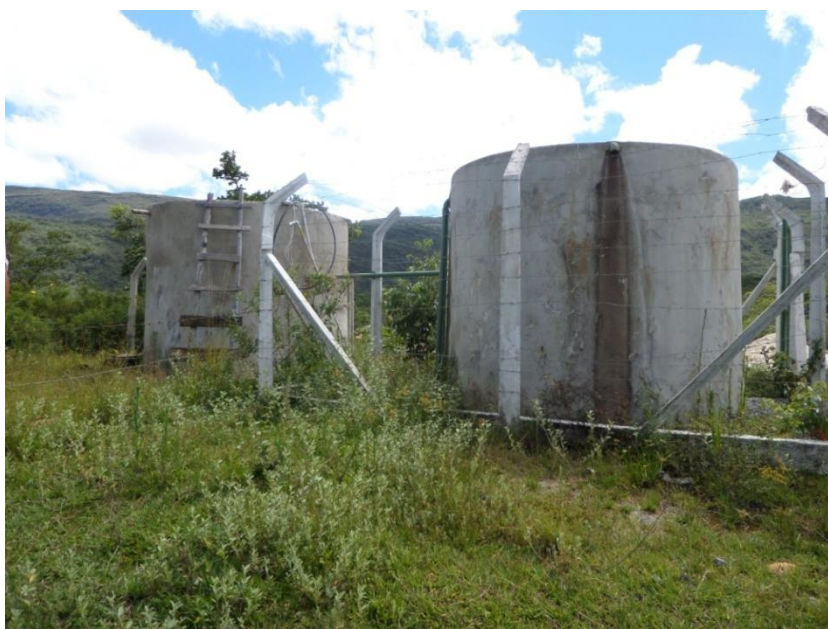
Figura 7.56 – Reservatórios R2 e R3 de 15m 3 + sistema de filtragem
