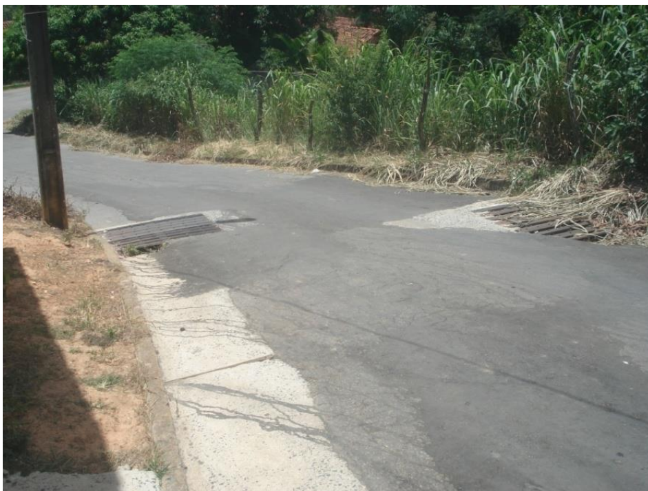
Figura 7.147 - Grelhas de captação de águas pluviais – Rua São Joaquim
