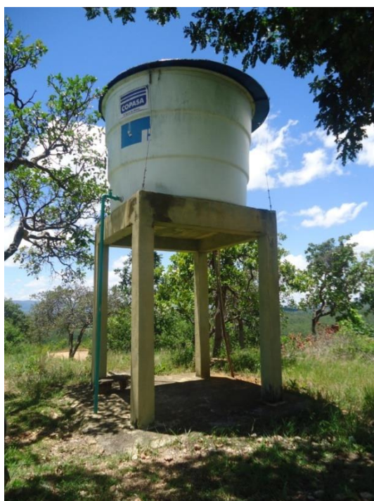
Figura 7.83 – Reservatório Santa Bárbara (10m 3 )
