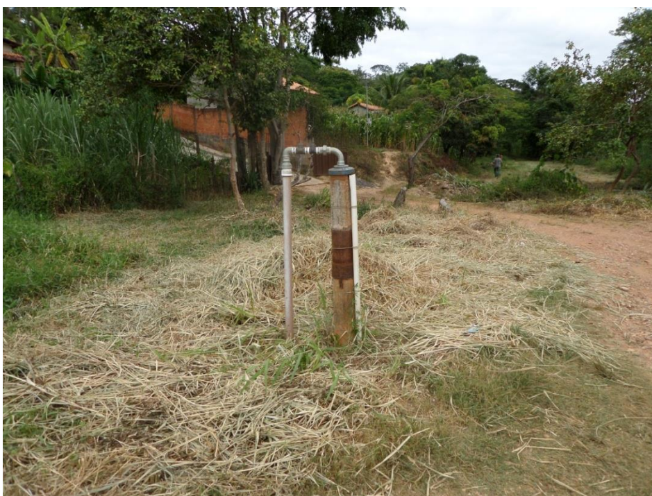
Figura 7.46 – Poço artesiano (P4) para abastecimento da sede municipal
