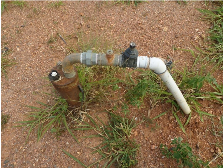
Figura 7.49 – Poço artesiano (P7) para abastecimento da sede municipal
