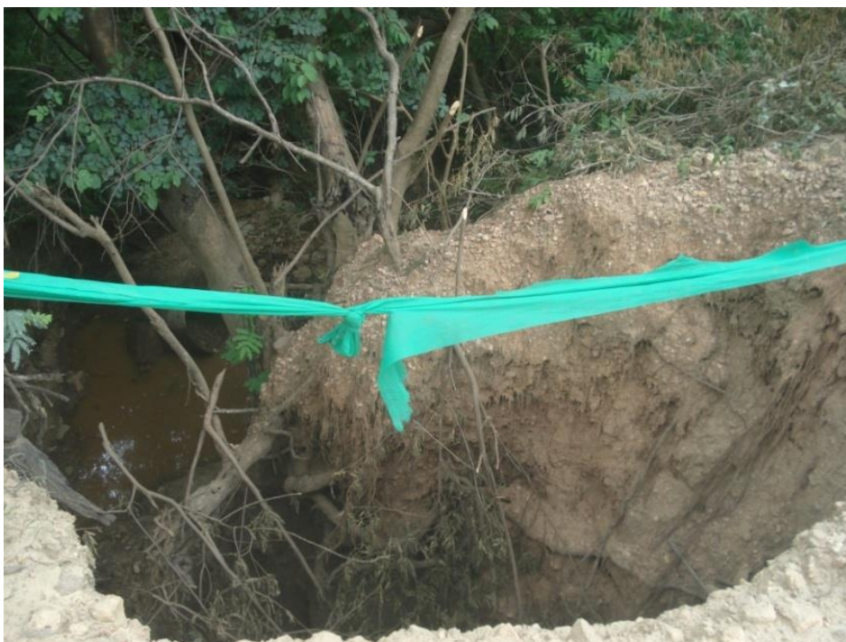
Indicação da margem da via danificada
