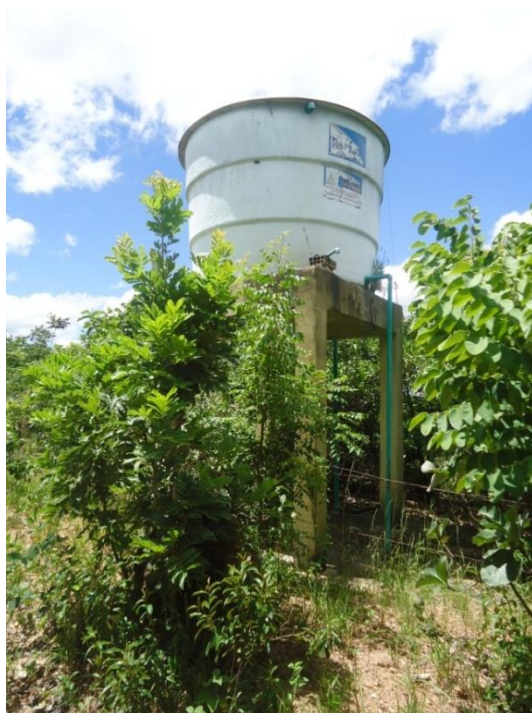
Figura 7.78 – Reservatório Formigueiro (10m 3 )
