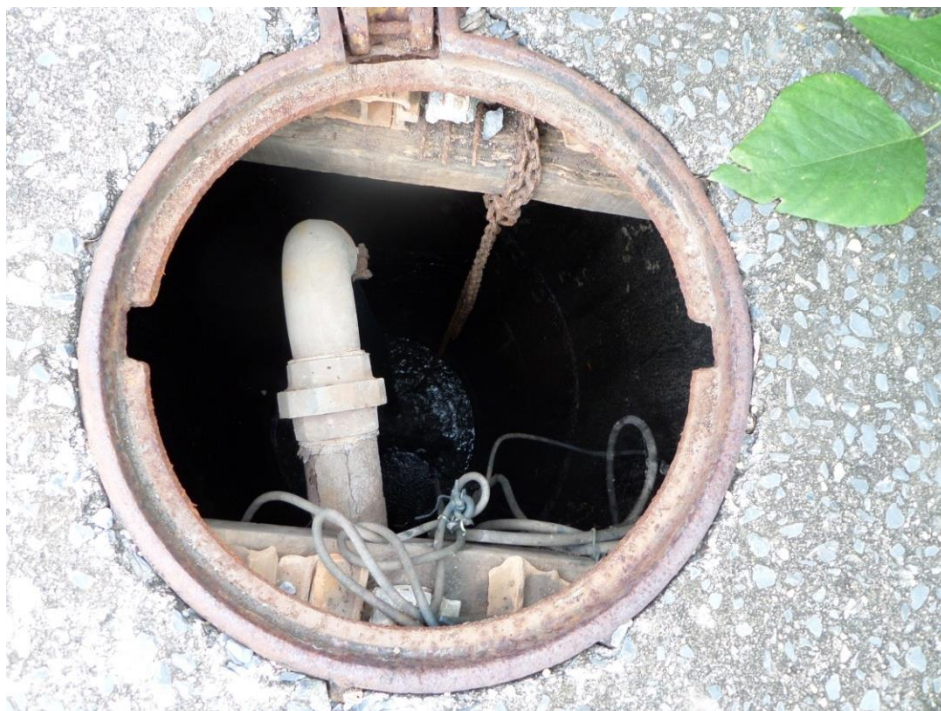
Figura 7.89 – Estação Elevatória de Esgoto (EES 1)
