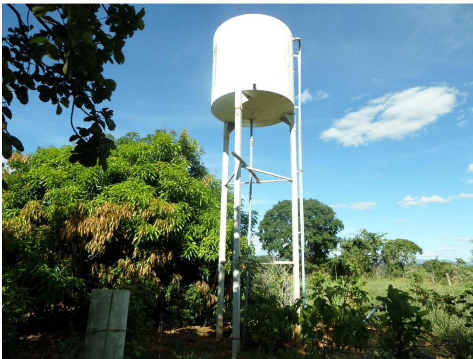
Figura 7.75 – Reservatório Chuvinha (10m 3 )
