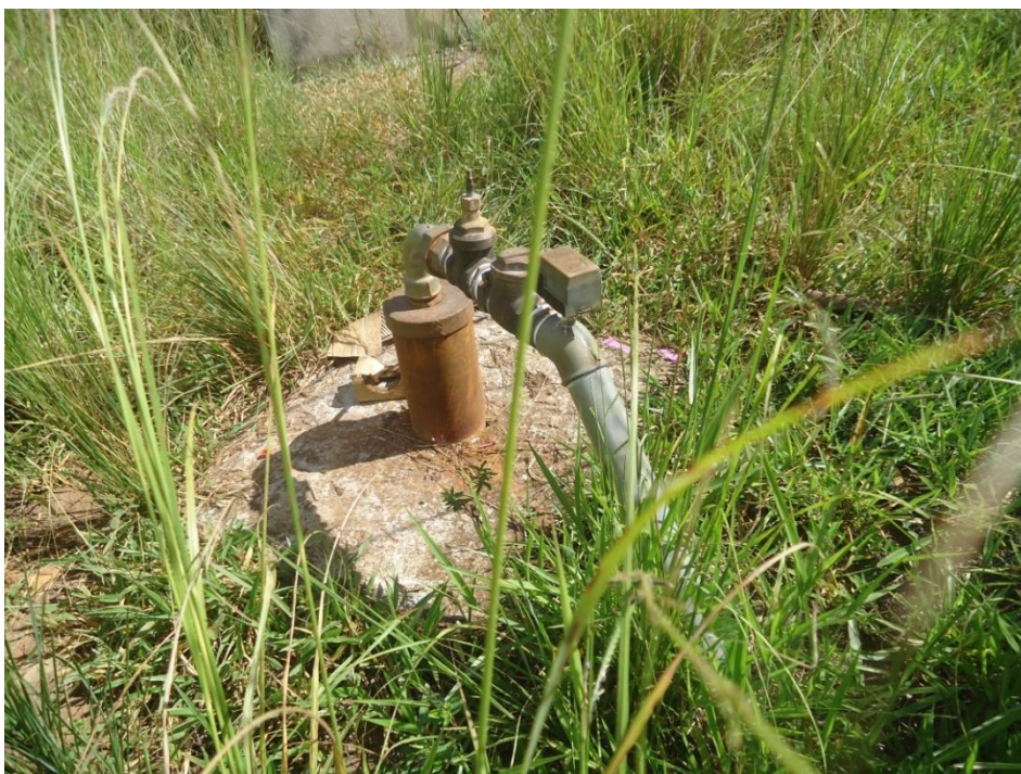
Figura 7.71 - Captação subterrânea: Tibuna
