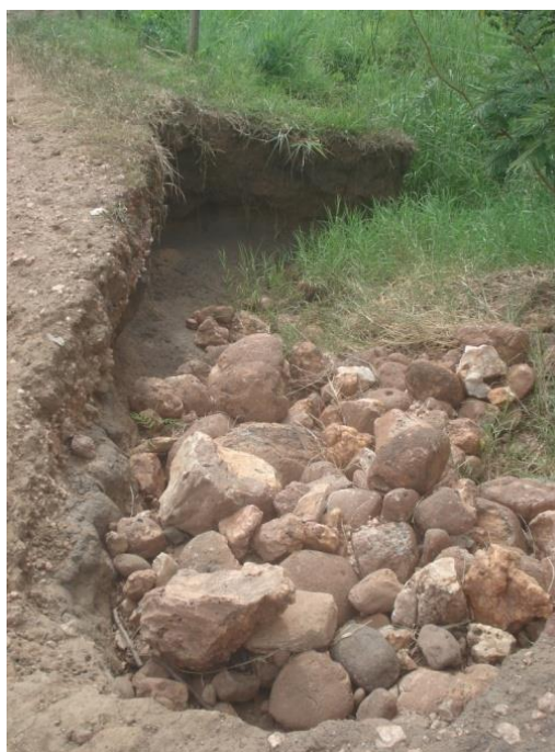
Detalhe da margem da via danificada
