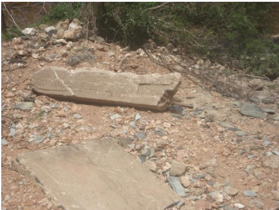
Detalhe do muro-ala danificado
