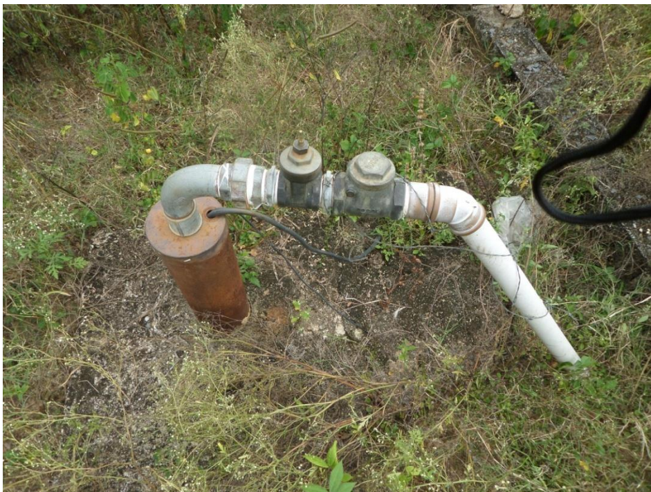
Figura 7.44 – Poço artesiano (P2) para abastecimento da sede municipal
