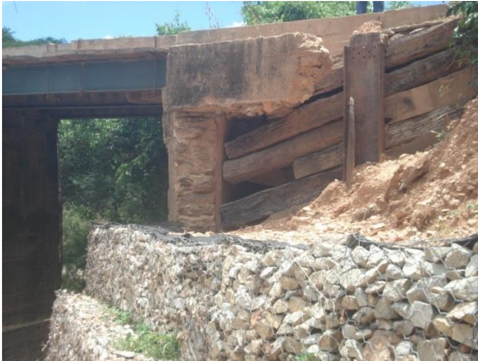
Detalhe do muro-ala danificado
