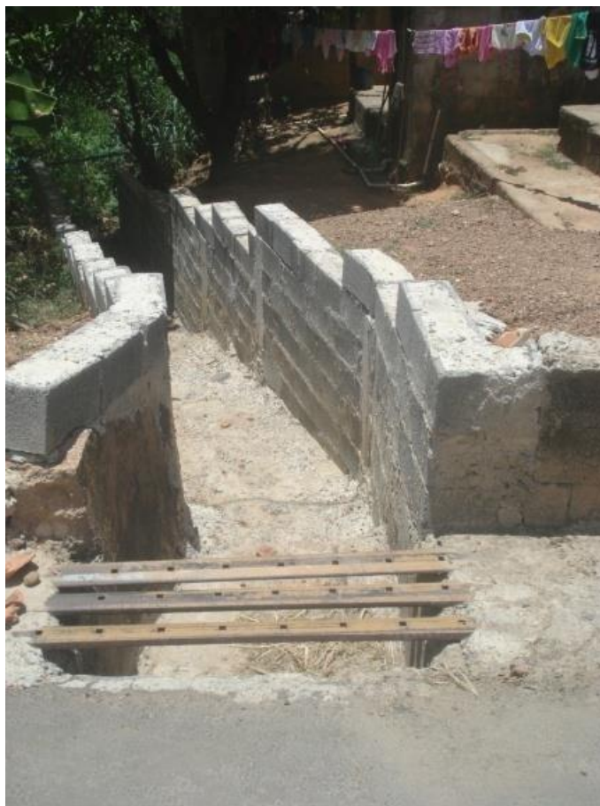
Figura 7.148-Escada hidráulica – Rua das Traíras
