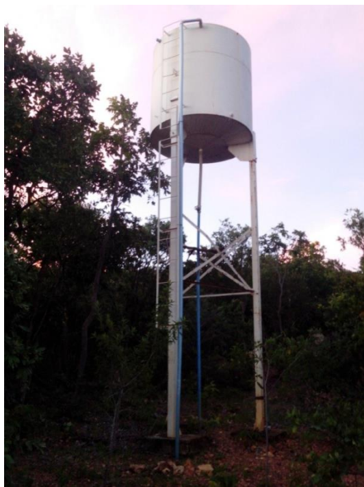
Figura 7.82 -- Reservatório Mato Seco (15m 3 )
