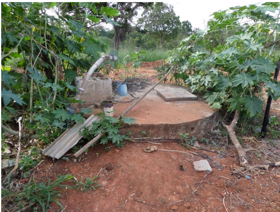
Figura 7.90 – Estação Elevatória de Esgoto (EES 2)
