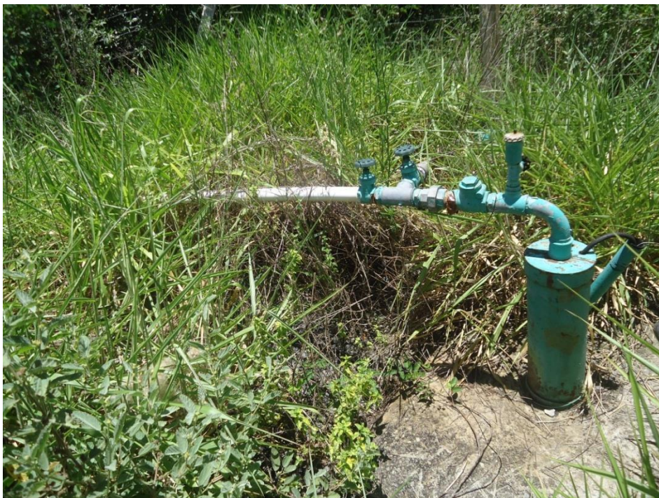
Figura 7.69- Captação subterrânea: Santa Bárbara
