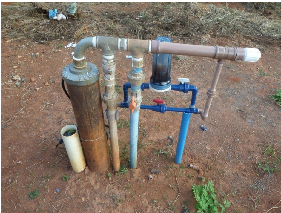
Figura 7.50 – Poço artesiano (P8) para abastecimento da sede municipal
