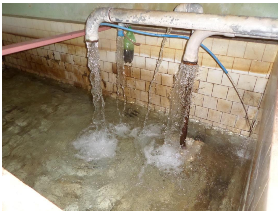
Figura 7.52 – Cloração de água no município de Santana de Pirapama
