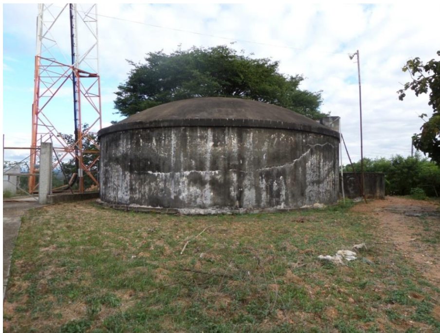
Figura 7.53 – Reservatório (R1) de 250m 3
