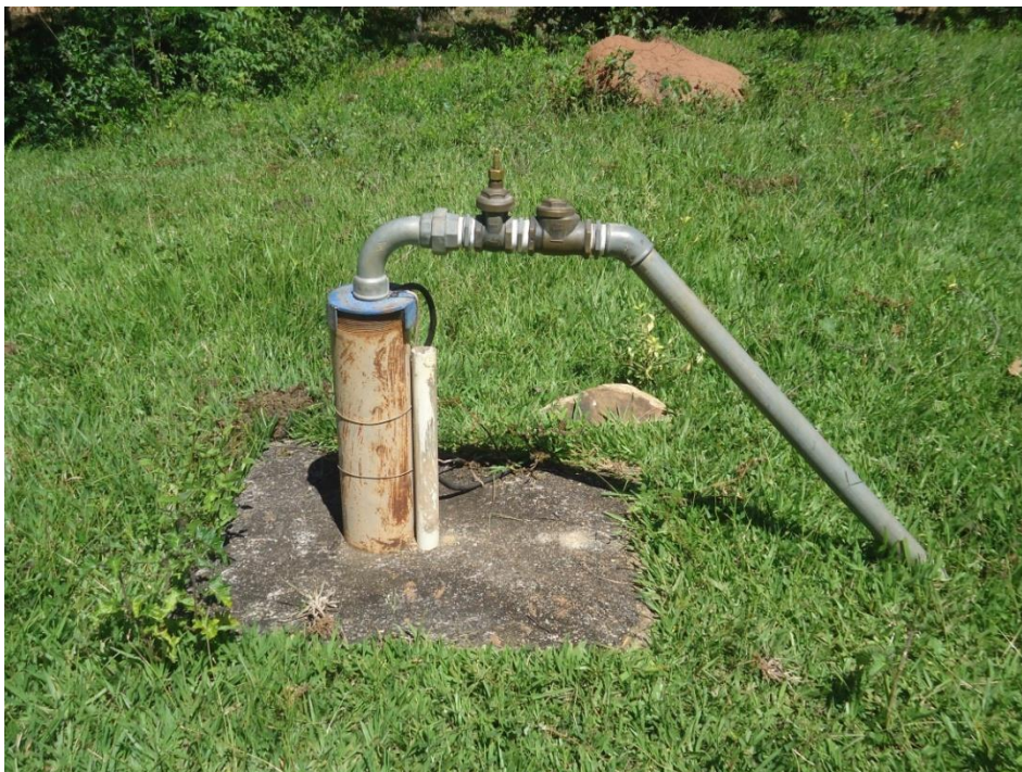
Figura 7.63 - Captação subterrânea: Coberto Pequeno
