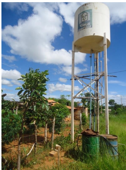
Figura 7.73 – Reservatório Cana Brava (15m 3 )
