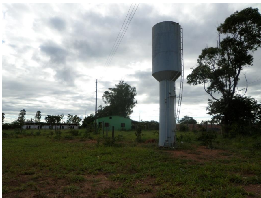
Figura 7.54 – Reservatório (R2) de 15m 3
