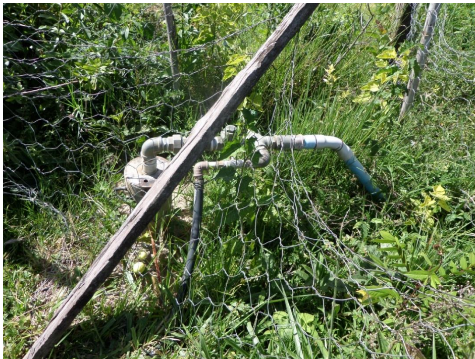
Figura 7.59- Captação subterrânea: Campo Alegre
