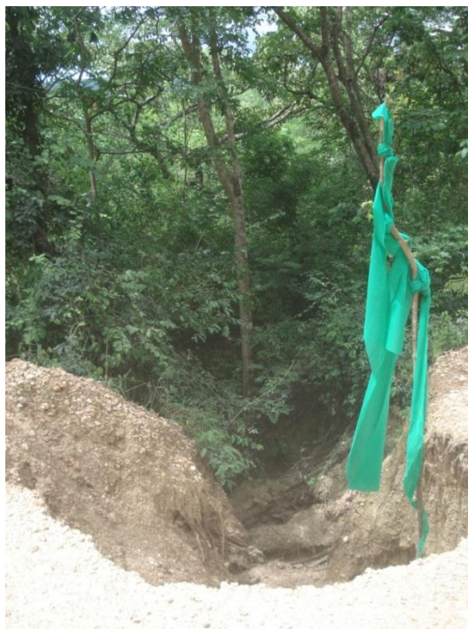
Margem da estrada danificada
