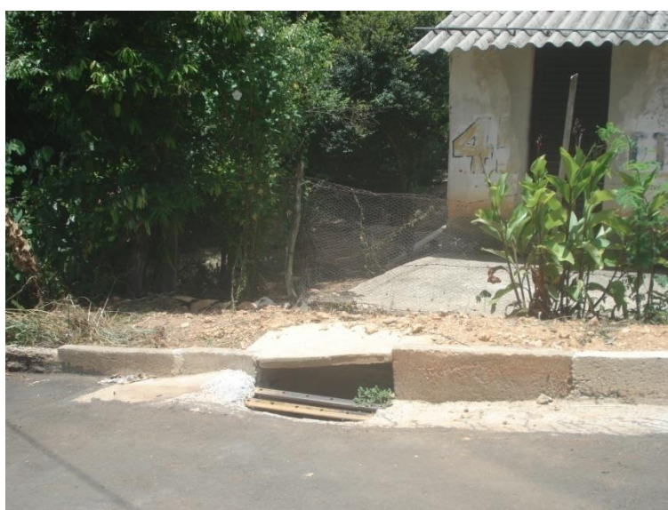
Boca -de- lobo instalada no lado direito da rua
