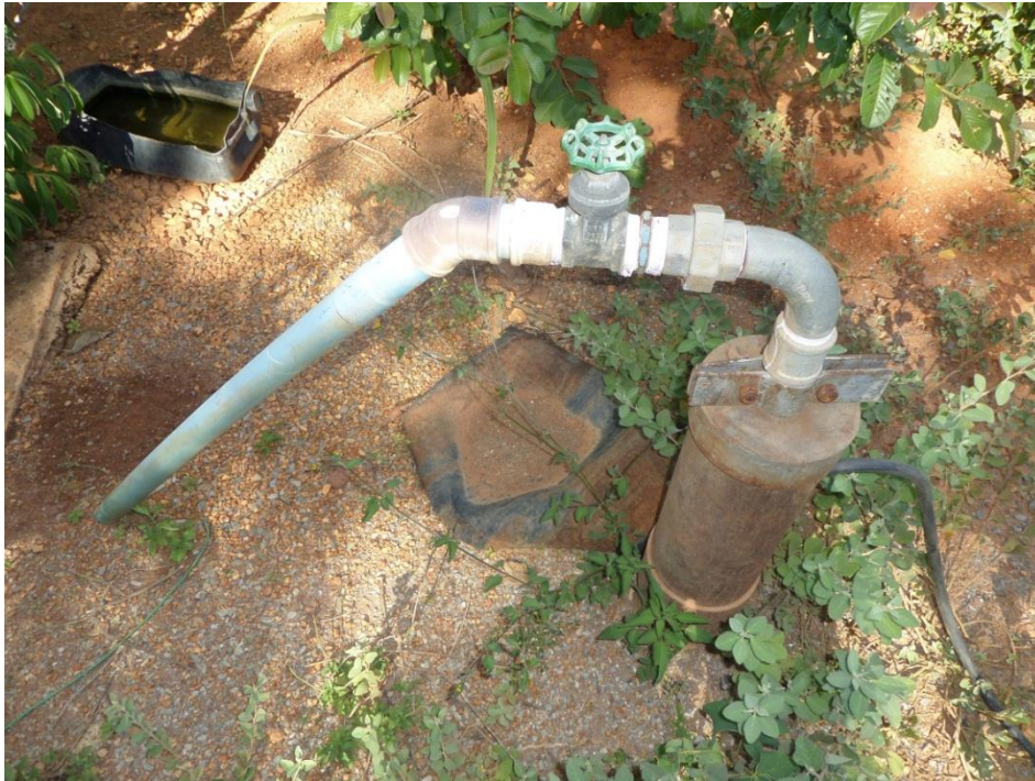
Figura 7.62 - Captação subterrânea: Chuvinha
