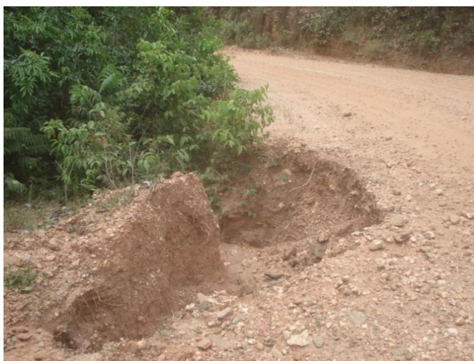
Margem da estrada danificada devido às enxurradas
