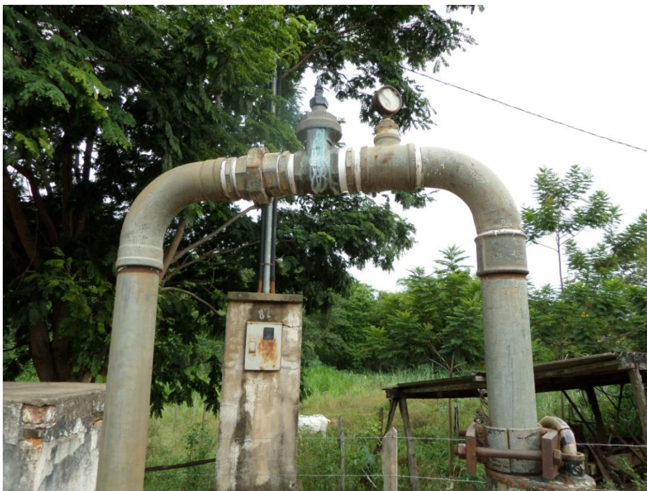
Figura 7.45 – Poço artesiano (P3) para abastecimento da sede municipal
