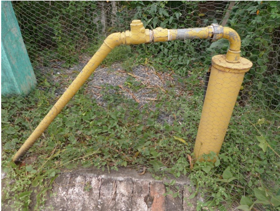
Figura 7.43 – Poço artesiano (P1) para abastecimento da sede municipal
