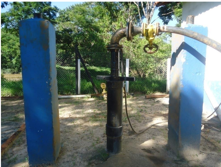
Figura 7-43 – Poço artesiano (P1) do sistema de abastecimento da COPASA
