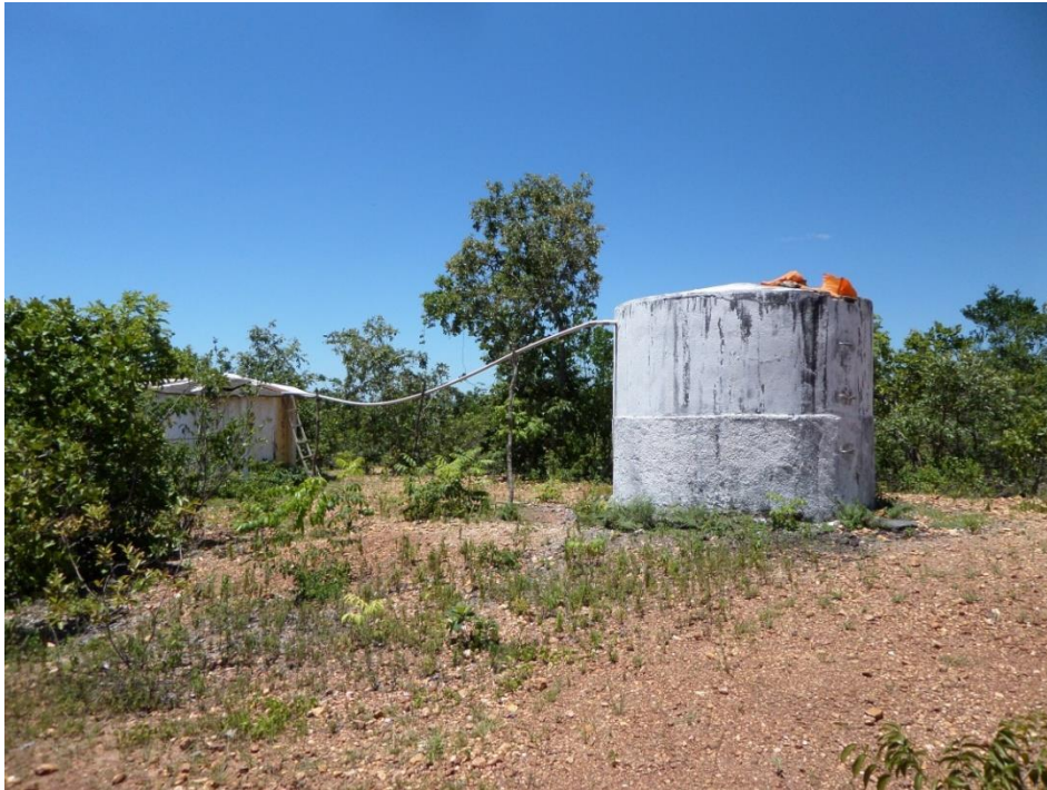
Figura 7-75 – Reservatório Capão (R1)
