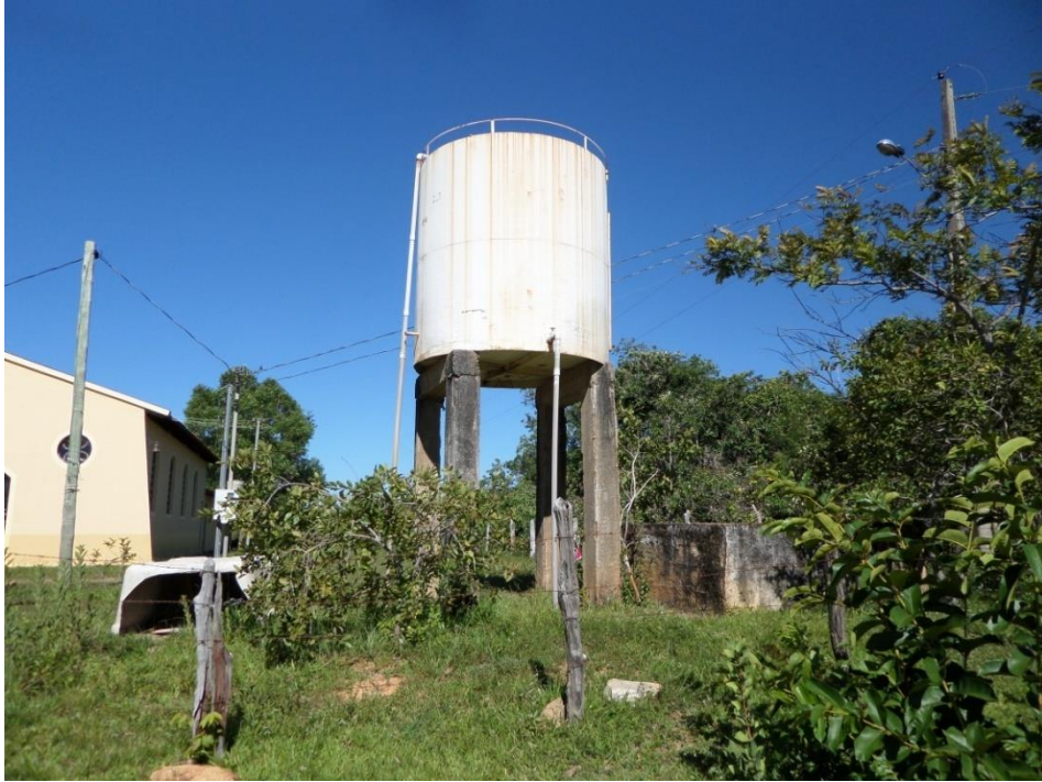
Figura 7-85 – Reservatório Serra do Gonçalves (R2)
