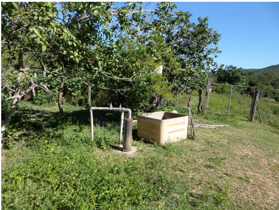
Figura 7-66 - Captação subterrânea: Serra do Gonçalves (P2)
