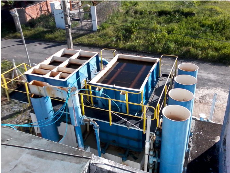
Figura 7-47 – Tratamento de água na sede municipal de Presidente Juscelino
