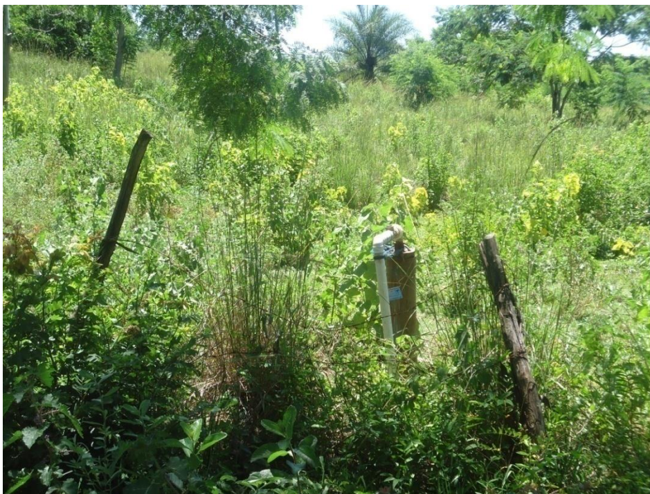
Figura 7-69 - Captação subterrânea: Vila São Joaquim (P1)
