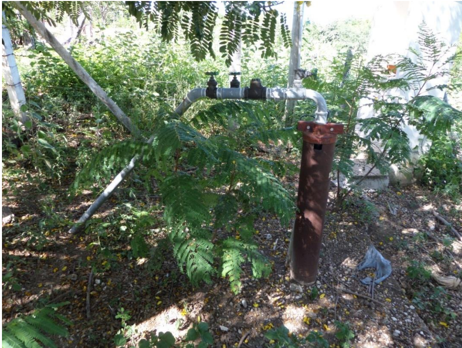
Figura 7-67 - Captação subterrânea: Torda
