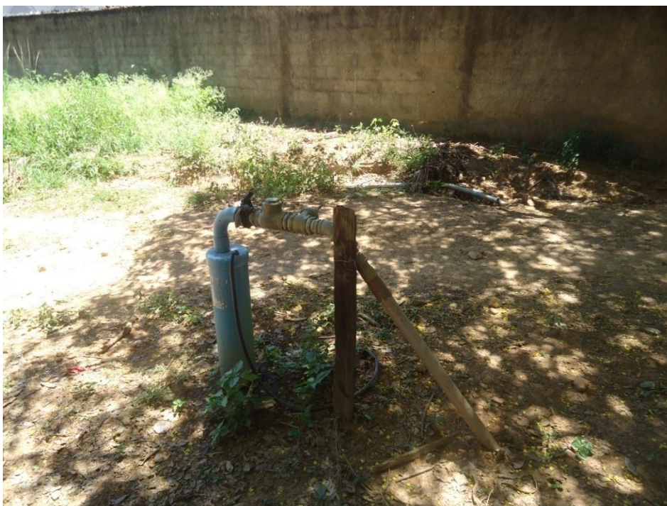
Figura 7-70 - Captação subterrânea: Vila São Joaquim (P2)
