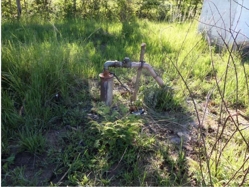
Figura 7-65 - Captação subterrânea: Serra do Gonçalves (P1)
