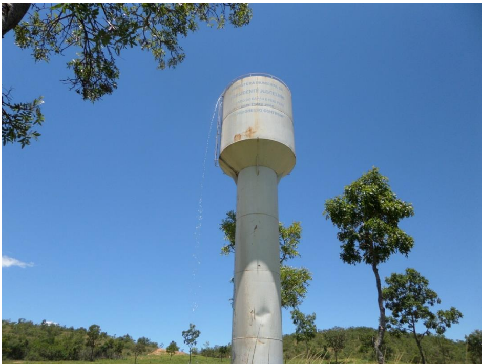
Figura 7-76 – Reservatório Capão (R2)
