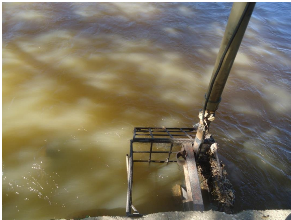
Figura 7-45 – Captação superficial no rio Paraúna: DESATIVADA
