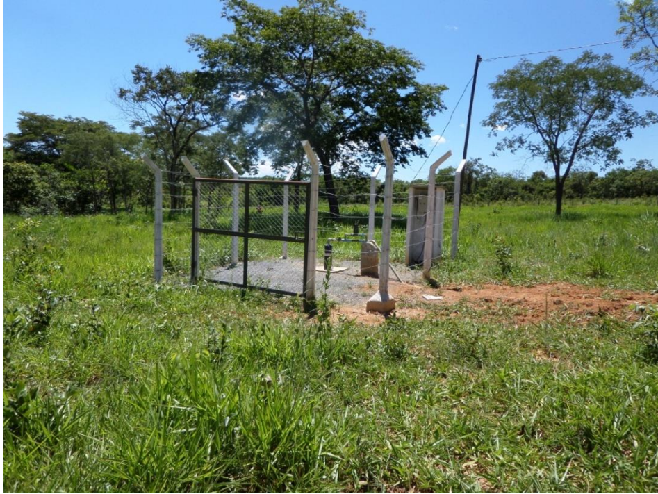
Figura 7-53- Captação subterrânea: Brejinho/Fazenda do Jatobá
