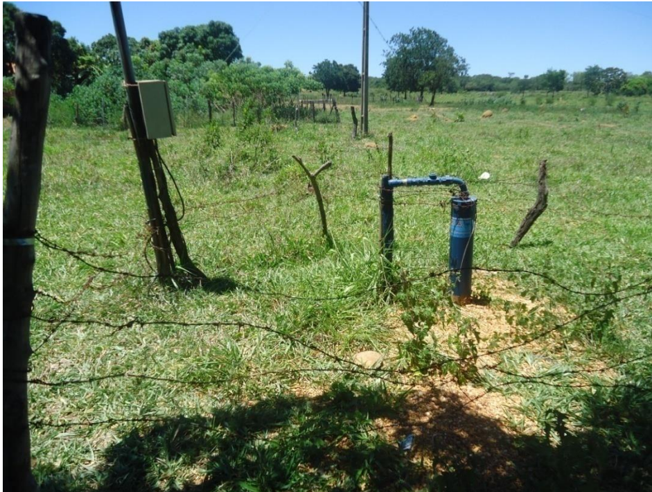
Figura 7-71- Captação subterrânea: Vila São Joaquim (P3)
