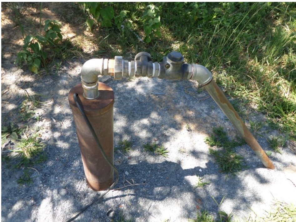
Figura 7-54 - Captação subterrânea: Brejo
