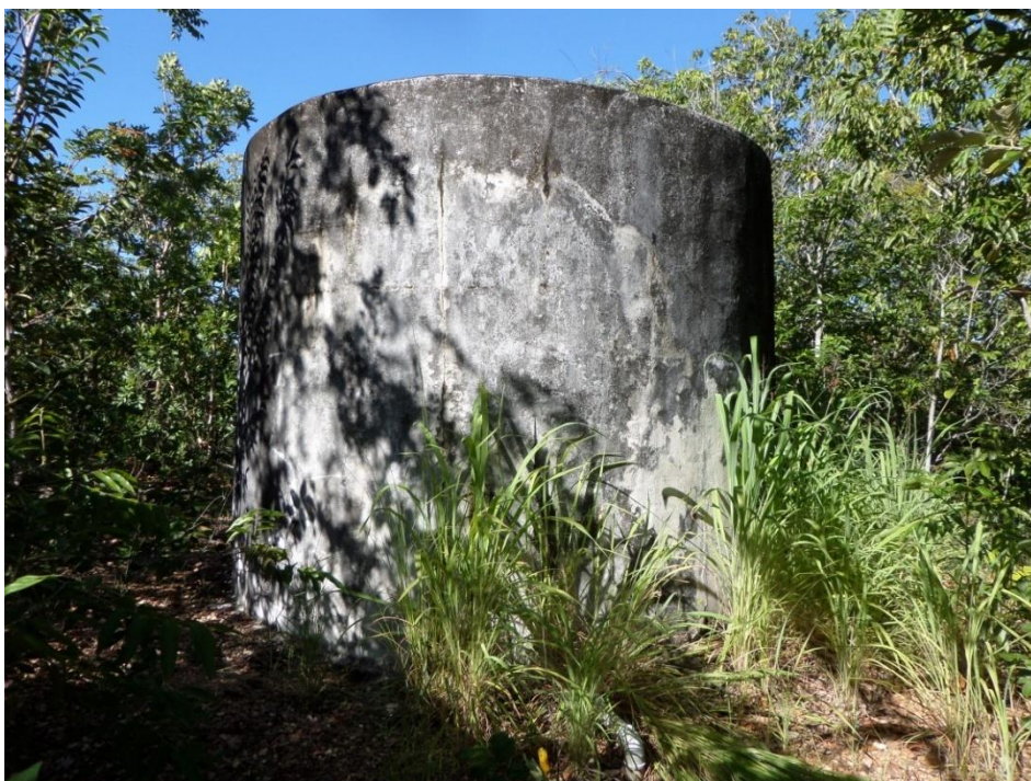
Figura 7-84 – Reservatório Serra do Gonçalves (R1)
