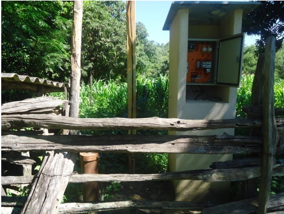
Figura 7-59 - Captação subterrânea: Lajeado
