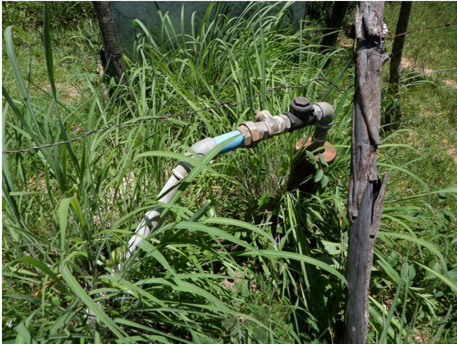
Figura 7-63- Captação subterrânea: Peri Peri
