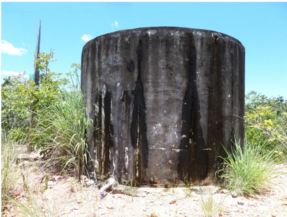
Figura 7-82 — Reservatório Peri Peri
