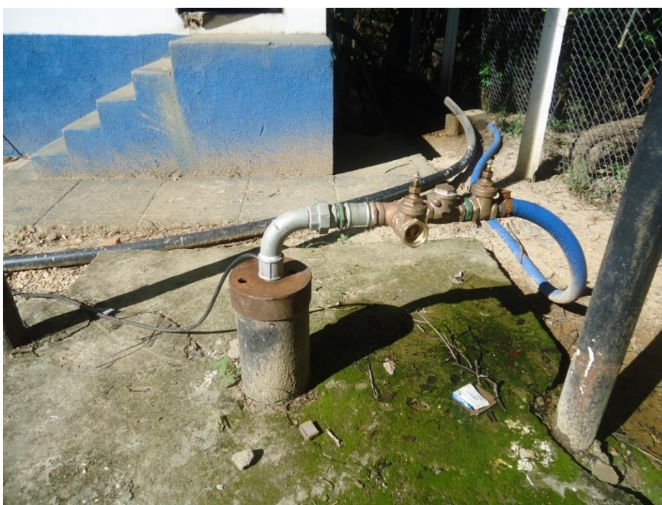
Figura 7-44 – Poço artesiano (P2) do sistema de abastecimento da COPASA
