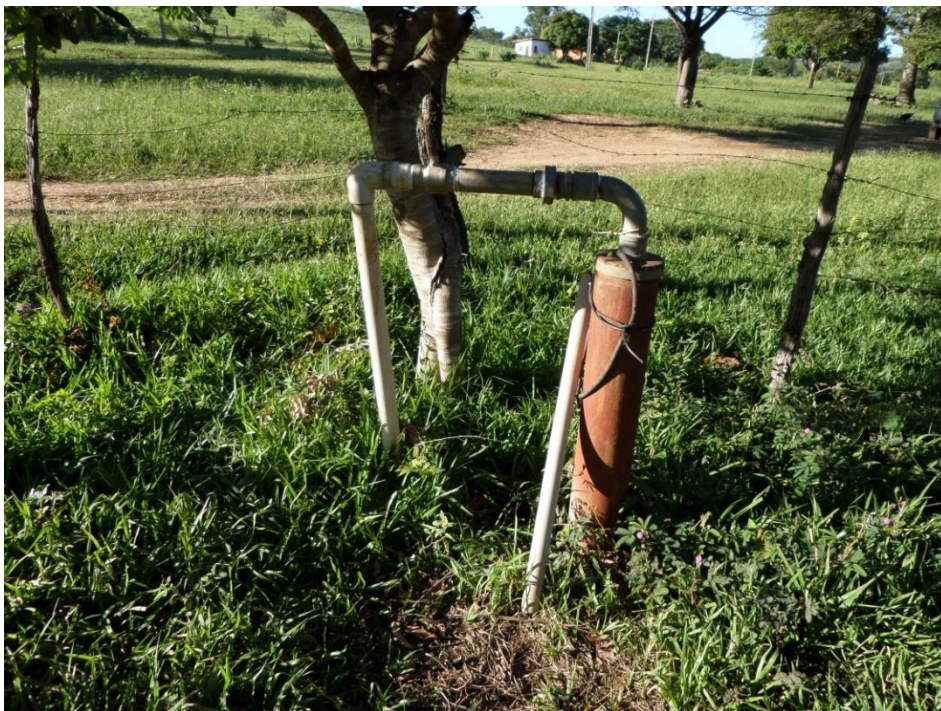
Figura 7-68 – Captação subterrânea: Varginha
