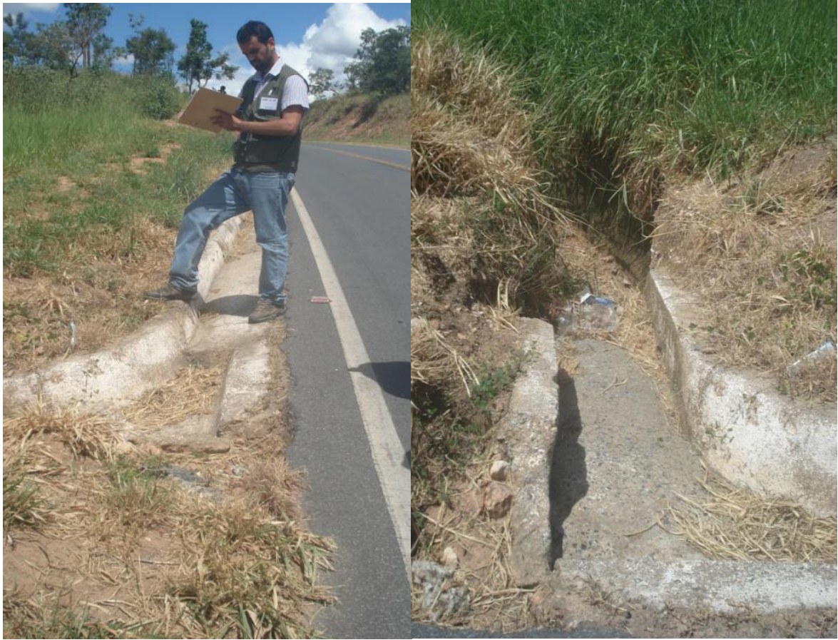
Canaleta de condução das águas pluviais localizada nas margens da Rodovia MG-323
