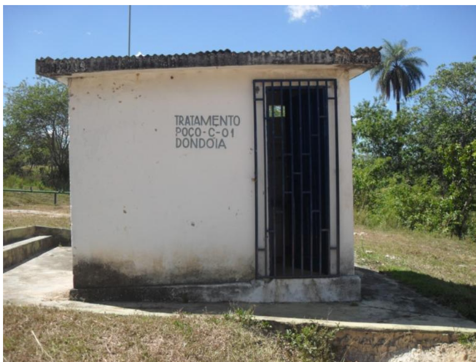
Figura 7.59 – Identificação e casa com quadro de comando do poço Dondoia (C-01) na Sede
