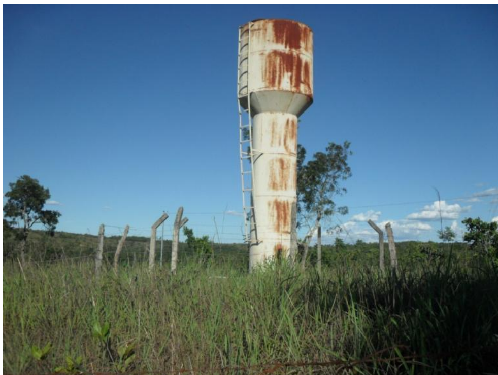
Figura 7.108– Reservatório de Timóteo
