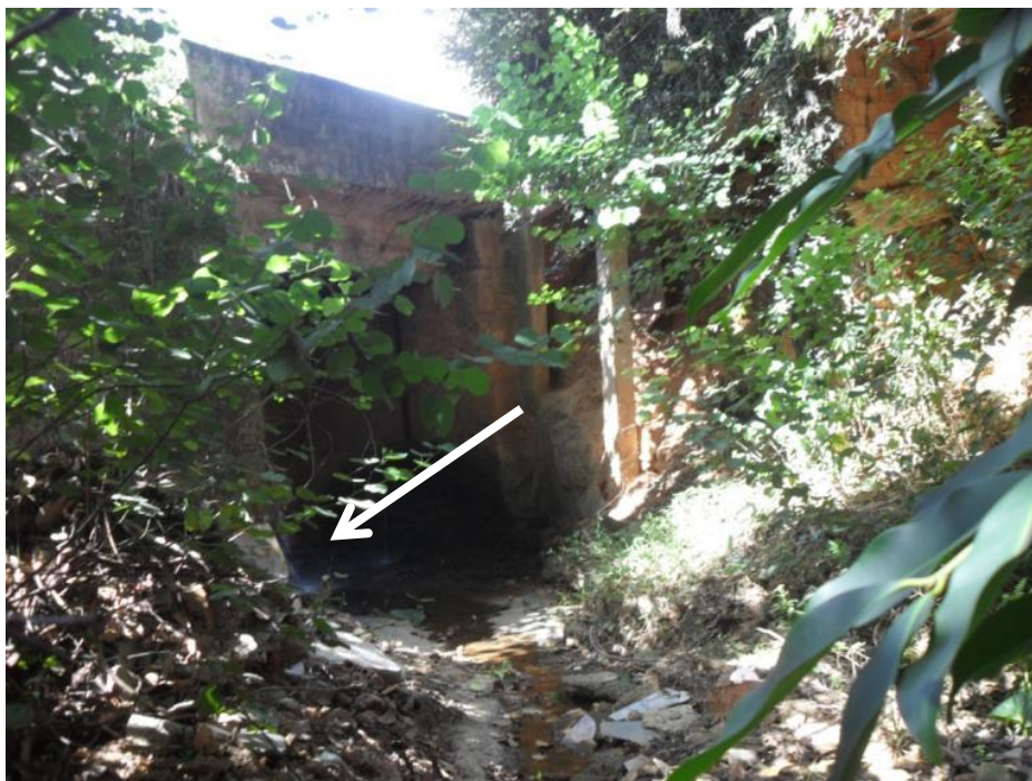
Figura 7.135– Lançamento pontual de esgoto no córrego Grande, na Sede
