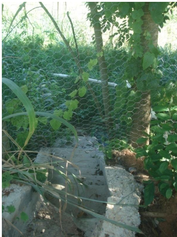
Escada Hidráulica – Lançamento das águas pluviais captadas na Rua João Luiz
