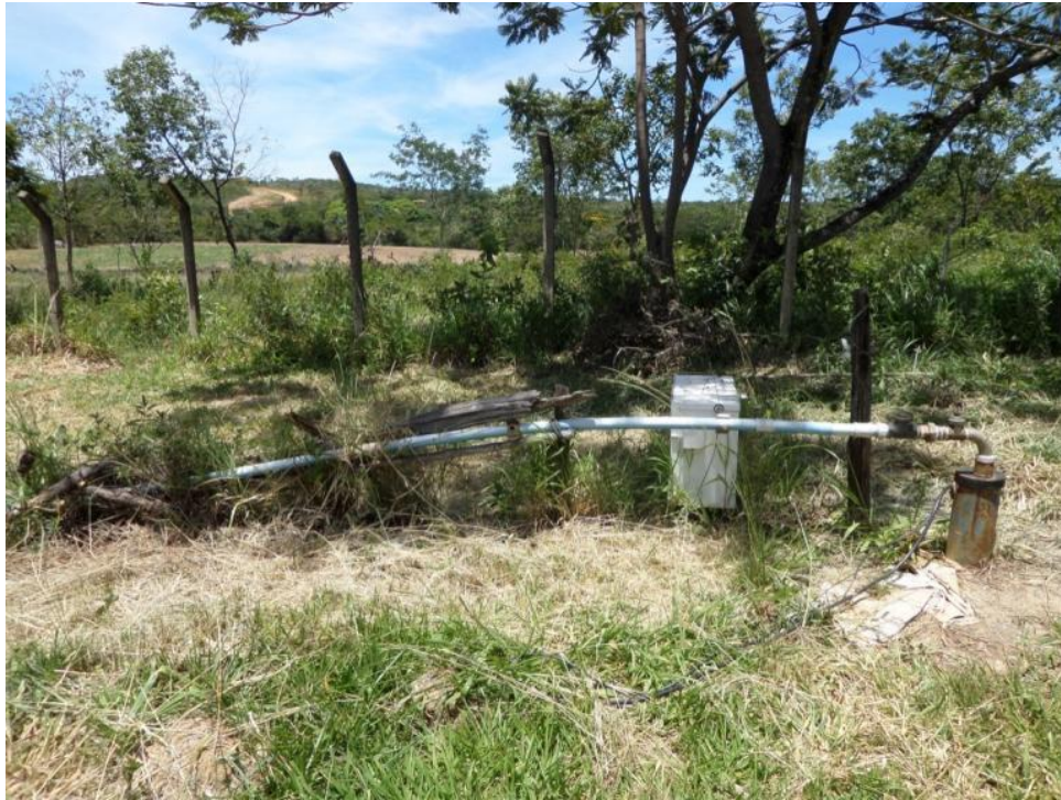
Figura 7.85 – Poço em operação de Botafogo
