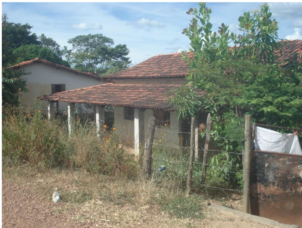
Residência atingida pelas enxurradas– Av. Perimetral
