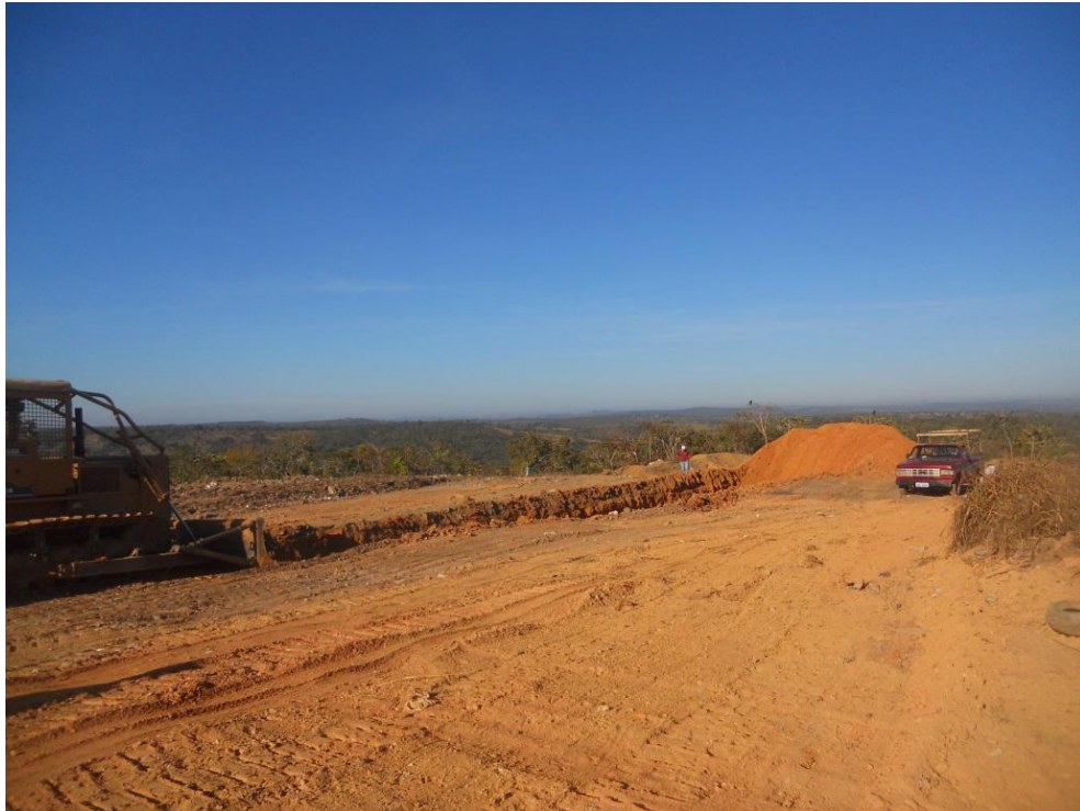
Figura 7.174 – Cobertura das valas de outubro de 2013 e abertura de novas valas em junho de 2014
