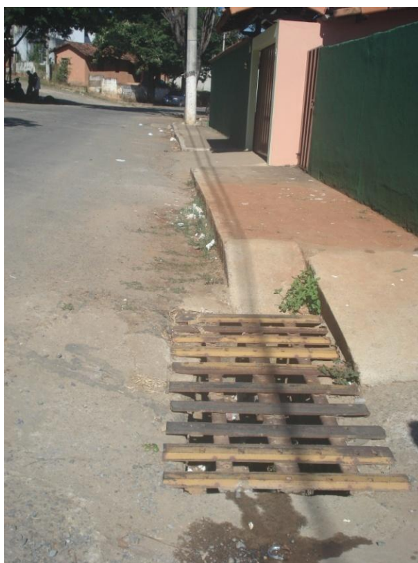
Figura 7.189 – Boca de lobo com grelha: Rua João Luiz –Sede
