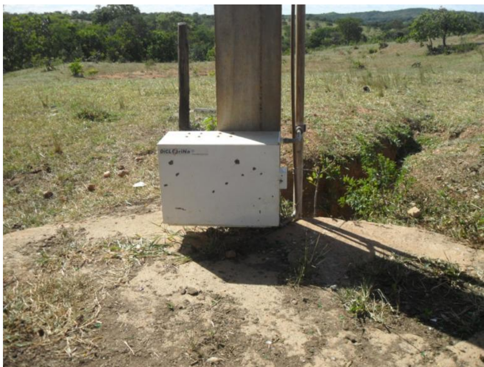
Figura 7.111 – Dosador de cloro da água do poço de Vila Amanda acoplado ao reservatório
