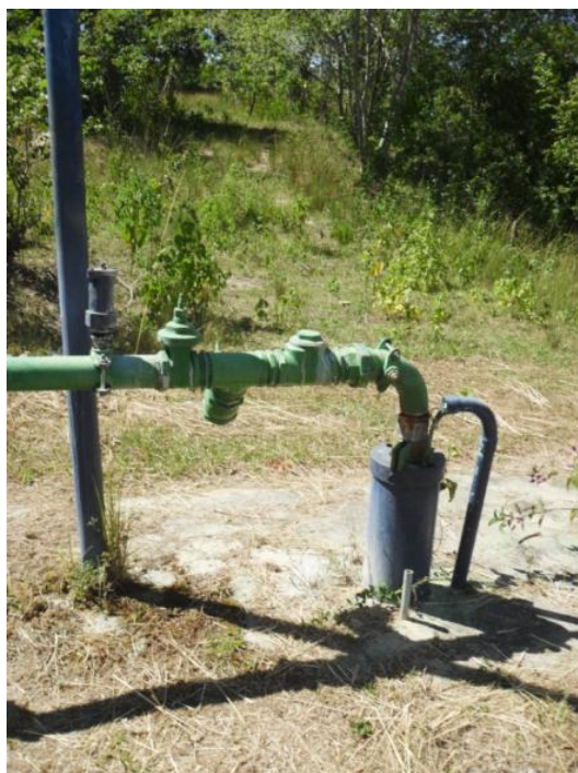
Figura 7.58 – Detalhe da captação no poço Dondoia (C-01) na Sede
