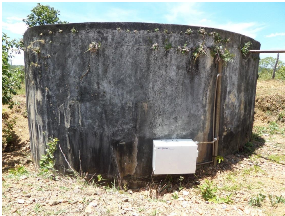
Figura 7.99 – Compartimento acoplado ao reservatório onde era realizada a cloração da água advinda do poço 1 no povoado de Mucambo
