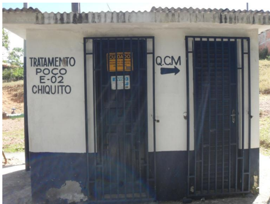
Figura 7.56– Identificação e casa com quadro de comando do poço Chiquito (E-02 Baldim) na Sede
