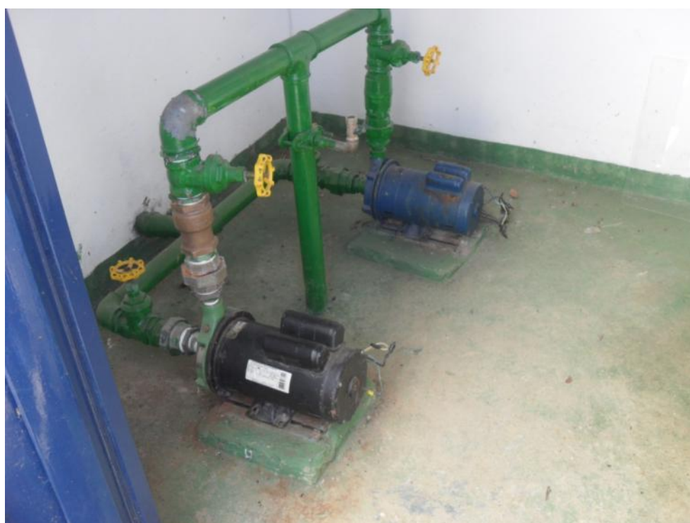
Figura 7.70 – Estação elevatória de água tratada Alto do Cruzeiro – Sistema Baldim Sede
