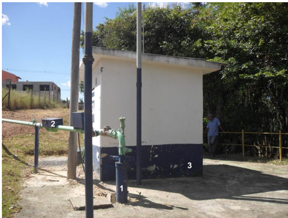
Figura 7.55– Componentes do poço Chiquito (E-02 Baldim) na Sede
