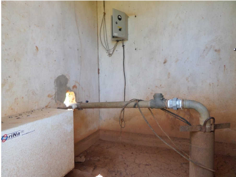
Figura 7.103 – Caixa acoplada à saída do poço de Sumidouro onde ocorria a cloração da água
