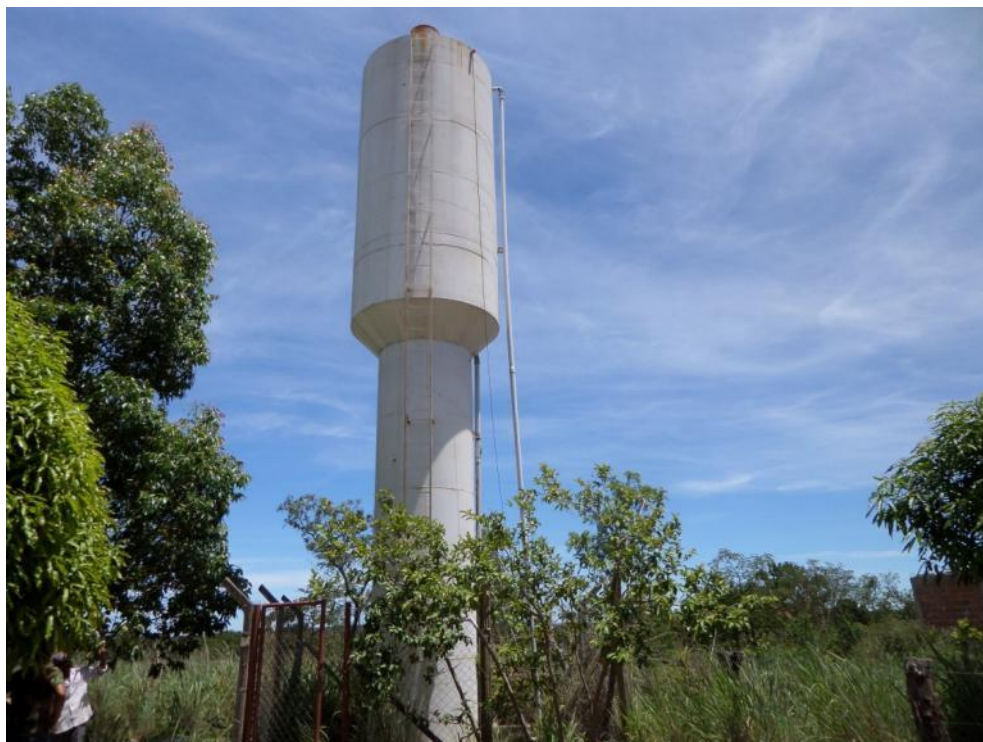
Figura 7.89 – Reservatório principal de Botafogo
