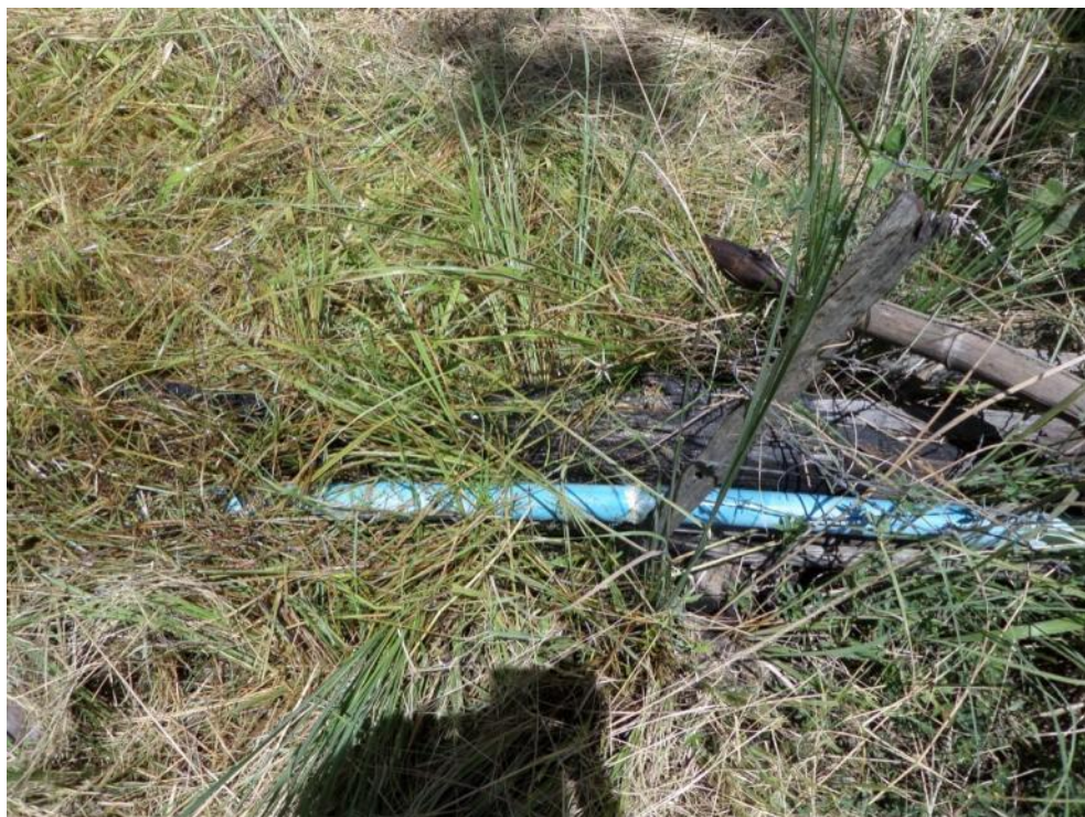
Figura 7.90– Vazamento na adutora próxima ao poço de Botafogo
