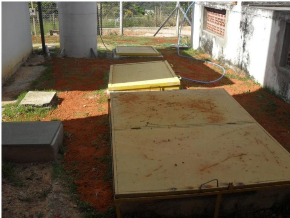
Figura 7.64 – Vista do local onde é feito o tratamento dos poços do sistema Baldim Sede
