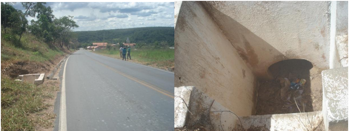
Caixa de captação das águas pluviais na Rodovia MG-323
