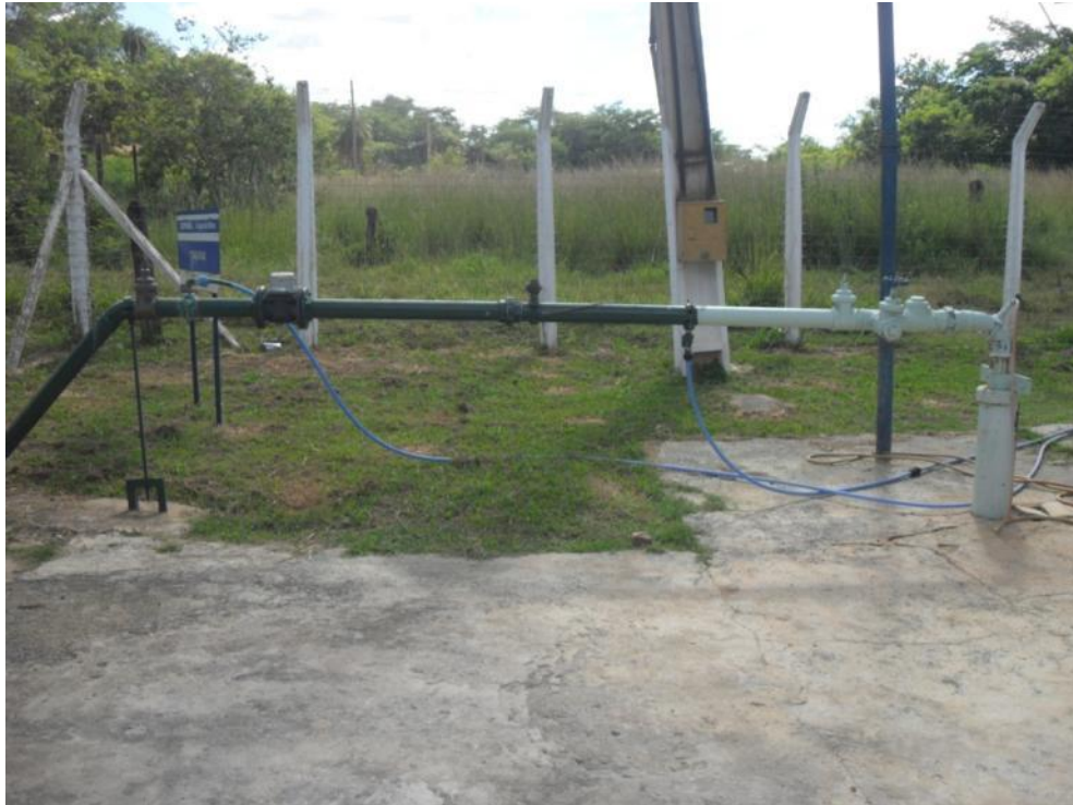
Figura 7.74– Dosagem de cloro e flúor na adutora do poço Eucalipto (E-02 São Vicente) em São Vicente
