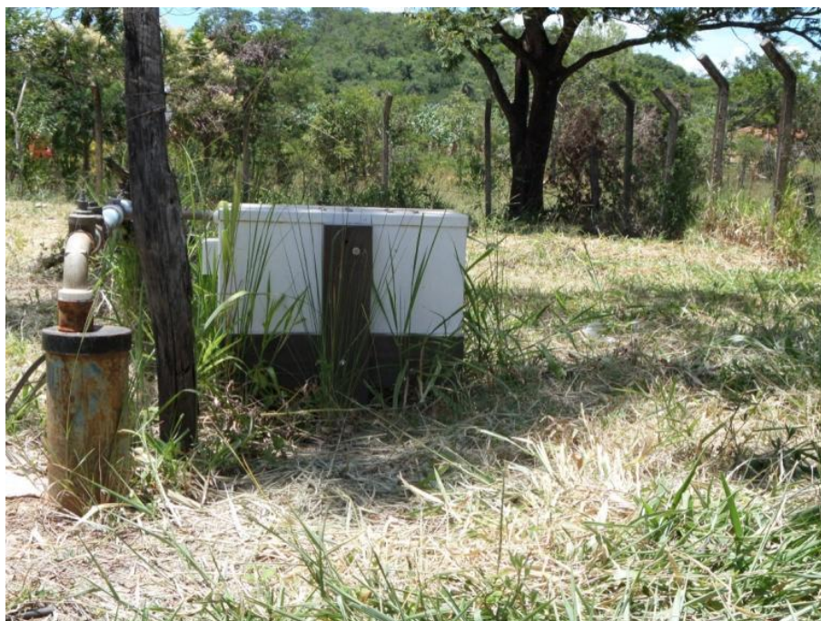
Figura 7.87– Vista posterior do poço e dosador de cloro de Botafogo
