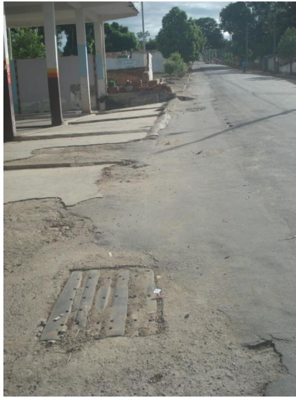
Figura 7.190 – Boca de lobo com grelha encoberta: Av. Geraldo Marques –Sede
