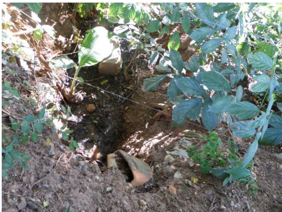
Figura 7.141– Esgoto a céu aberto, próximo ao córrego Grande, em São Vicente
