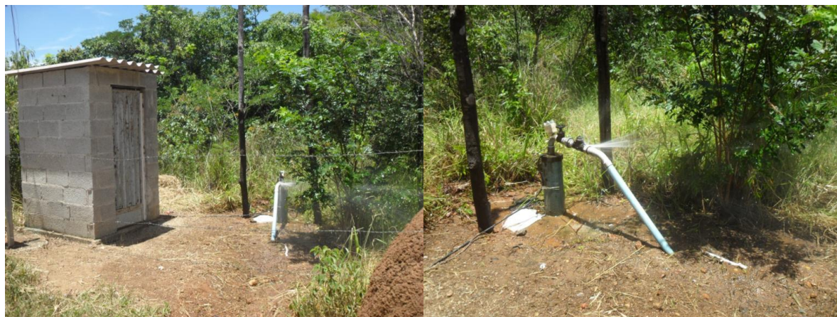
Figura 7.122– Poço artesiano de Três Passagens
