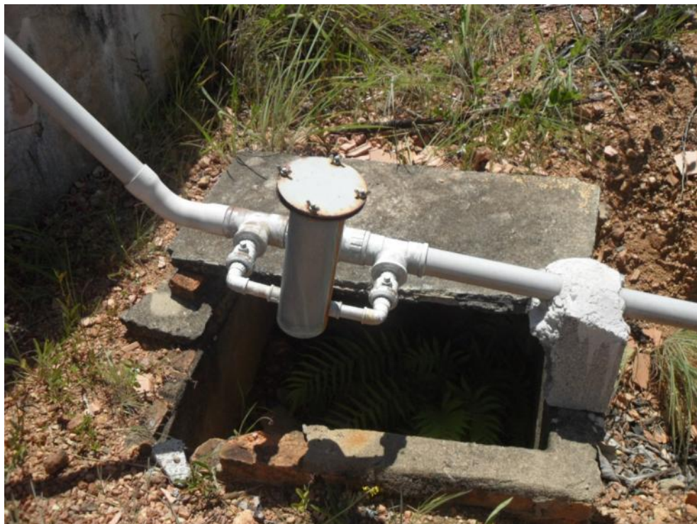
Figura 7.125 – Dosador de cloro do poço do Centro de Vargem Grande
