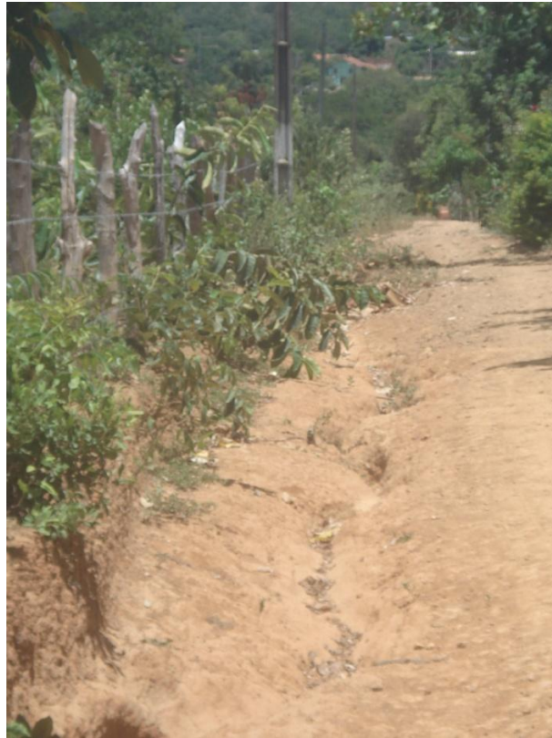
Detalhe do efeito das enxurradas na Estrada Mato Grande
