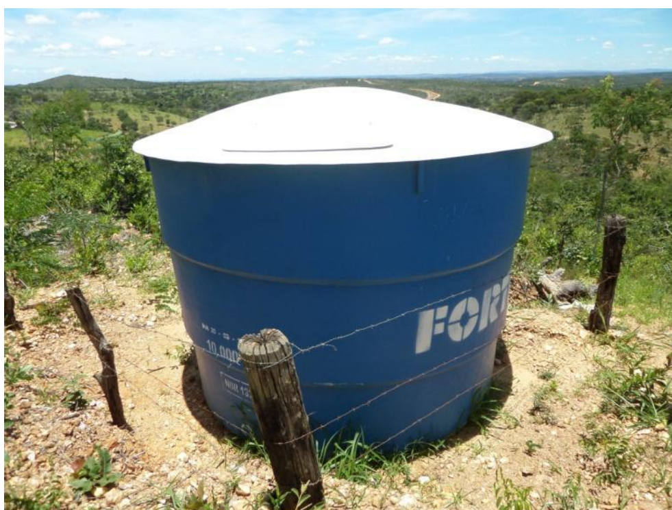
Figura 7.88 – Reservatório da parte alta de Botafogo – bairro Água Boa
