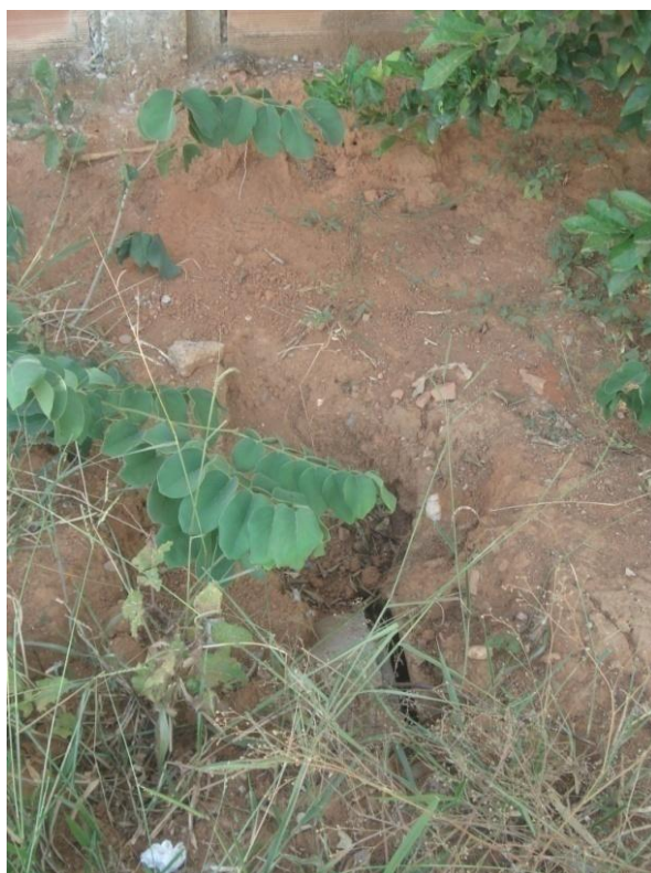
Detalhe de manilha danificada na Rua José de Carvalho
