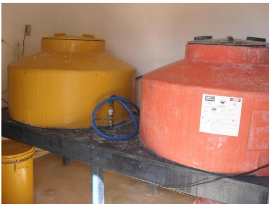
Figura 7.62 – Armazenamento de cloro e flúor no interior da casa de química do sistema Baldim Sede
