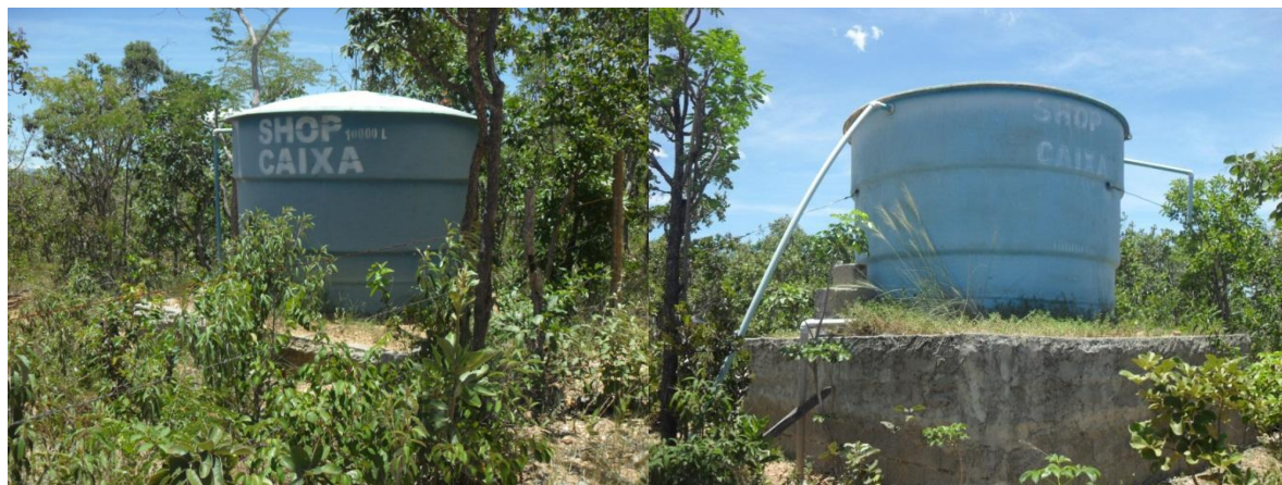
Figura 7.127 – Reservatórios de Três Passagens
