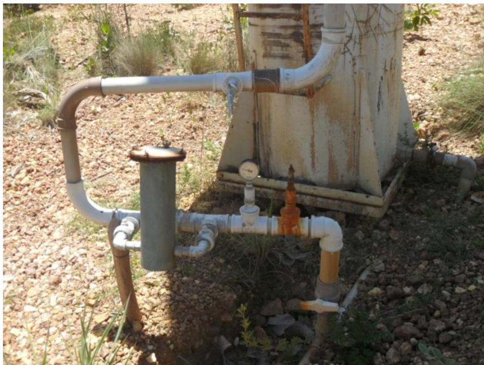
Figura 7.126 – Dosagem de cloro do poço da Penha
