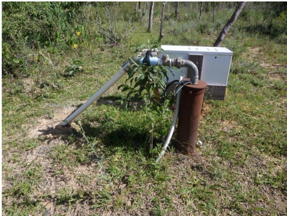
Figura 7.94 – Captação no poço de Manteiga
