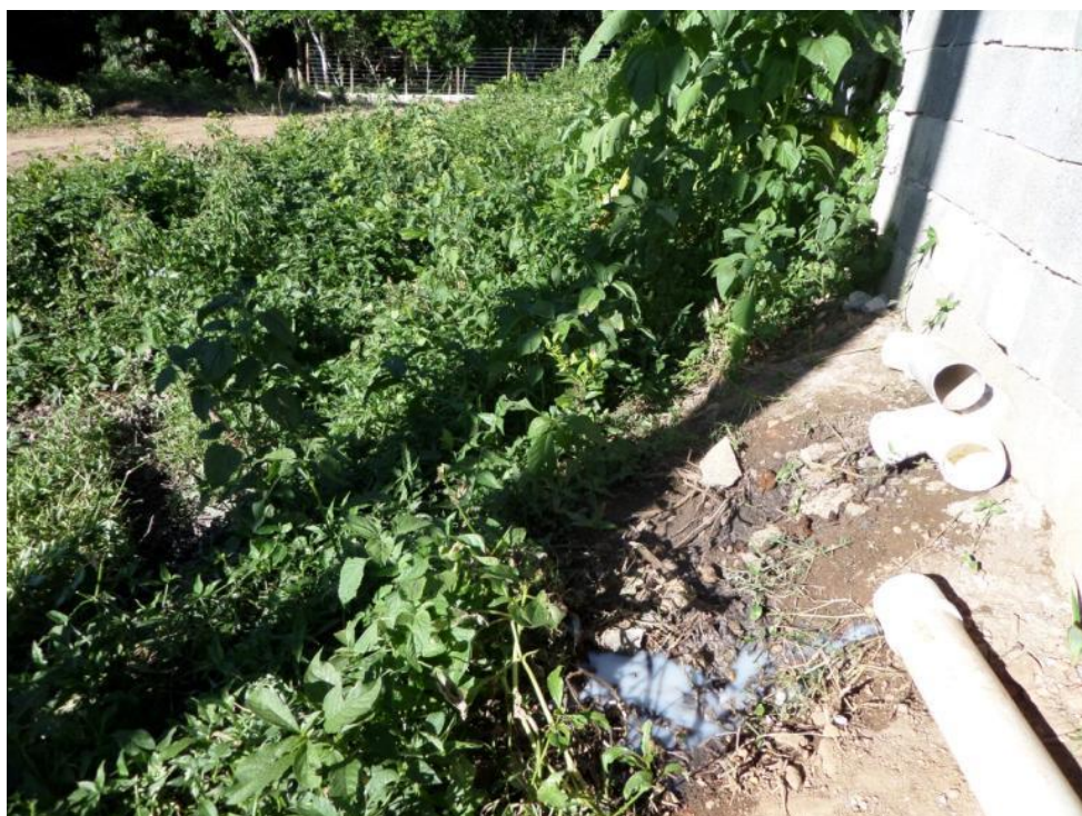
Figura 7.144– Lançamento do esgoto da rede em implantação de um morador em São Vicente
