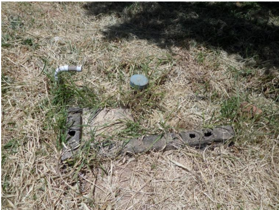
Figura 7.86– Poço desativado de Botafogo
