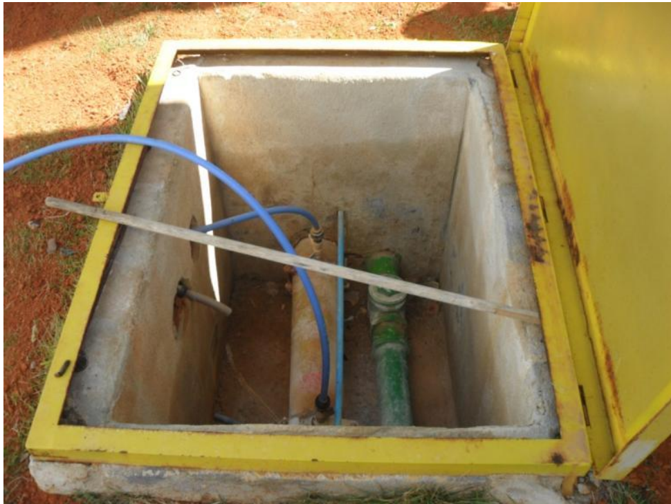
Figura 7.63 – Aplicação de cloro e flúor na adutora conjunta dos poços do sistema Baldim Sede
