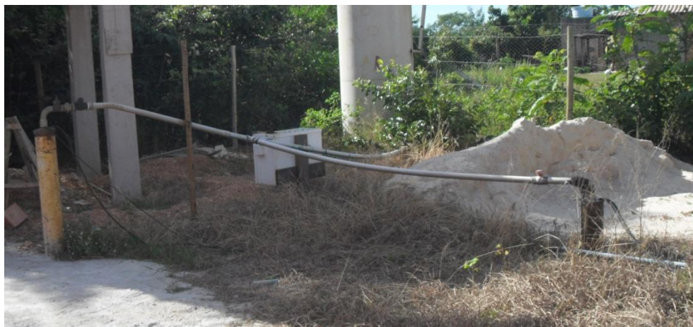
Figura 7.117 – Dosador de cloro dos poços de Alto da Cuia
