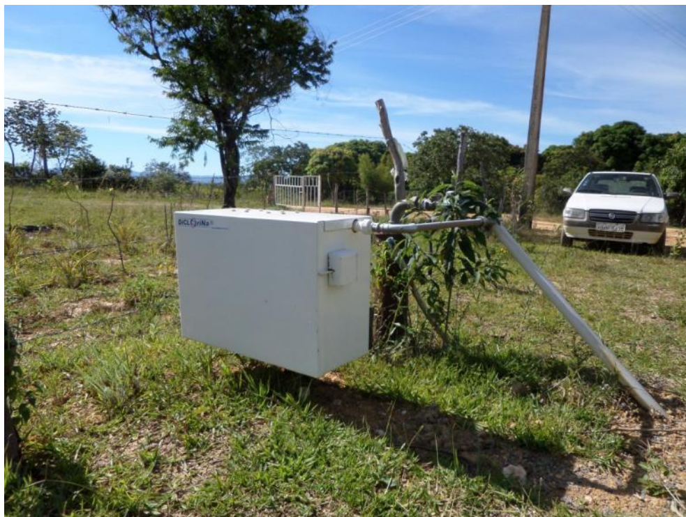
Figura 7.95– Dosagem de cloro na água do poço Manteiga
