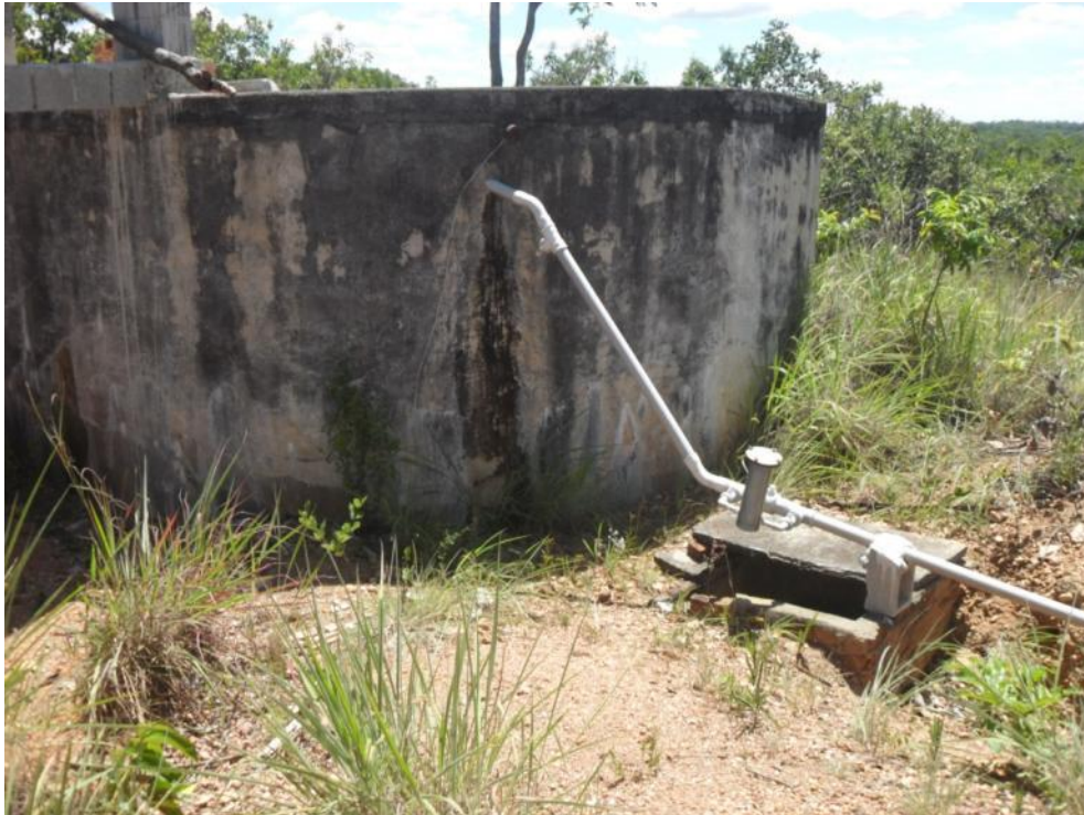
Figura 7.128 – Reservatório do Centro de Vargem Grande
