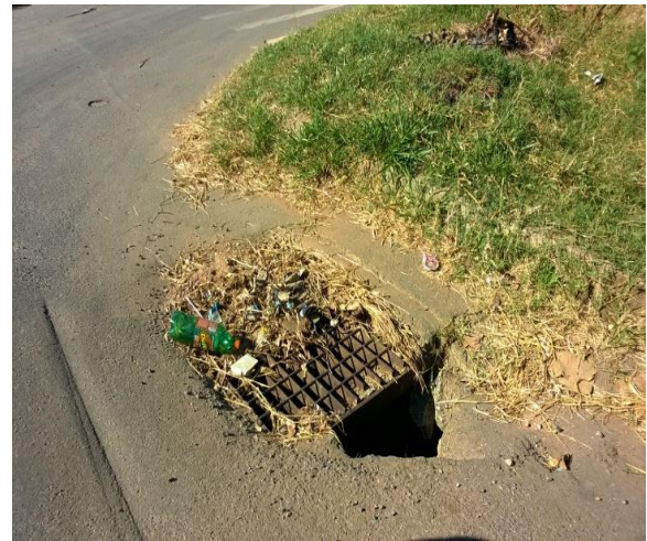
Figura 152: Boca de lobo com acúmulo de lixo
