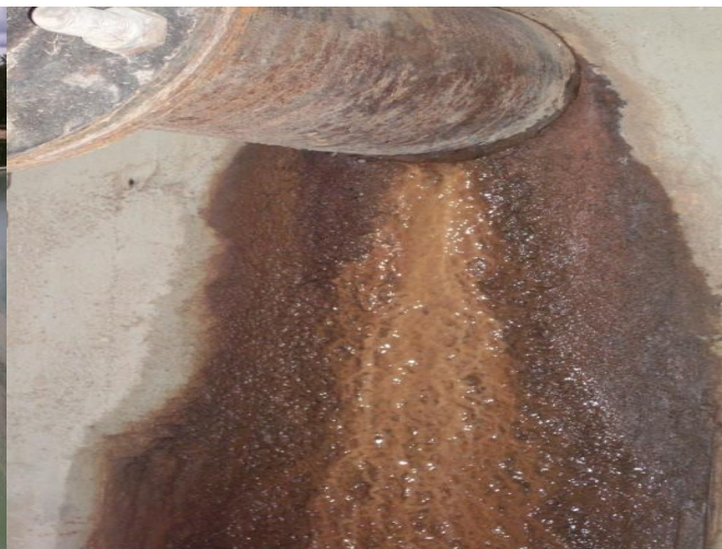
Figura 108: Vazamento identificado pela ARSAE
