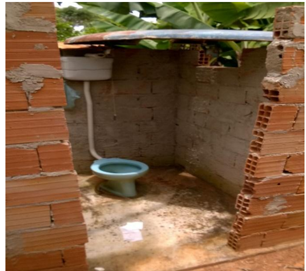
Figura 102: Fossa rudimentar - Comunidade Periquito Fonte: Prefeitura Municipal de Cordisburgo, 2014
