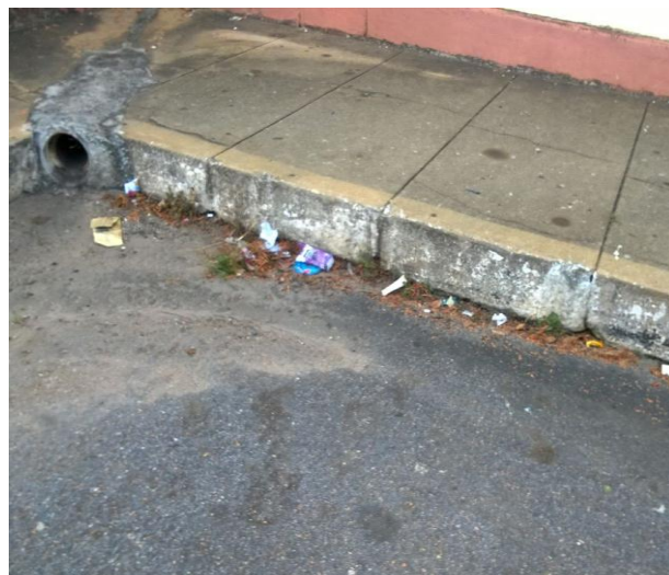
Figura 128: Resíduos dispostos na rua
