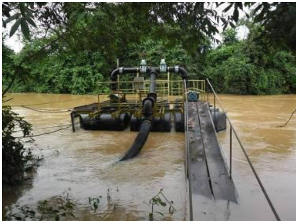
Figura 127: Captação do Rio Bicudo Fonte: Gesois, 2014
