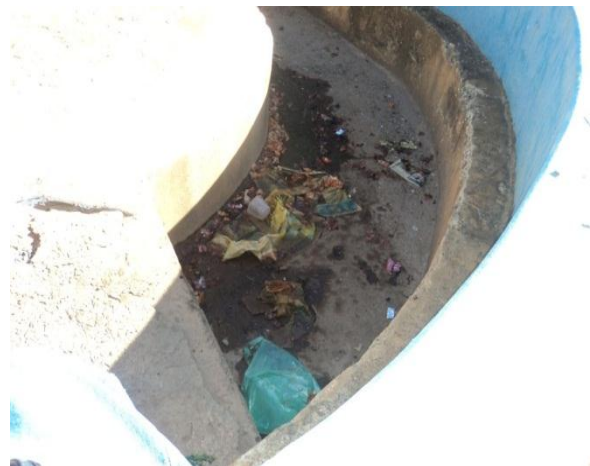
Figura 235: Canal de Drenagem Fonte: Gesois, 2014
