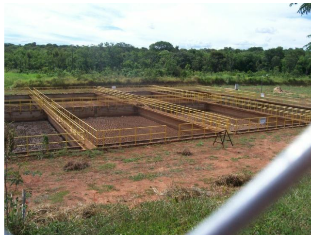
Figura 160: Leitos de secagem Fonte: Gesois, 2014
