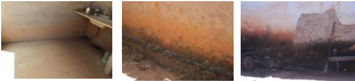
Figura 251: Aspecto do interior de residência de moradora após inundação Fonte: Gesois, 2014
