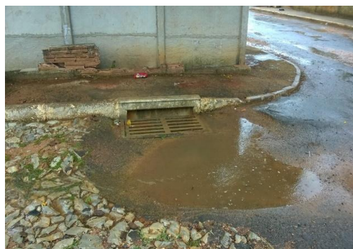
Figura 126: Falta de manutenção Fonte: Prefeitura Municipal de Araçáí, 2014
