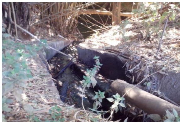
Figura 82: Lançamento de esgotos in natura no Córrego do Candoca
