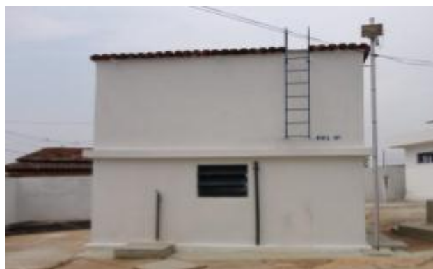
Figura 66: Reservatório do SAA Fonte: Prefeitura Municipal de Araçai, 2014
