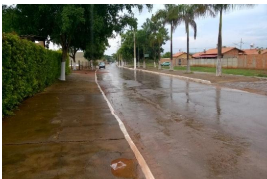
Figura 125: Rua sem sistema de drenagem Fonte: Prefeitura Municipal de Araçáí, 2014
