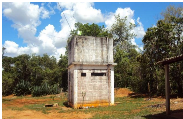
Figura 69: Reservatório de água - Carvalho de Almeida Fonte: Prefeitura Municipal de Araçáí, 2014
