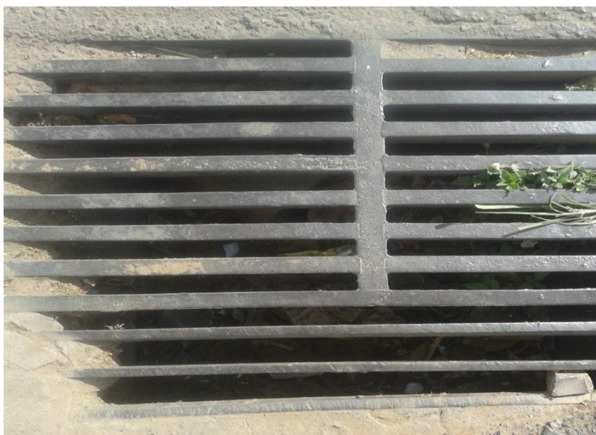
Figura 7: Boca de lobo no centro de Cordisburgo
